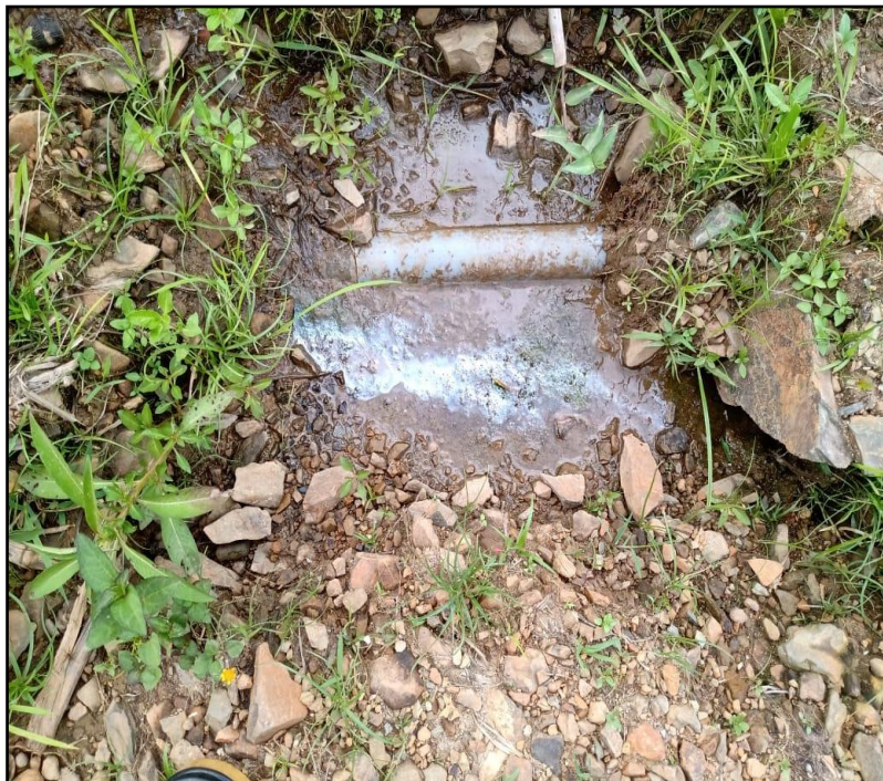
Figura 31: Tubería expuesta línea de aducción
