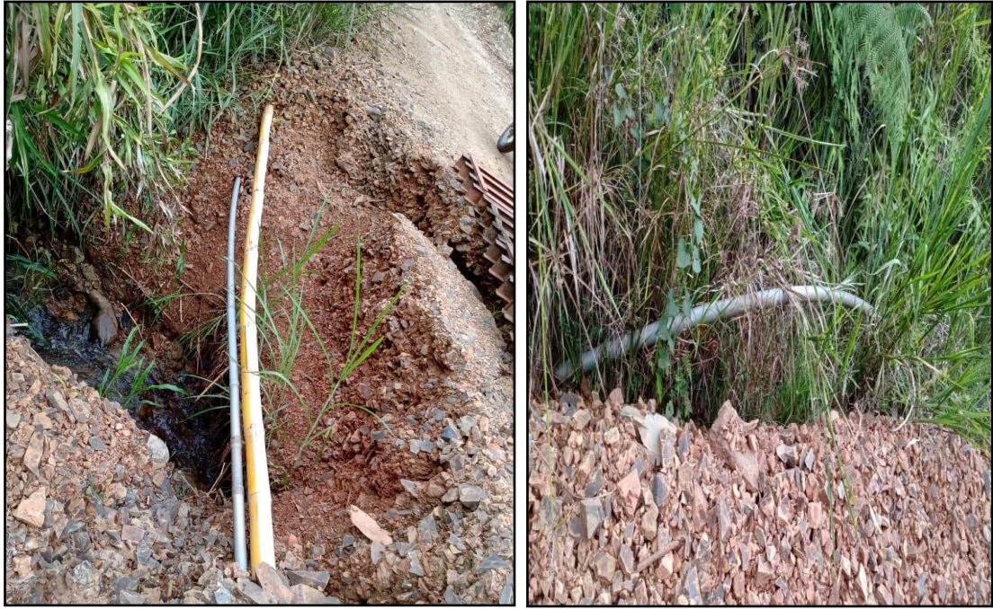
Figura 34: Tubería expuesta red de distribución
