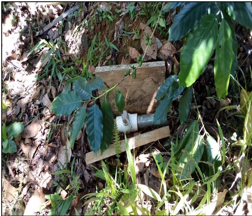
Figura 30: Tubería expuesta línea de conducción
