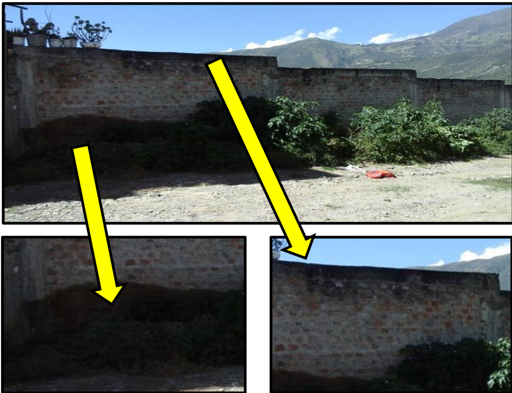
Foto N° 02: Vista de patologías, Humedad y Suciedad del cerco perimétrico del estadio municipal de Ranrahirca.
