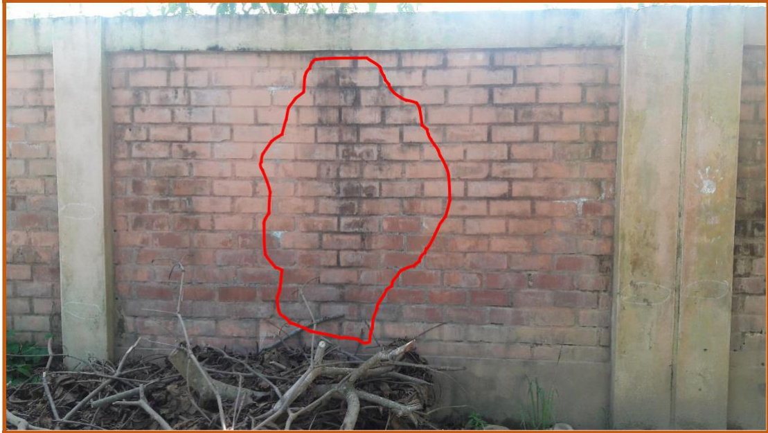
Figura 20. Se puede apreciar la patología [15] Hongos
