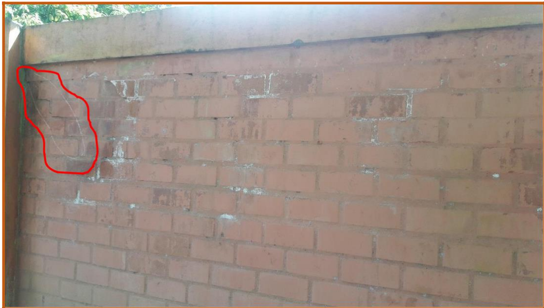
Figura 21. Se puede apreciar la patología [3] Fisura Diagonal
