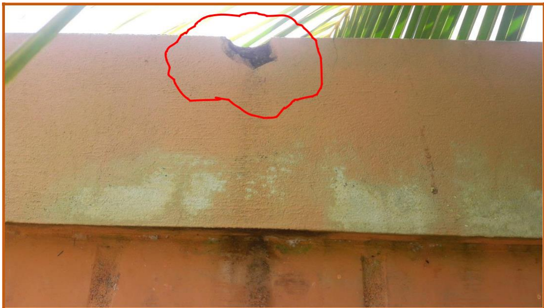
Figura 23. Se puede apreciar la patología [13] Picadura o cavitación.
