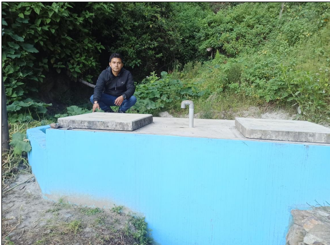
Fotografía 4: Se observa la captación existente del caserío de Paccha
