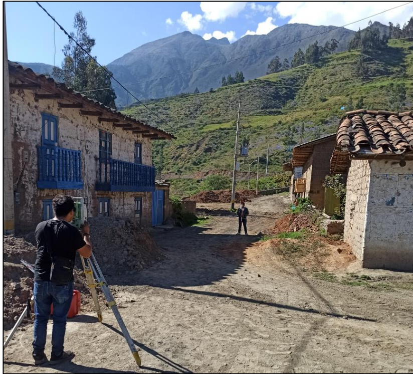
Fotografía 3: Tomando puntos topográficos en la red de distribución del sistema de abastecimiento de agua potable del caserío de Paccha
