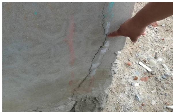
Gráfico 4: Grieta en un muro de albañilería.
