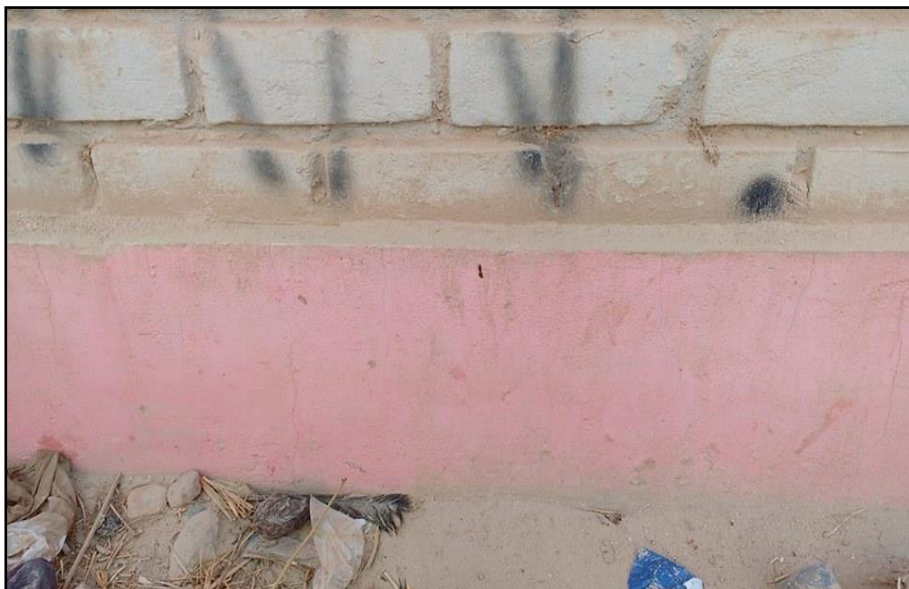
Gráfico 83: Presencia de suciedad en parte inferior del muro
