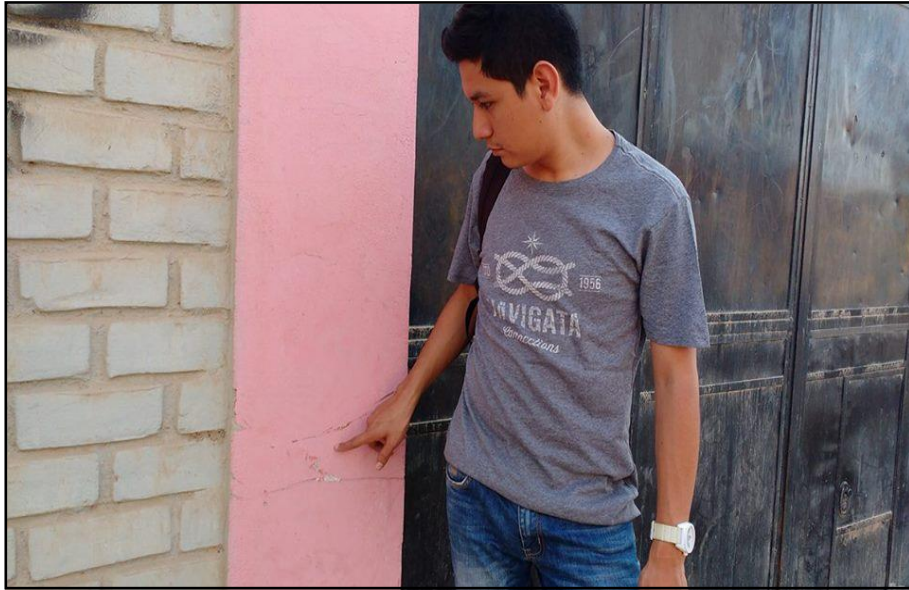
Gráfico 82: Presencia de fisuras en la columna.
