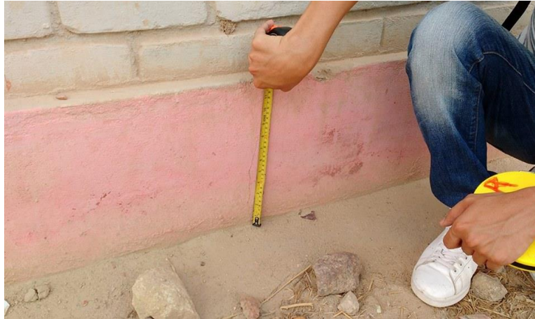
Gráfico 5: Fisura en un sobrecimiento.
