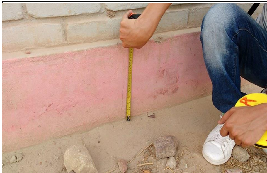
Gráfico 81: Presencia de fisuras en el sobrecimiento
