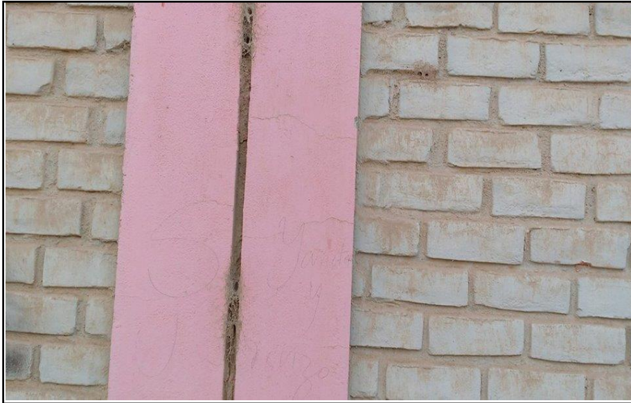
Gráfico 80: Presencia de fisuras en las columnas pertenecientes a la unidad de muestra 10.
