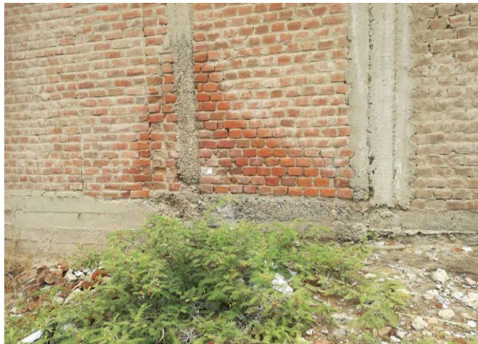
Gráfico 1: Humedad en muro de albañilería.
