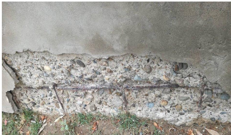
Gráfico 6: Desprendimiento del acabado en muro
