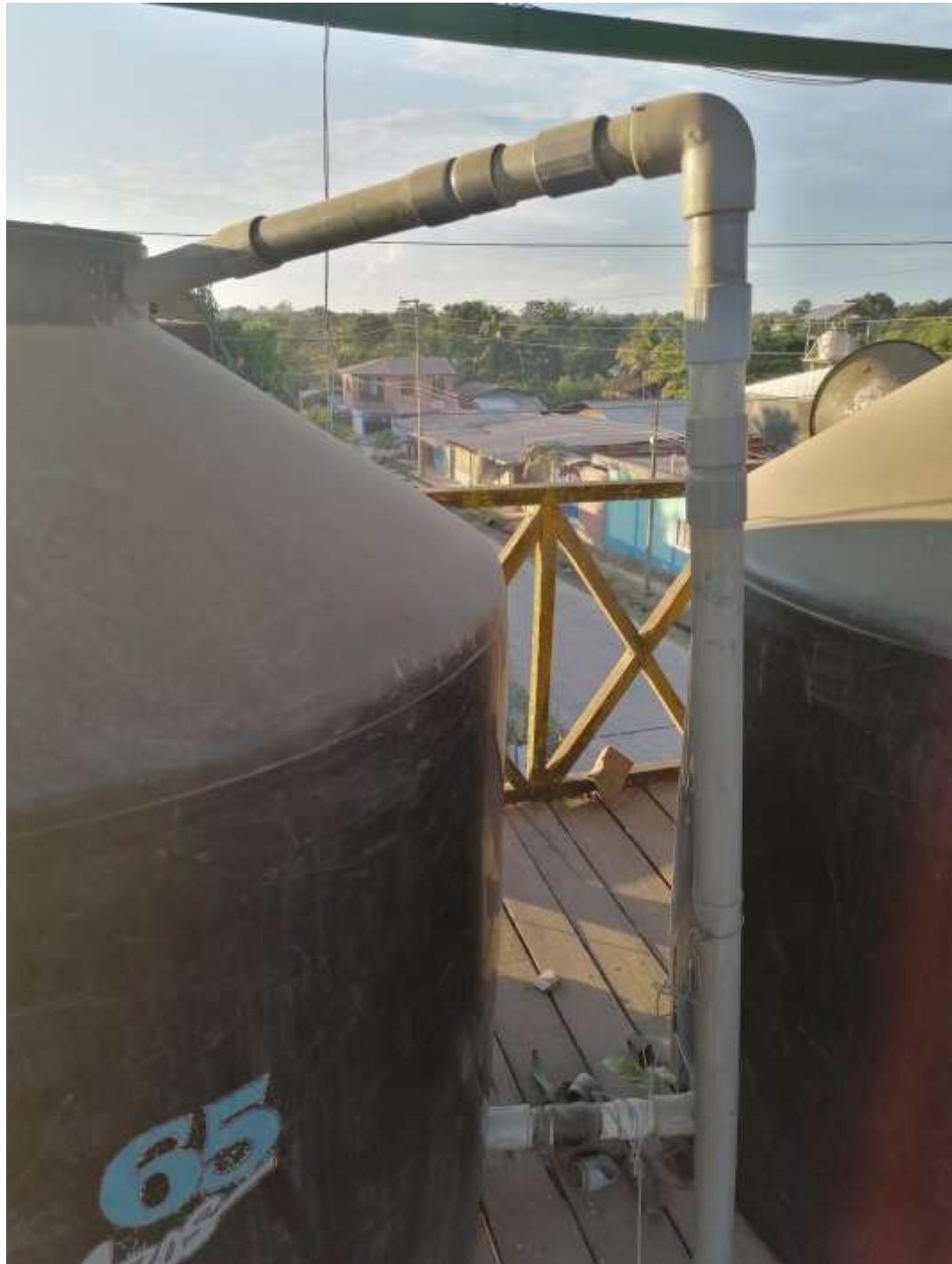
Imagen 25: Tanques de agua conectados entre sí, base de tanque a 7.50 metros a nivel del suelo.
