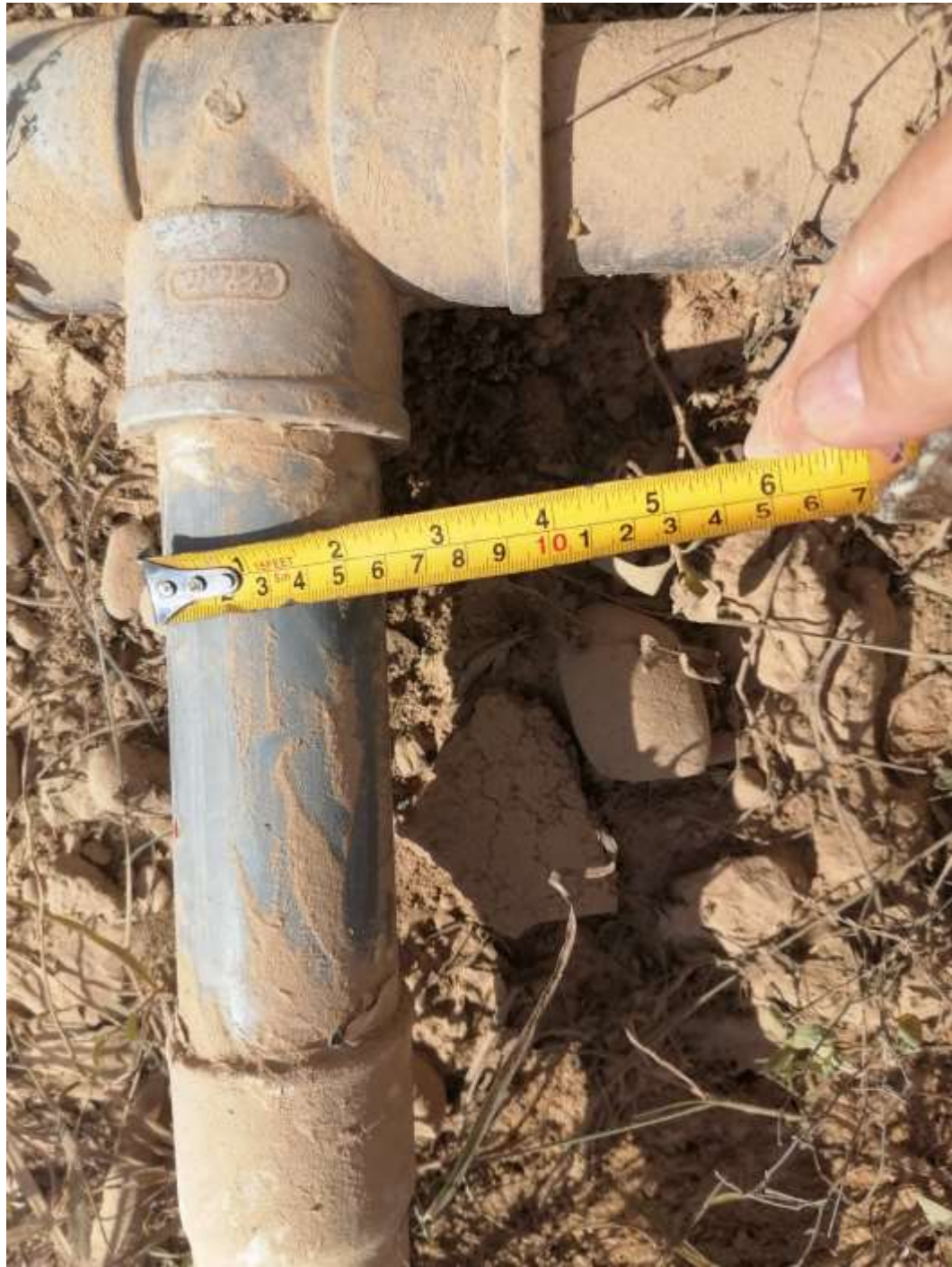
Imagen 27: Tubería de línea principal de 2" pulgadas, expuesta.
