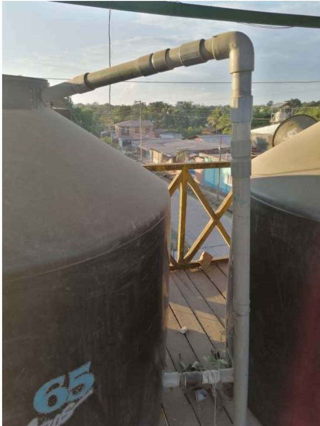
Imagen 21: Línea de impulsión conectada al reservorio con accesorios.
