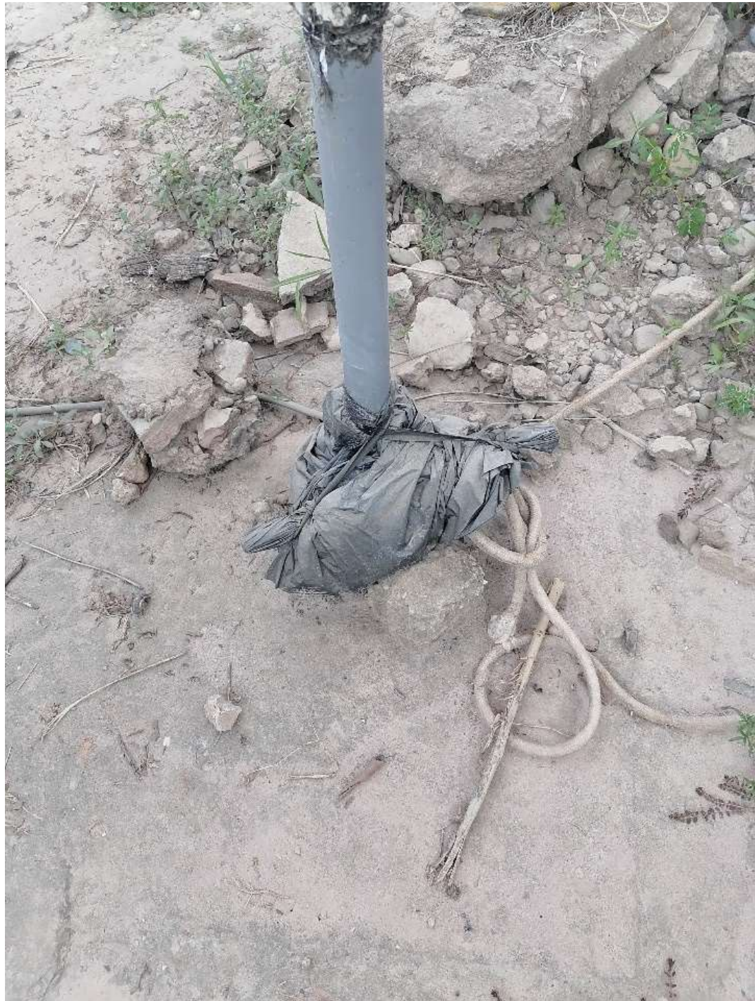
Imagen 18: Boca de la fuente de captación a nivel del suelo, se observa la línea de impulsión en el centro de la tubería.
