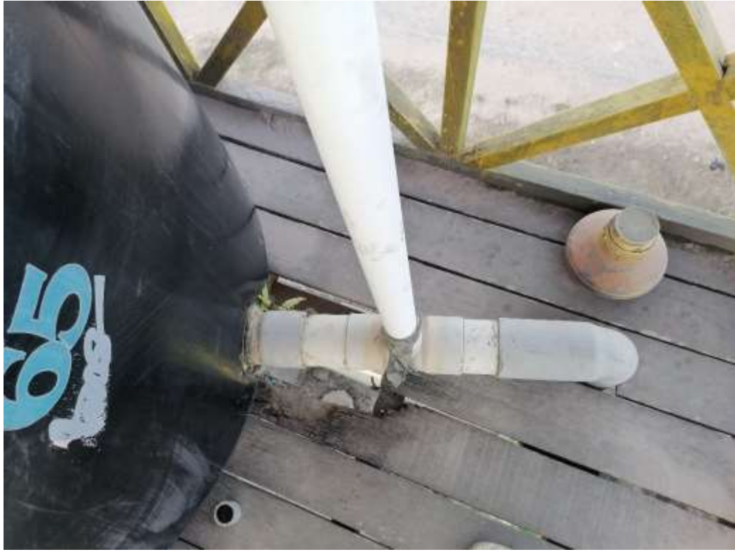
Imagen 22 Línea de aducción conectado al reservorio, en bajante.
