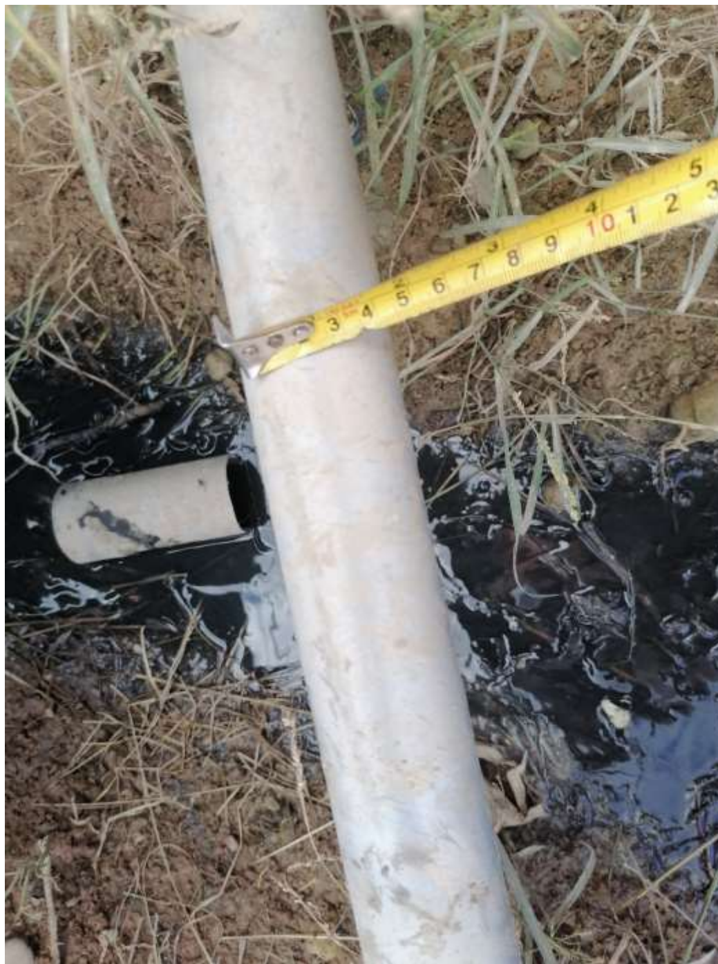
Imagen 28: Tubería de línea secundaria de 1 1/2" pulgadas, expuesta.
