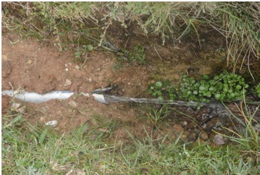
Foto 4: Vista a la intemperie línea de conducción.
