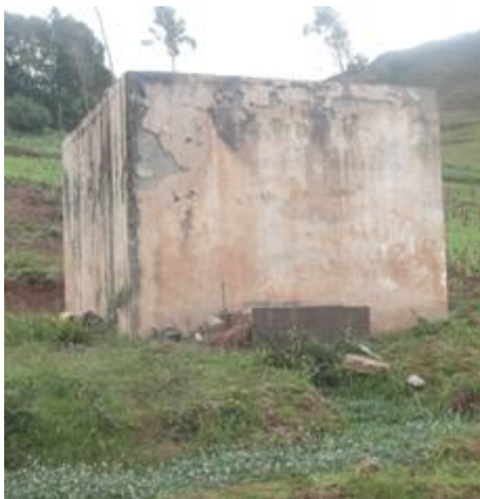
Foto 3: Reservorio deteriorado ubicado en la zona de Chongan.
