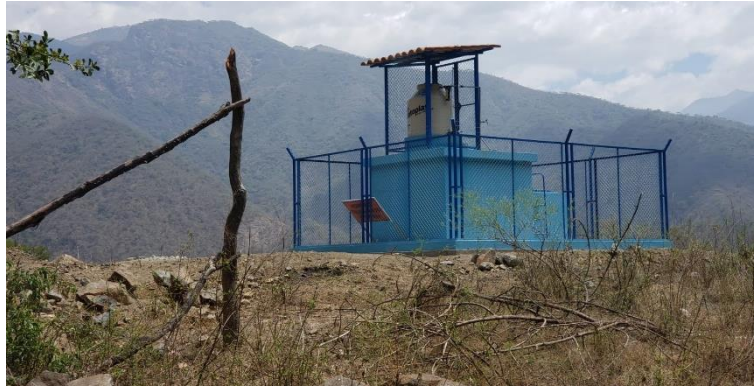
Gráfico 7: Estación de Bombeo
