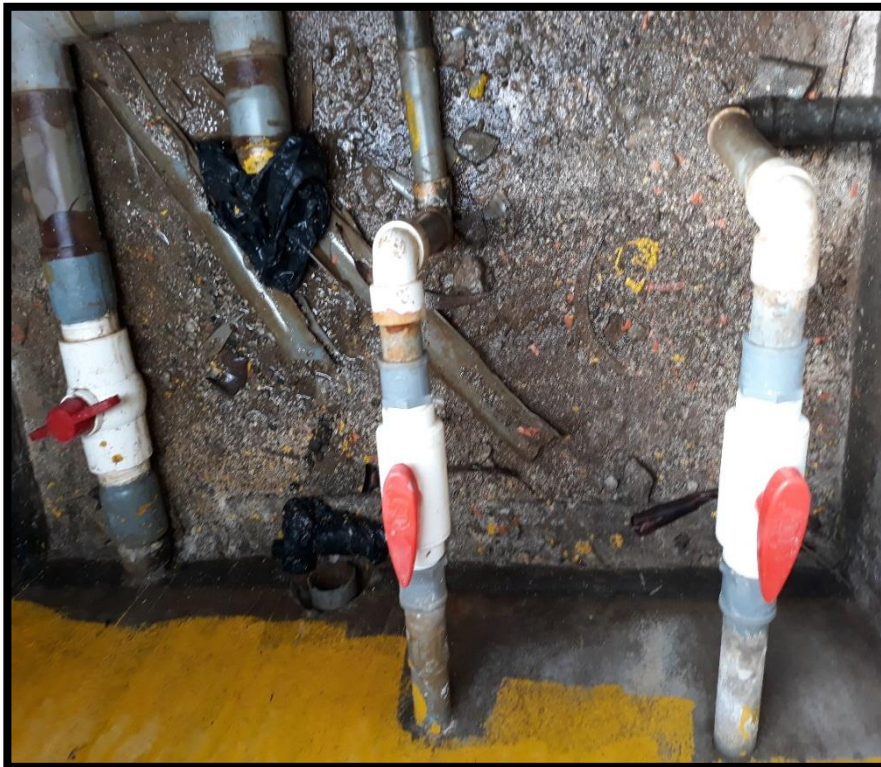
Imagen 06. Accesorios de la caseta de válvulas den malas condiciones
