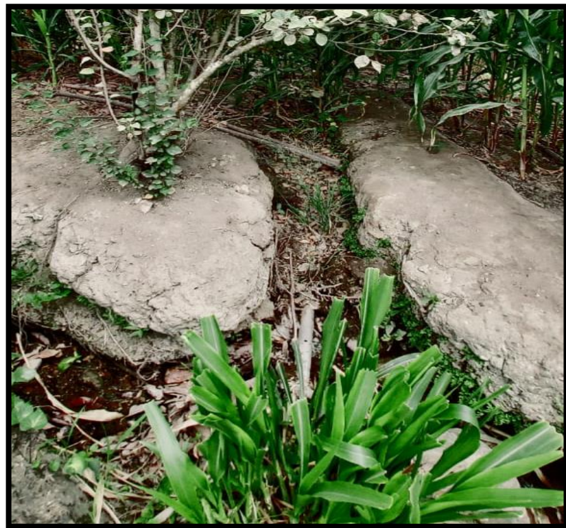
Imagen 04. Línea de conducción tramo 2 expuesta a la intemperie
