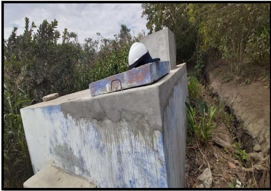
Imagen 05. Reservorio de almacenamiento actual sin cerco perimétrico que proteja la estructura.
