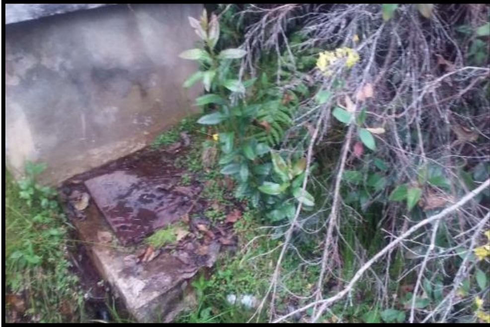
Imagen 13. Captación Santa María (Cámara húmeda y seca deterioradas)
