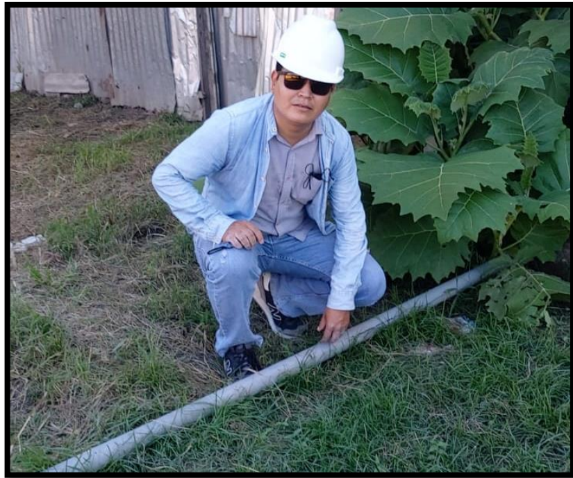
Imagen 03. Línea de conducción tramo 1 expuesta a la intemperie
