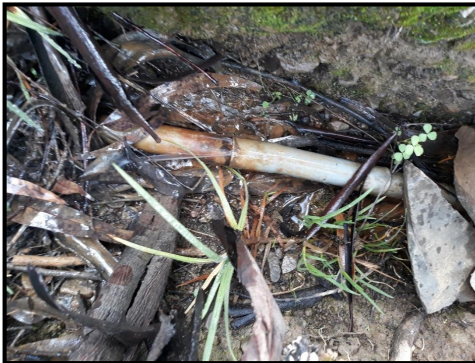
Imagen 08. Línea de aducción expuesta a peligros de la zona presentando patologías en los empalmes de la tubería.
