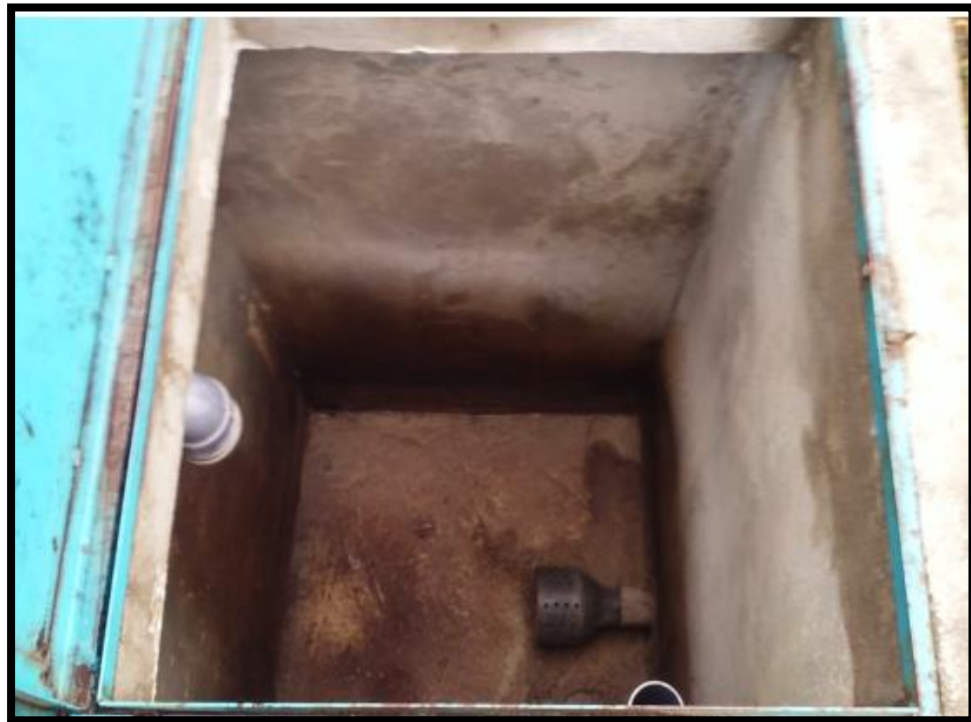
Imagen 12. Caseta de válvulas de la cámara rompe presión tipo 6.
