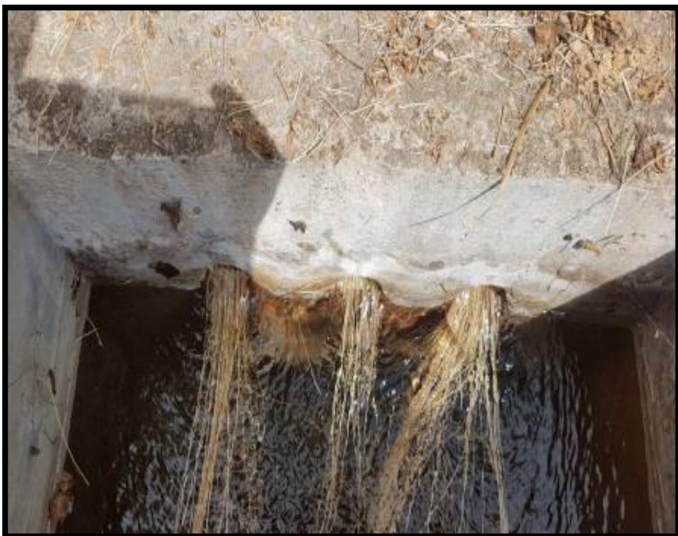
Imagen 02. Ancho de la pantalla de la captación en malas condiciones.
