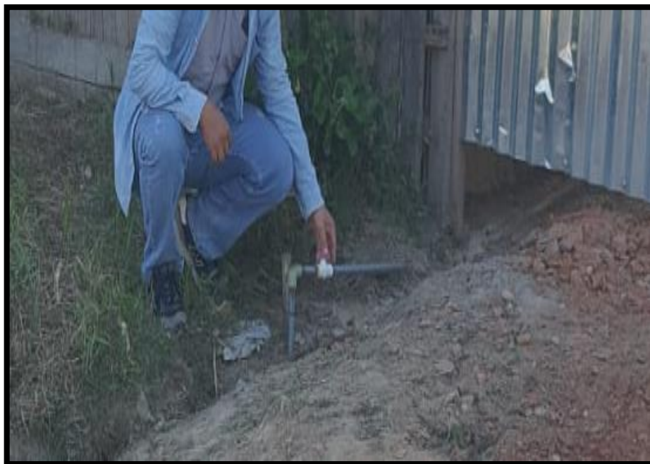
Imagen 10. Red de distribución expuesta a la intemperie (tubería secundaria)
