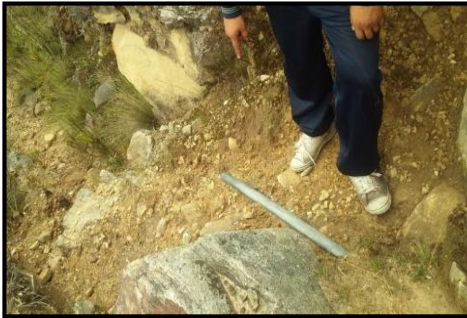
Imagen 07. Tubería de la línea de aducción expuesta a la intemperie.
