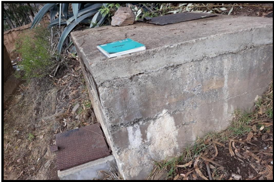
Imagen 11. Estado de la estructura de la cámara rompe presión tipo 6 encontrada en la línea de conducción
