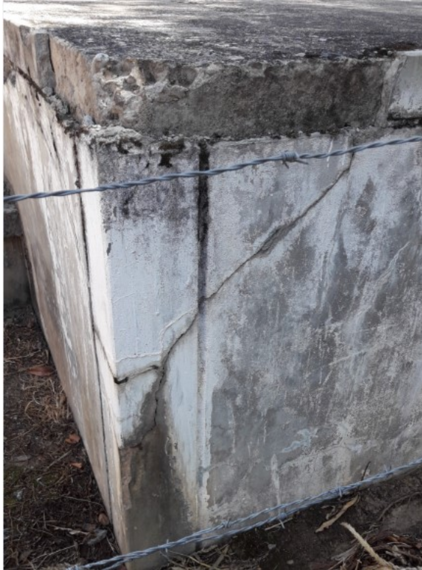
Fotografía N°02: Fotografía del Reservorio se visualiza la patologías: grieta y fracturamiento del muro sur del Reservorio de agua.
