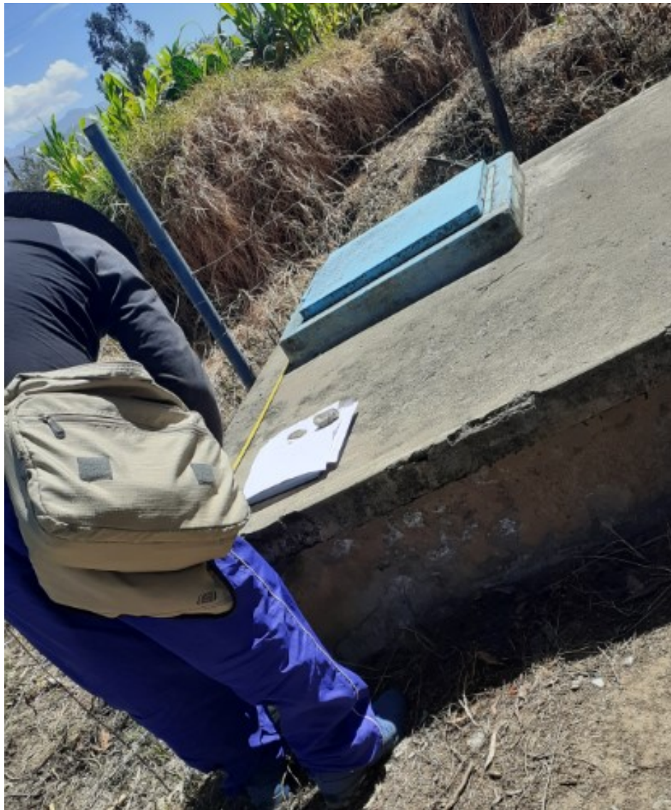
Fotografía N°06: Fotografía de la caja de válvulas donde se visualiza la medición de las patologías haciendo uso de una wincha.
