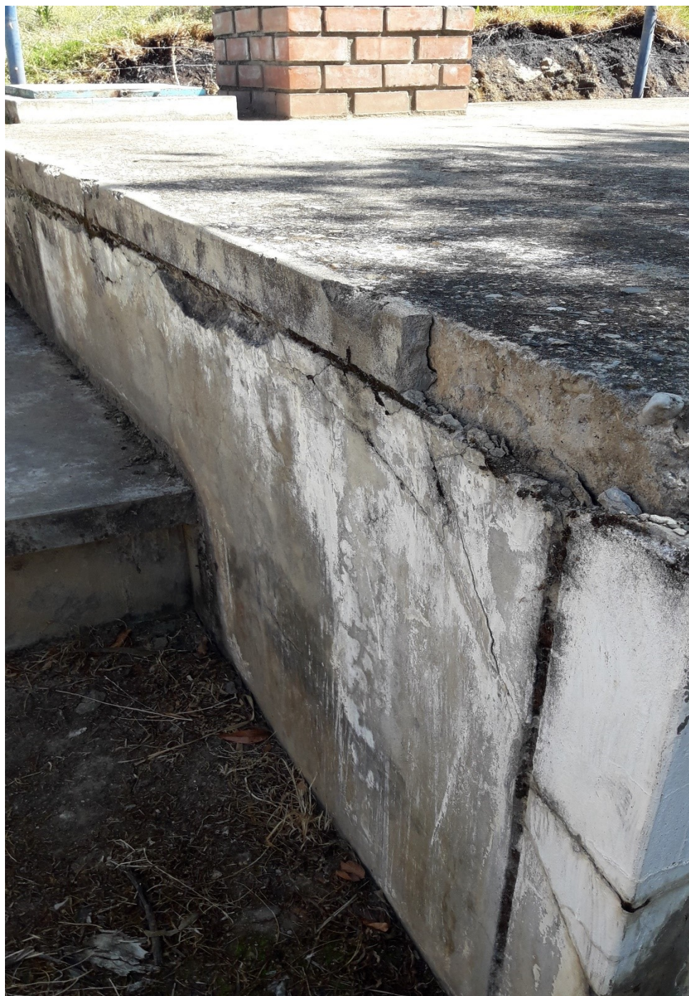
Fotografía N° 03: Fotografía del Reservorio se visualiza la patología fracturamiento en el muro oeste del reservorio.
