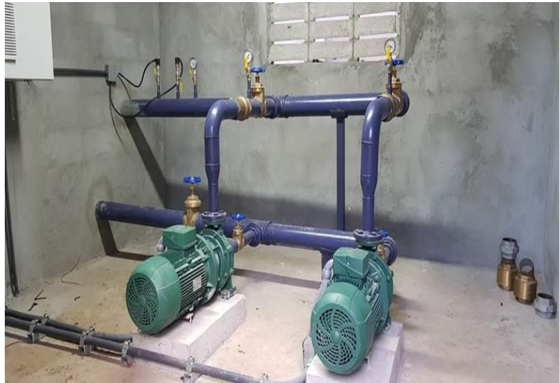
Figura 06: Estación de bombeo
