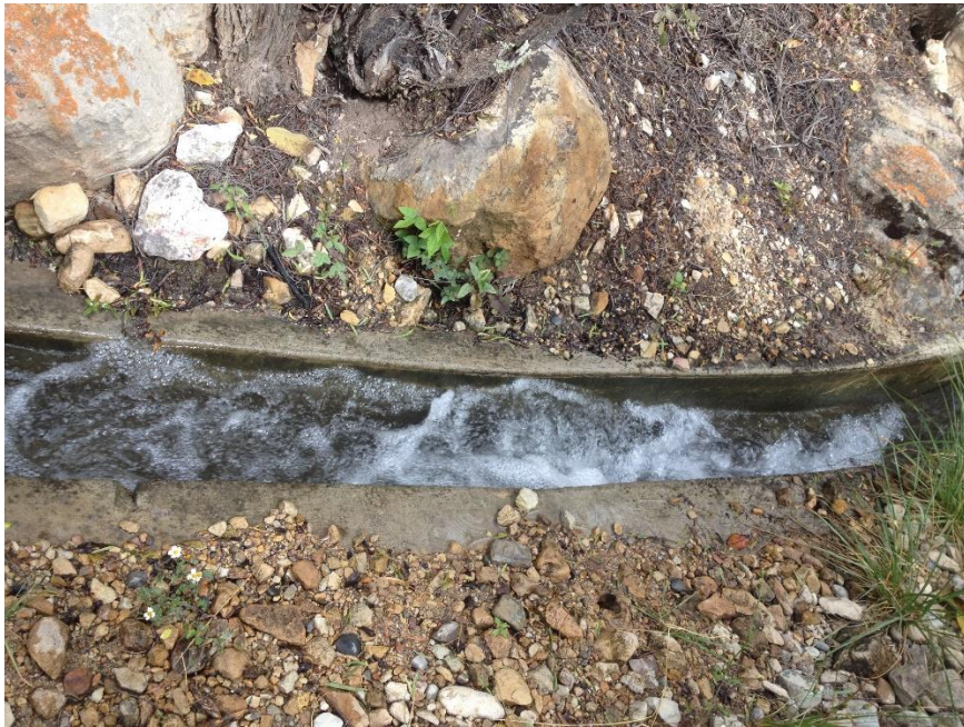
Fotografía 03 Vista del canal en conducción del agua, este sobrepasa al diseño
