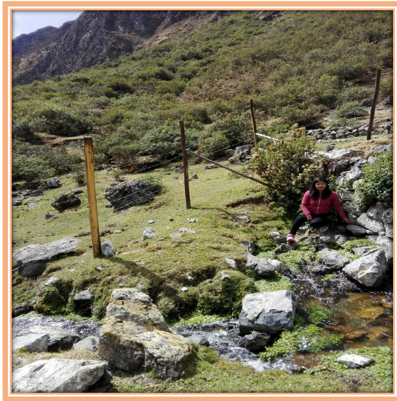
Figura 30: Cerco perimétrico de la captación deteriorada
