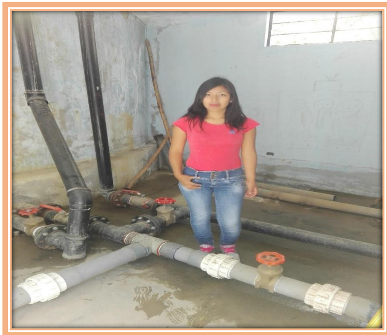
Figura 29: Caseta de Válvulas y llaves del reservorio
