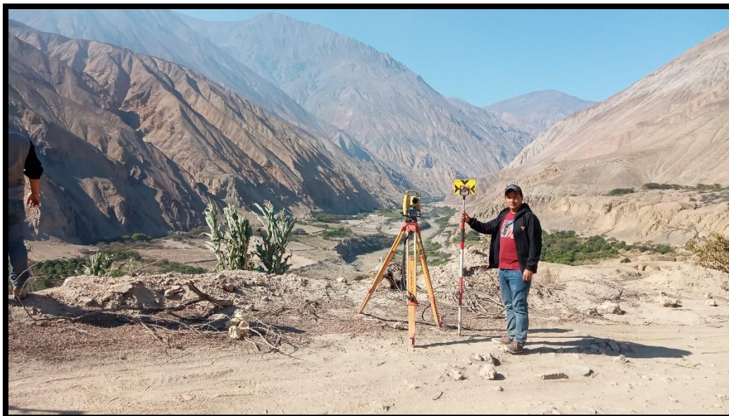
Fotografía N° 10: En la imagen se observa que se está realizando la topografía para la distribución del agua potable.
