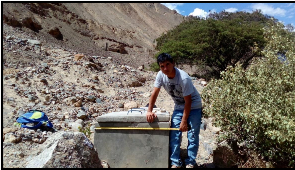
Fotografía N° 05: Cámara rompe presión CRP. n°06 actual del caserío de Taquilpon.
