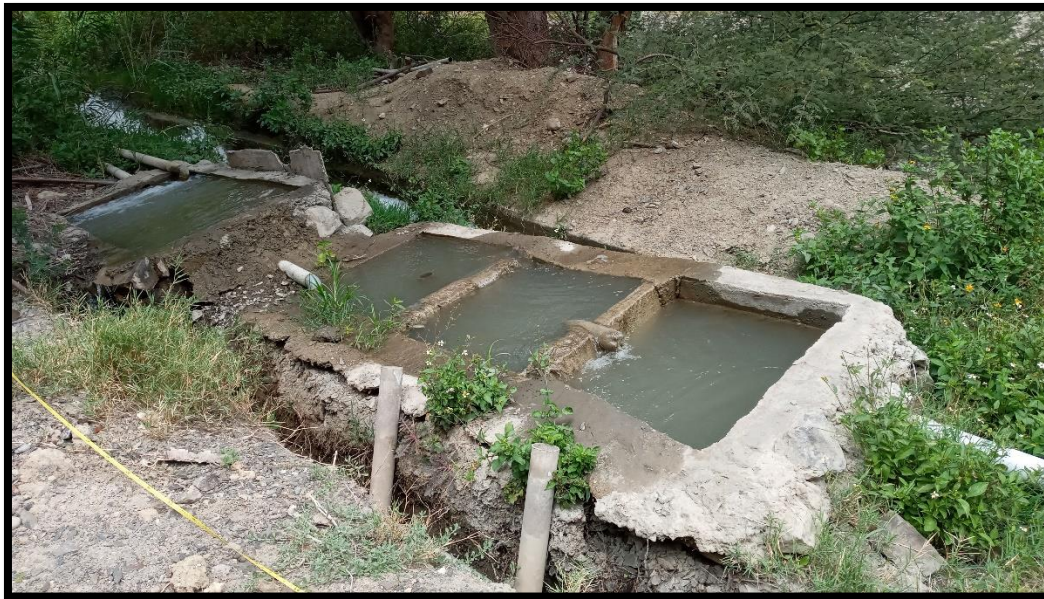
Fotografía N° 03: En la imagen se observa que el sistema de abastecimiento de agua, está siendo abastecido por agua del canal de riego.
