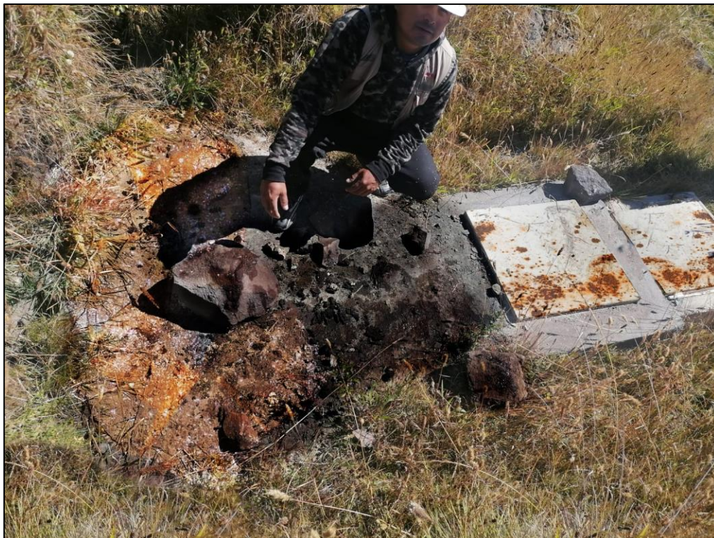
Imágen 4 Obra de captación por manantial (Chaquilma Alta) tipo ladera y concentrado
