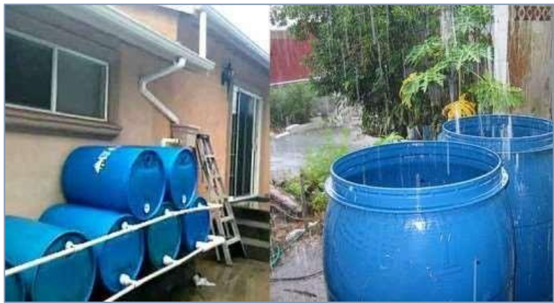
imagen 4 sistema de agua por lluvia
