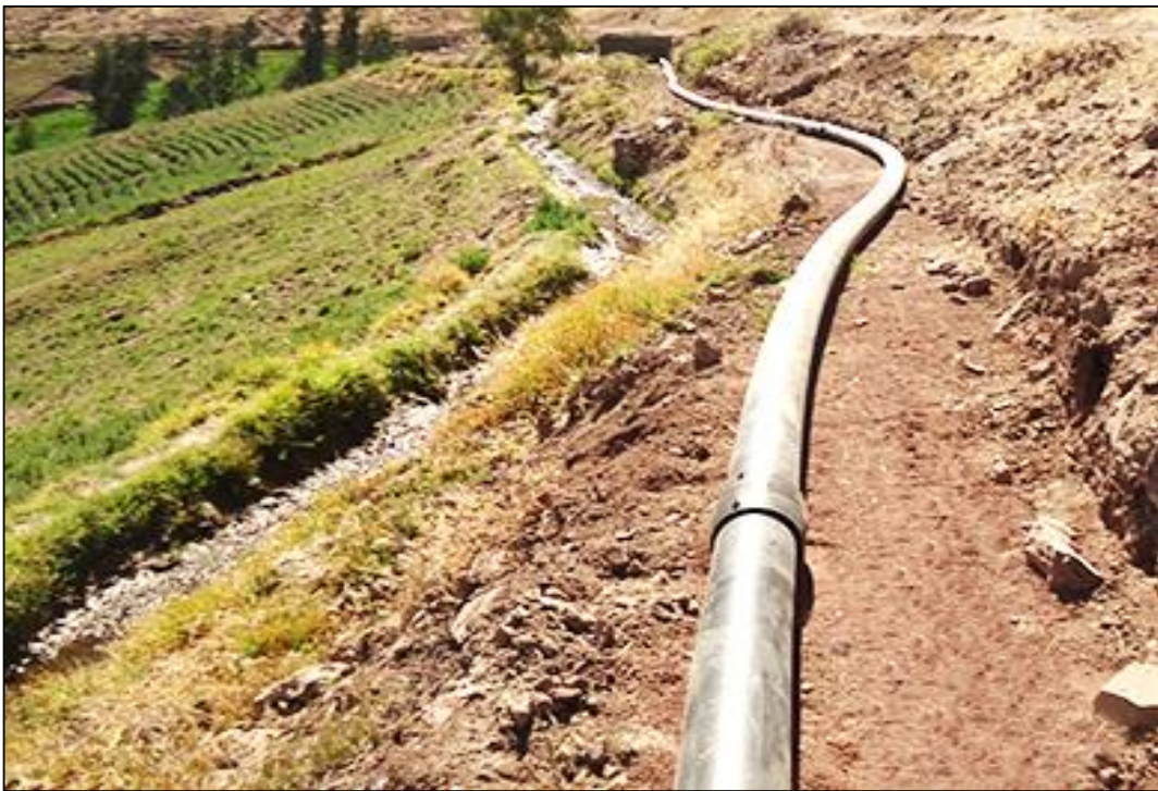
Imagen N° 1 línea de conducción
