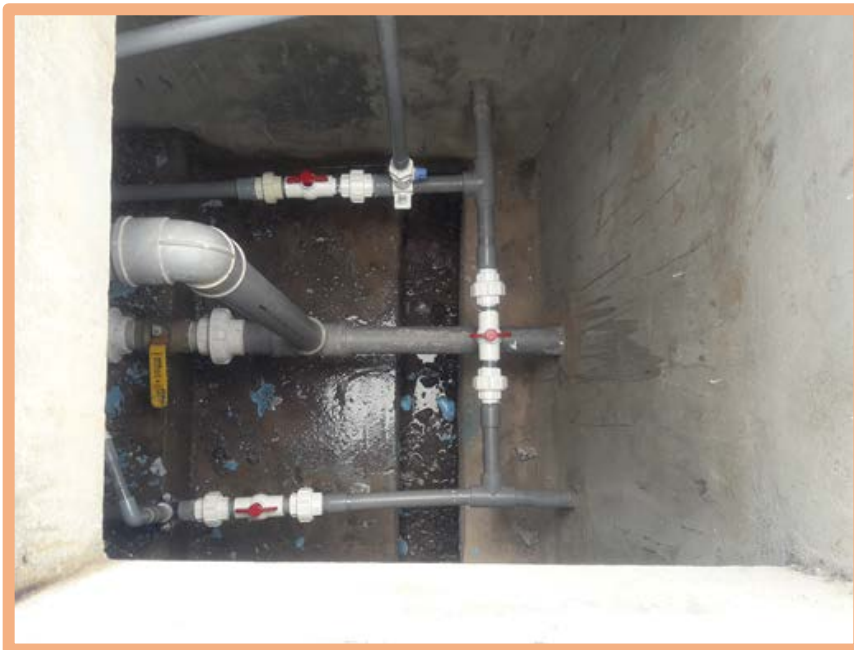
FOTOGRAFIA 8: CAJA DE RESERVORIO
