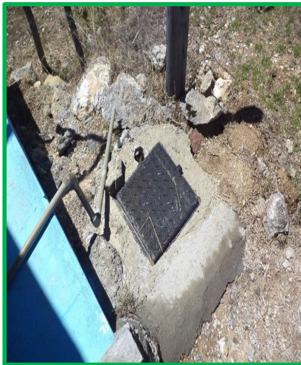
Caja de válvula de entrada.
