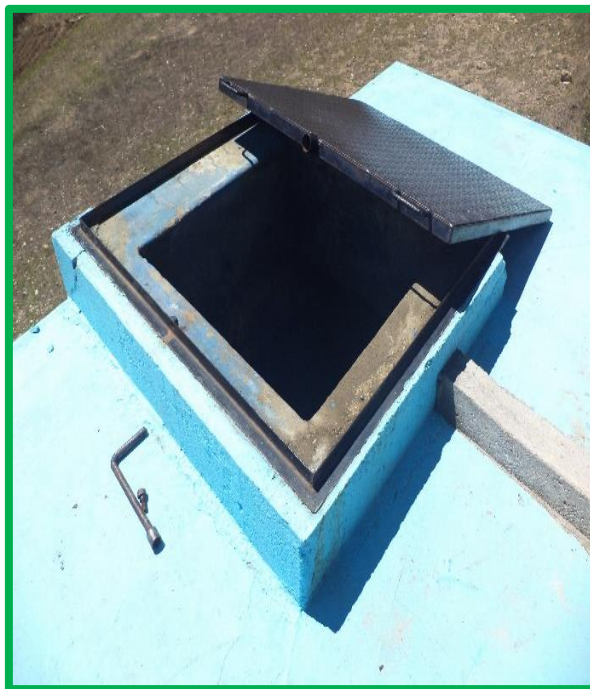
Tapa sanitaria del reservorio
