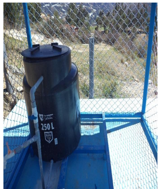
Imagen N° 31: Sistema de cloración
