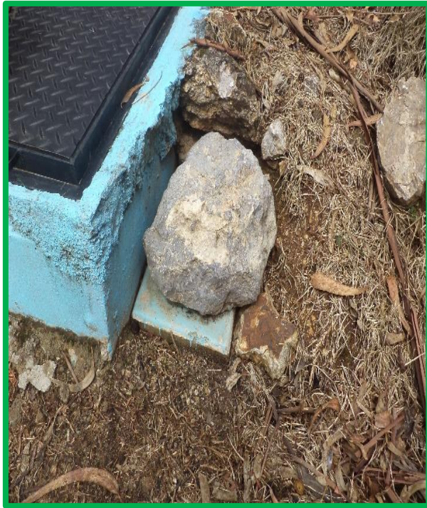
Caja de válvulas
