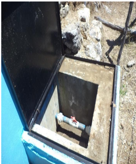
Imagen N° 30: Caseta de Válvulas.
