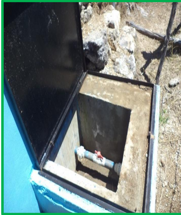
Caseta de Válvulas.
