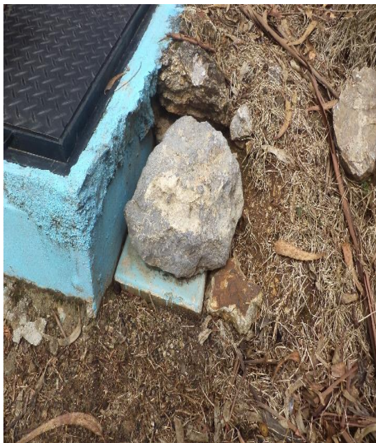
Imagen N° 24: caja de válvulas
