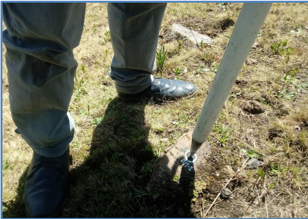
Figura 09: Ubicación del BM-2, que servirá para el replanteo del sistema de agua potable.
