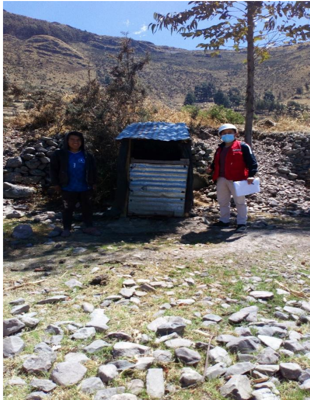
Fotografía 7: vista de una letrina en malas condiciones.
