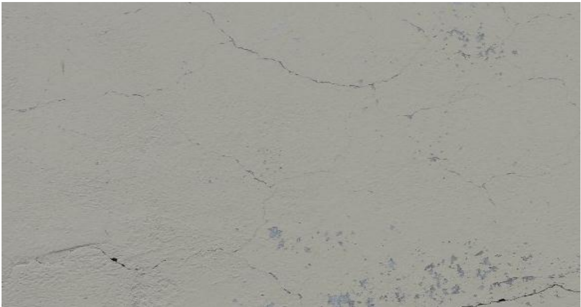
Fotografía 02: Daños producido en la estructura por fisura
