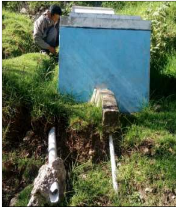
Fotografía 7: Tubería expuesta a la intemperie en la red de distribución
