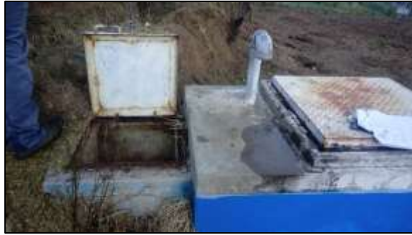
Fotografía 6: Caja de válvulas del CRP-7
