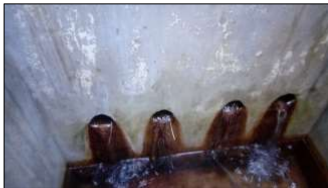
Fotografía 2: Filtrantes de la Captación
