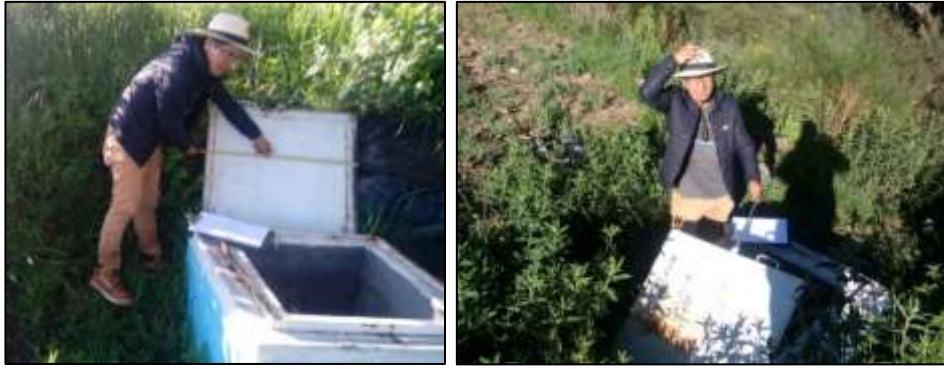
Fotografía 4: Cámara rompe presión tipo 6 (CRP-6) en la línea de conducción
