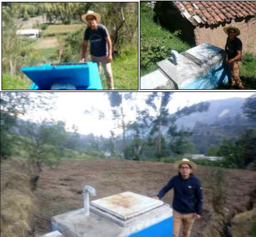
Fotografía 6: Cámara rompe presión tipo 7 (CRP-7) en la red de distribución
