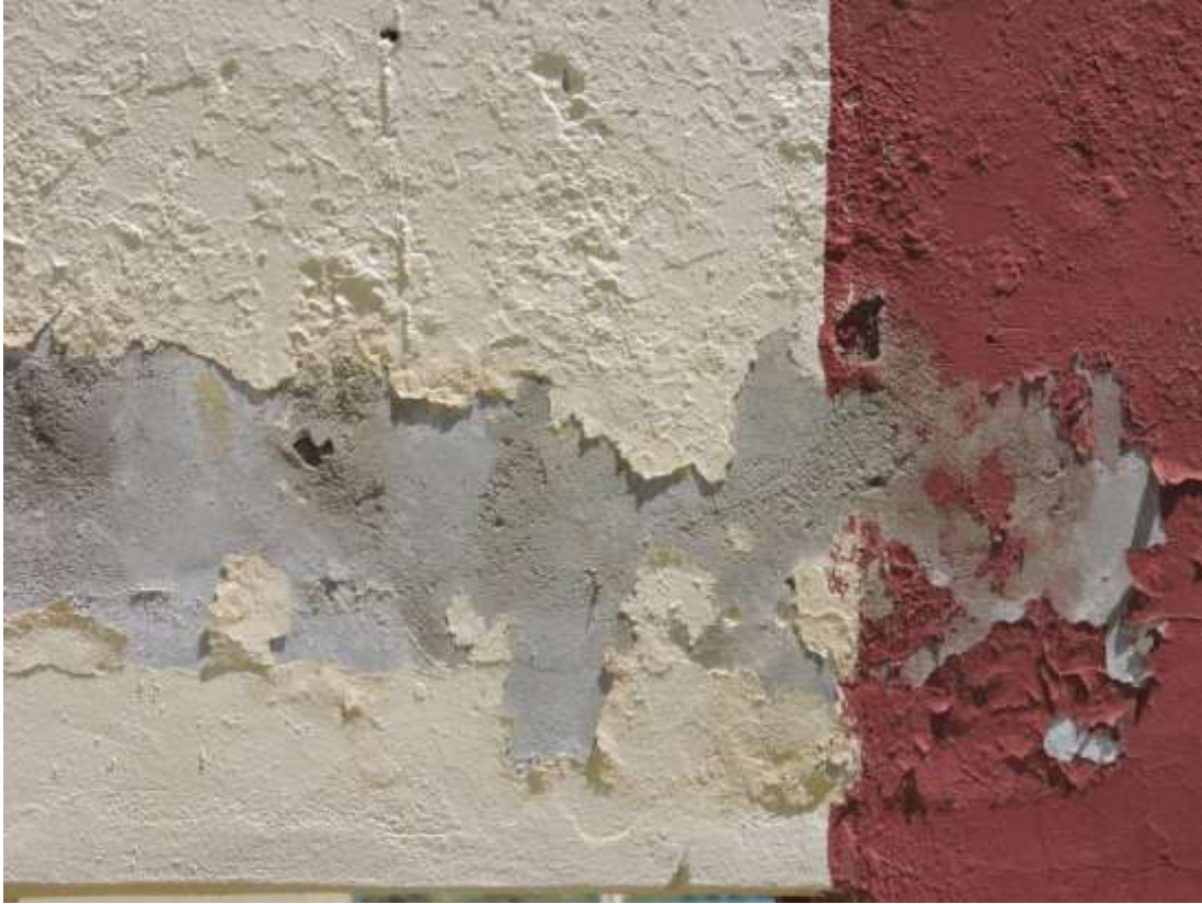
Fotografía 07- Vista del muro con presencia de descascaramiento ubicado en el lado lateral izquierda externo del Instituto de Educación Superior Tecnológico Vicente Ferrer – Tumpa
