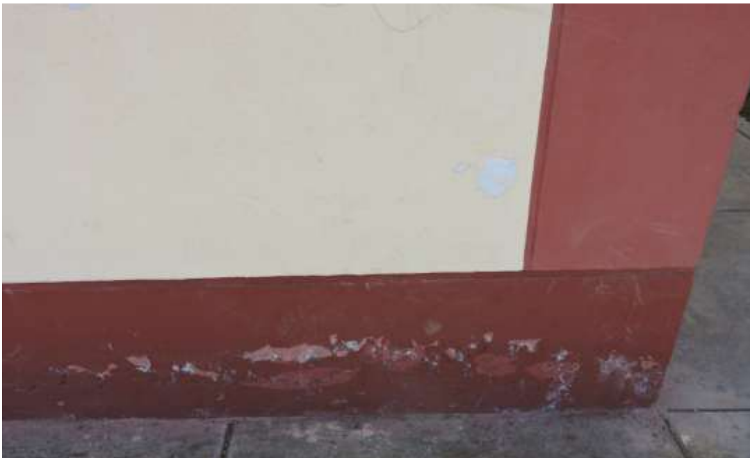
Fotografía 08- Vista del sobre cimient - muro con presencia de eflorescencia ubicado en el lado lateral frontal externo del Instituto de Educación Superior Tecnológico Vicente Ferrer – Tumpa.
