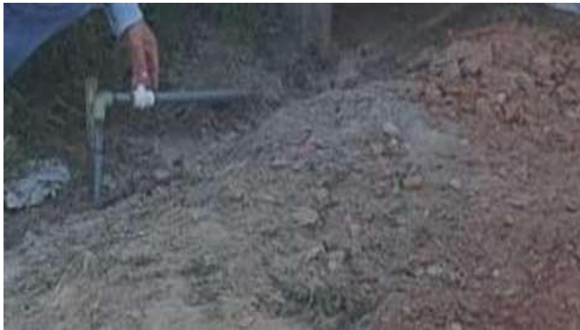
Imagen 10. Dentro de la red de distribución se encuentra expuestas al peligro la línea principal hacia la red secundaria.
