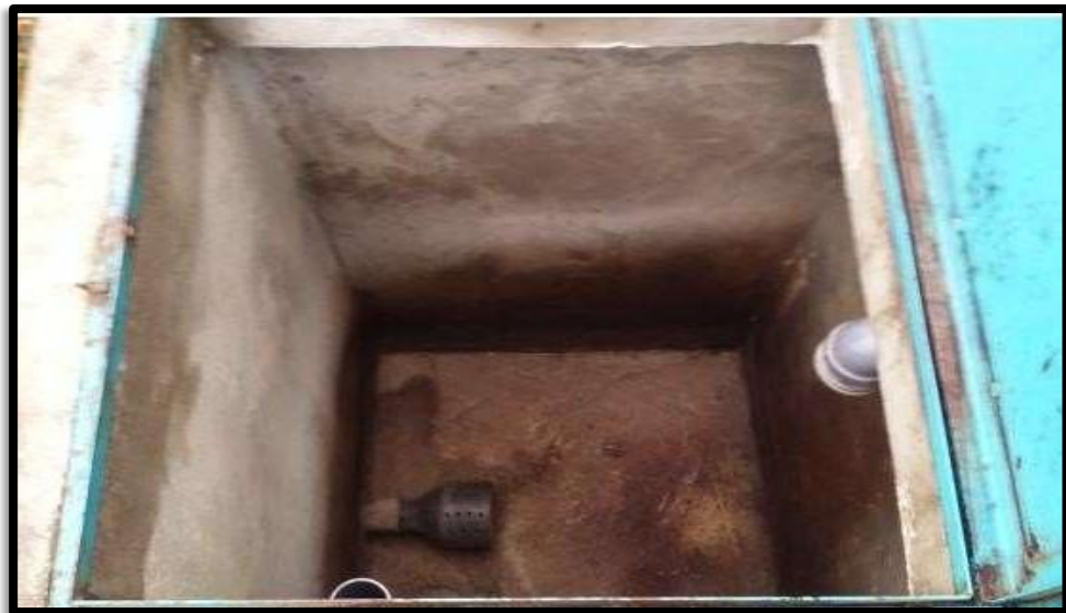
Imagen 12. Caseta de válvulas CRP 6.
