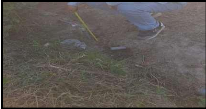
Imagen 09. Dentro de la red de distribución se encuentra expuestas al peligro la línea principal
