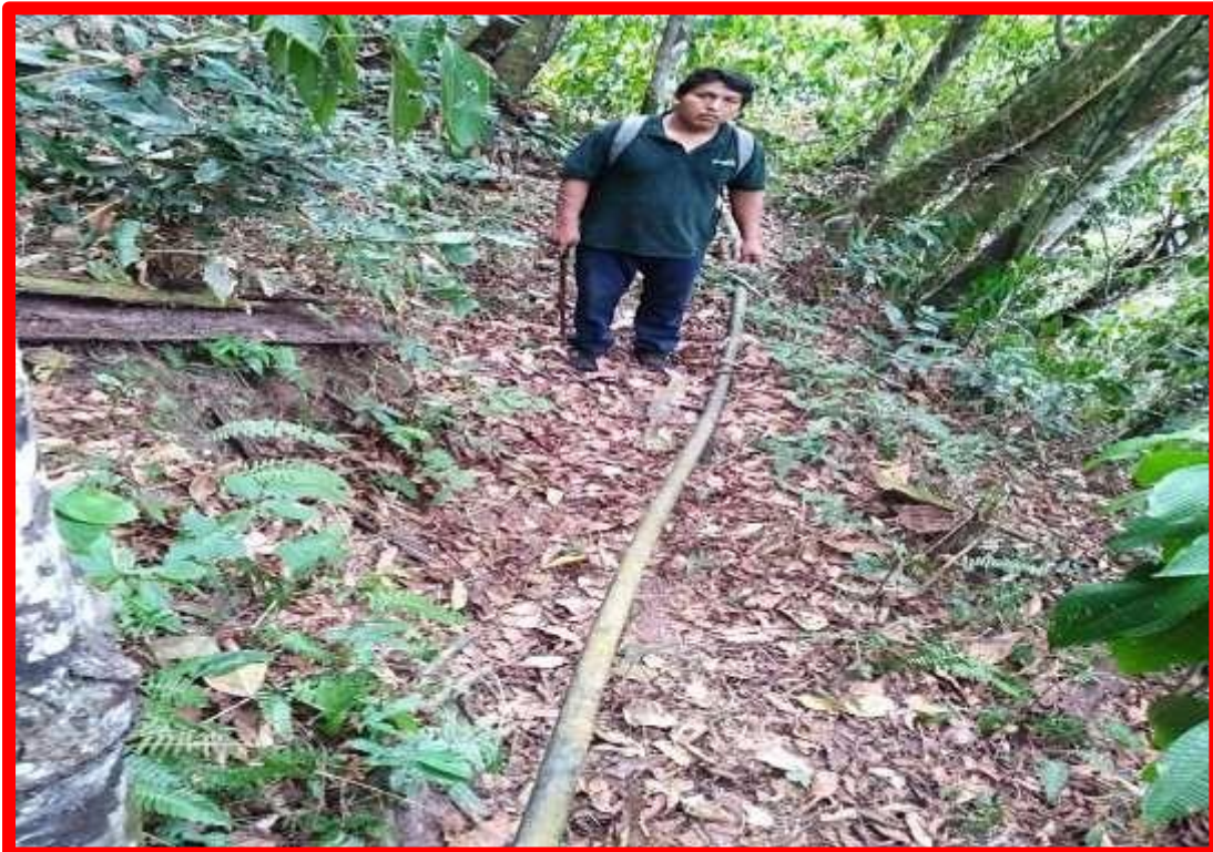
Imagen 14. Tubería en expuesto en línea de conducción
