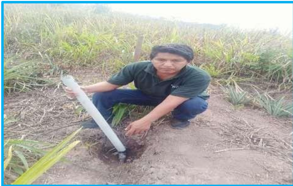
Imagen 08. La tubería está expuesta a peligros en la zona presentando patologías en los empalmes de Línea de aducción.
