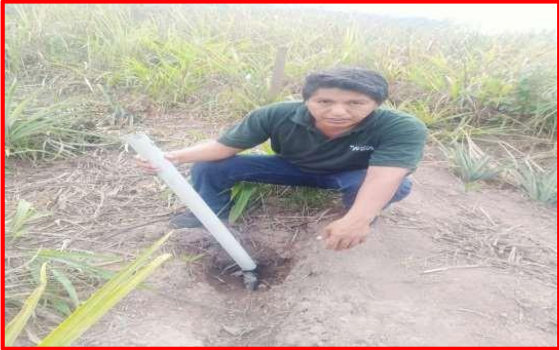
Imagen 15. La falta de la válvula de purga
