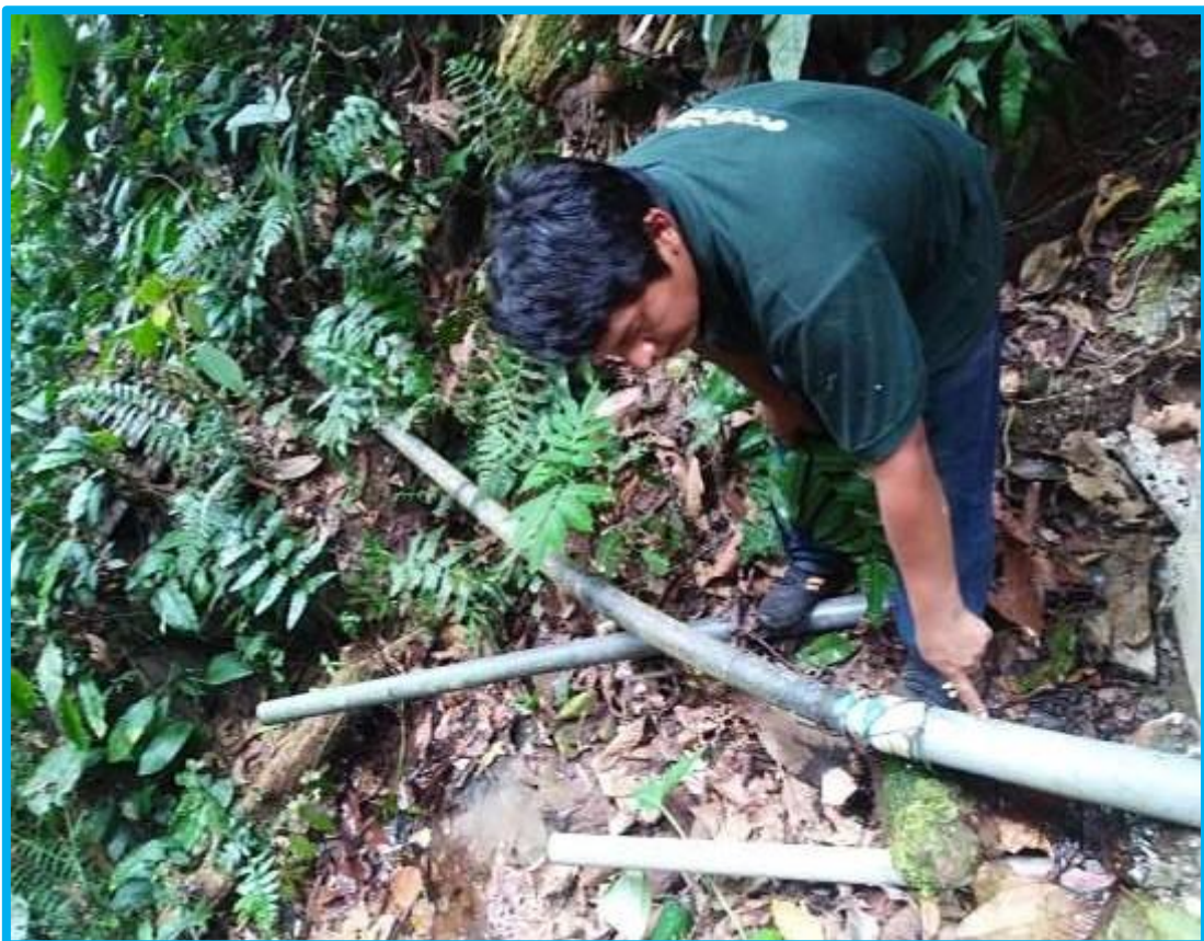
Imagen 02. Captación sin válvulas de control en malas condiciones.
