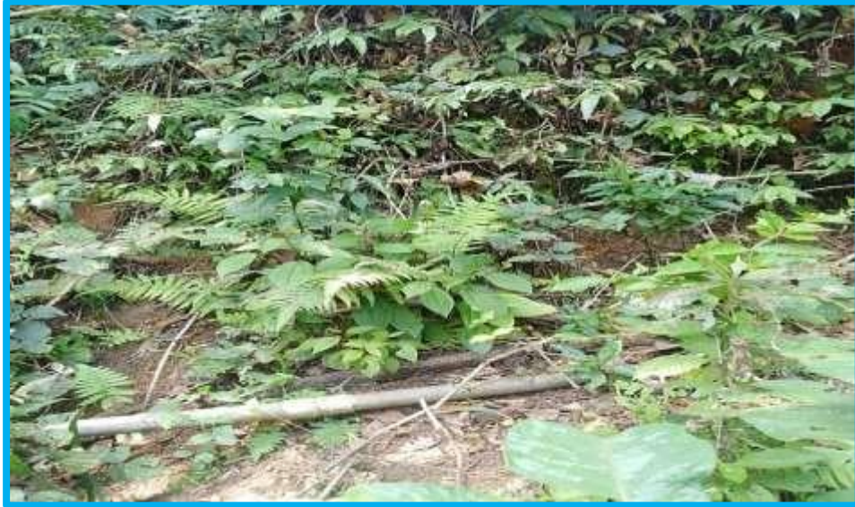
Imagen 07. Tubería de la línea de aducción expuesta a la intemperie.
