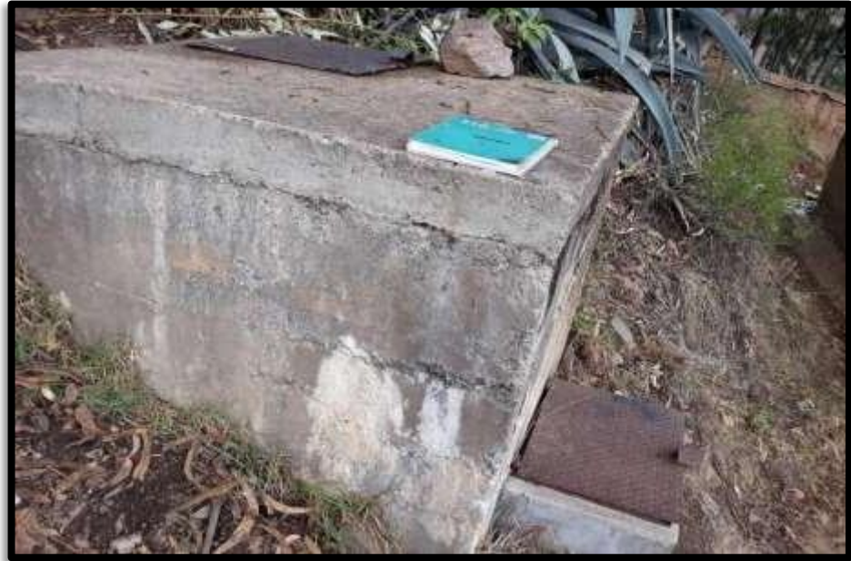
Imagen 11. Línea de conducción, encontrado el estado de la estructura de la CRP 6 .
