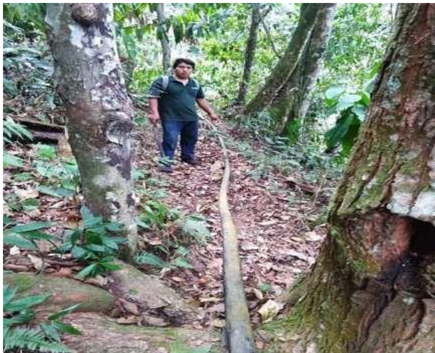
Imagen 04. Tubería expuesta a las intemperies , “línea de conducción”
