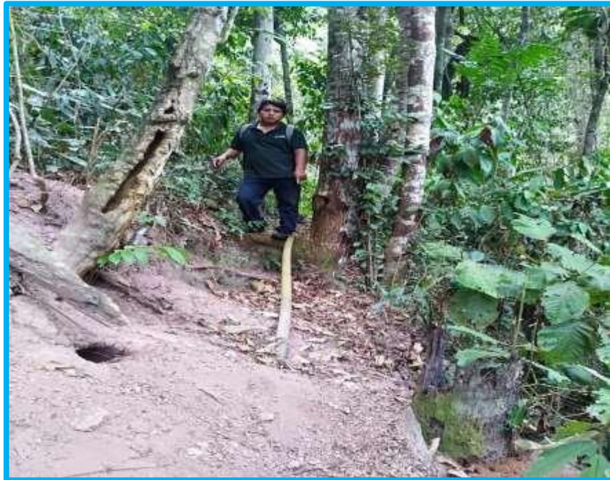
Imagen 03. Tubería expuesta a las intemperies, “línea de conducción”
