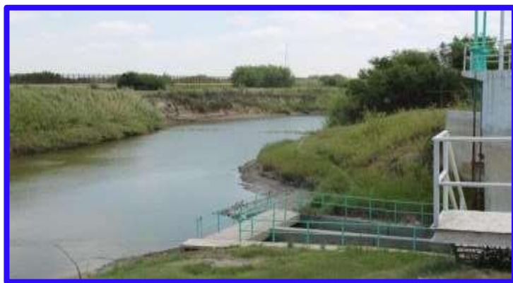
Figura 2. “Captación una fuente superficial (río)”.
