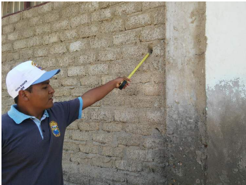
Figura 106: Fotografía donde se observa la patología de Cráteres
