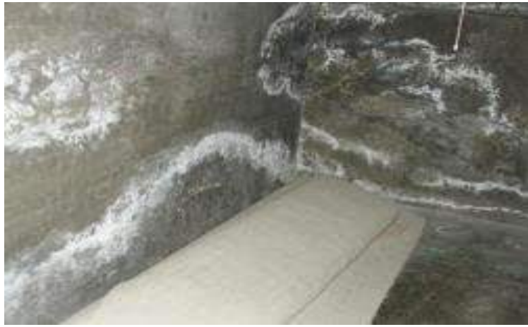
Figura 14. Imagen de eflorescencia en las paredes.
