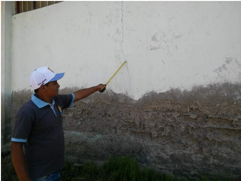
Figura 102: Fotografía donde se observa la patología de Grieta
