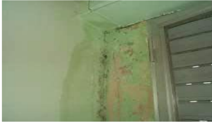
Figura 20. Imagen de filtración
