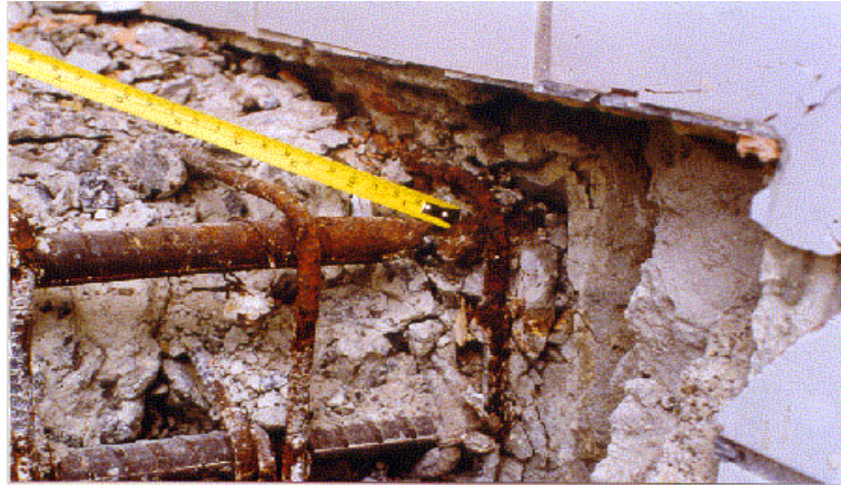
Figura 09. Imagen de corrosión
