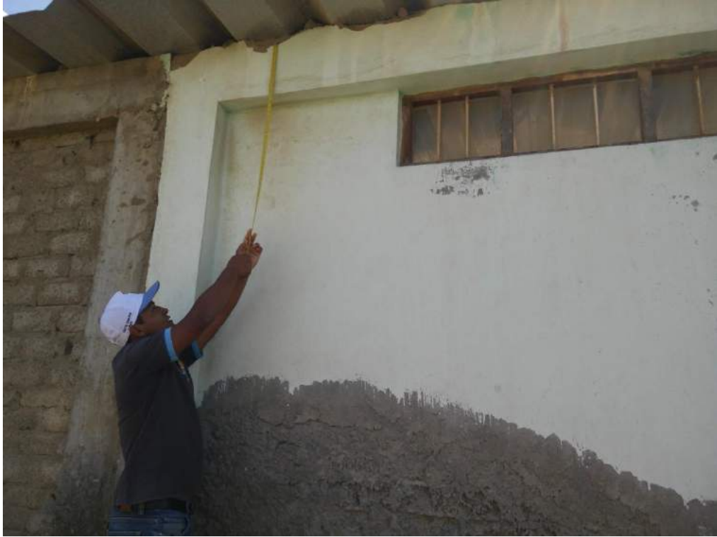
Figura 109: Fotografía donde se observa la patología de Cráteres
