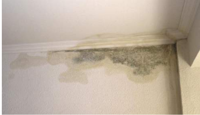
Figura 22. Imagen de goteo en paredes
