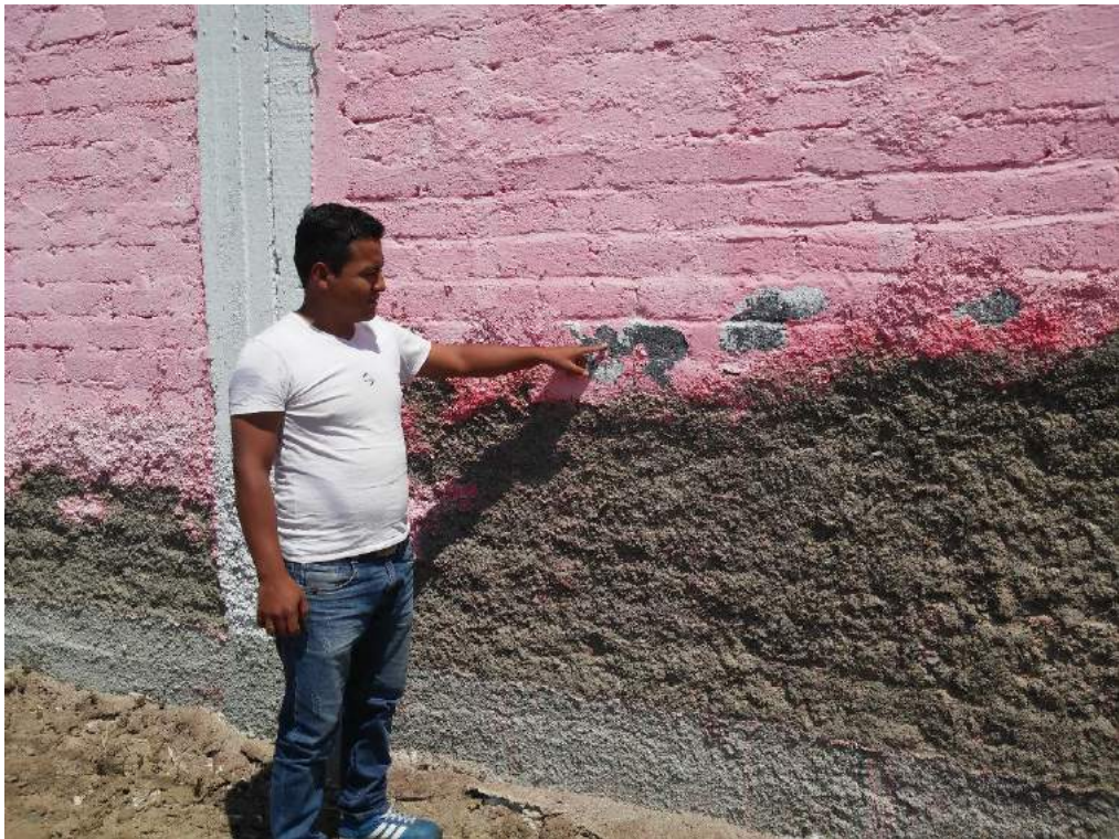
Figura 110: Fotografía donde se observa la patología de Delaminación
