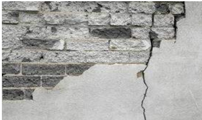
Figura 23. Imagen de grieta de muros
