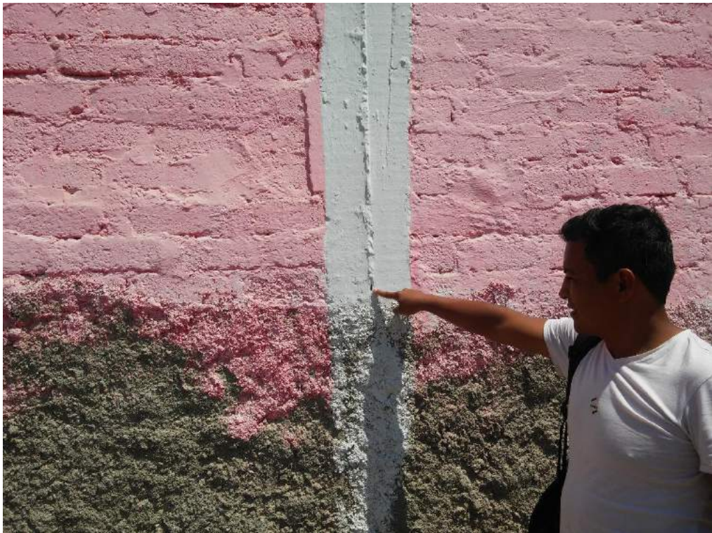
Figura 104: Fotografía donde se observa la patología de Picaduras
