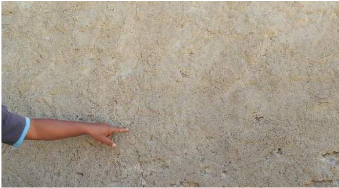
Figura 119: Fotografía donde se observa la patología de Fisuras
