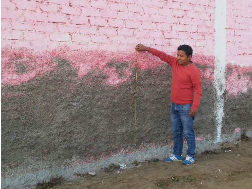
Figura 103: Fotografía donde se observa la patología de Eflorescencia
