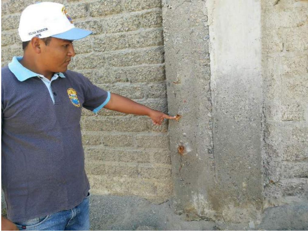
Figura 101: Fotografía donde se observa la patología de Corrosión
