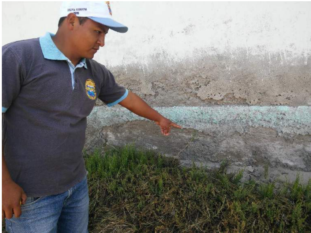
Figura 108: Fotografía donde se observa la patología de Eflorescencia
