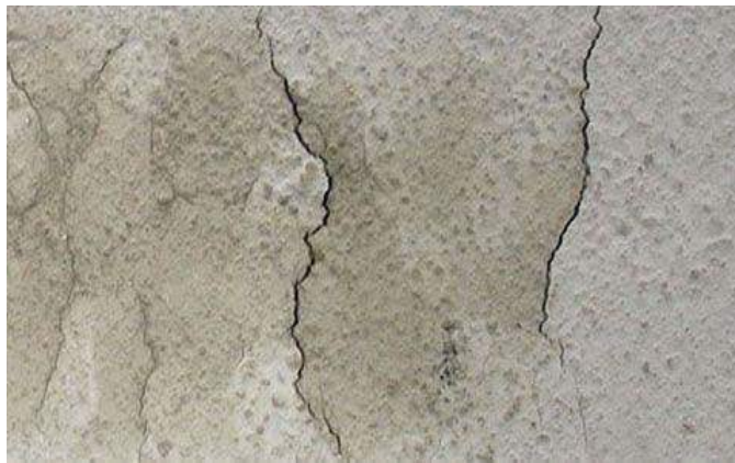
Figura 21. Imagen de fisuras
