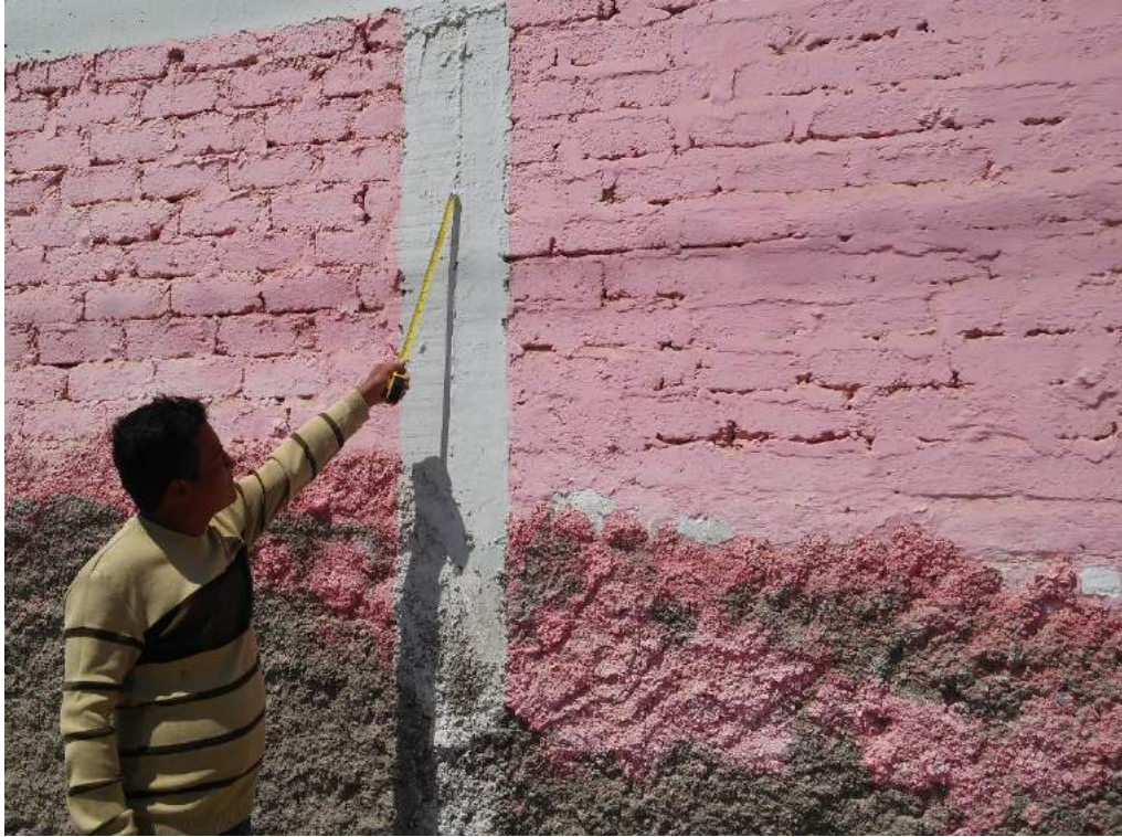
Figura 107: Fotografía donde se observa la patología de Picaduras
