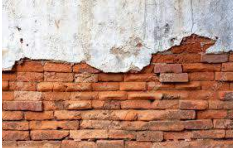
Figura 15. Imagen de erosión en los muros
