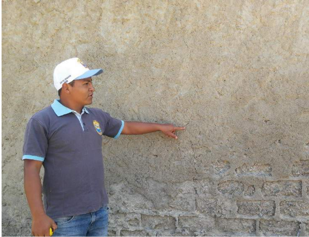
Figura 105: Fotografía donde se observa la patología de Fisuras
