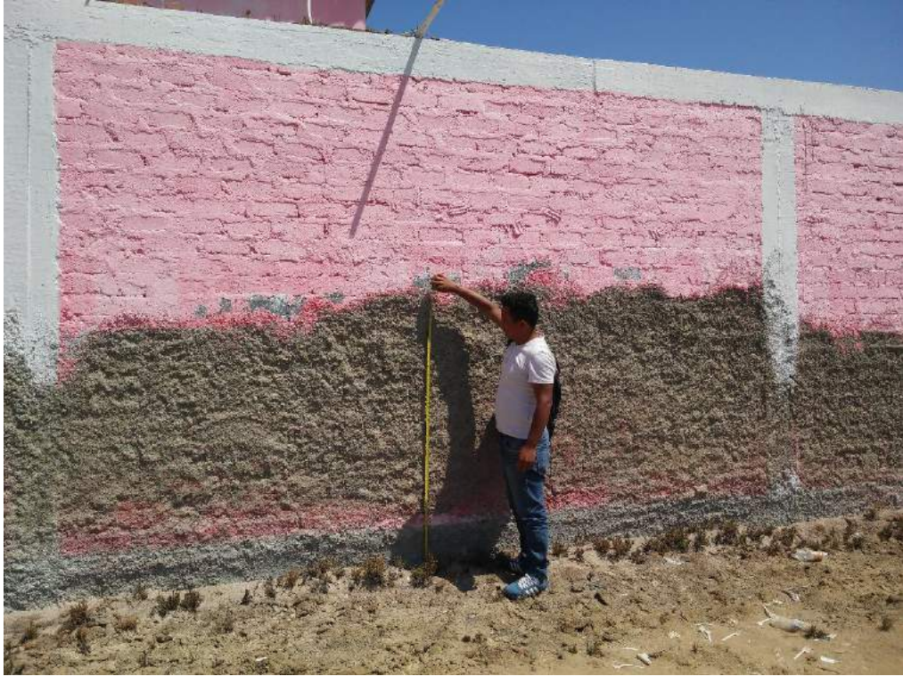
Figura 111: Fotografía donde se observa la patología de Eflorescencia
