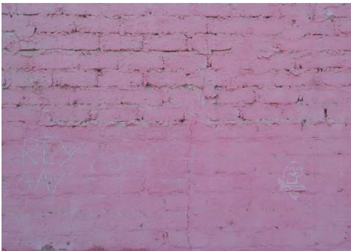
Figura 120: Fotografía donde se observa la patología de Grietas
