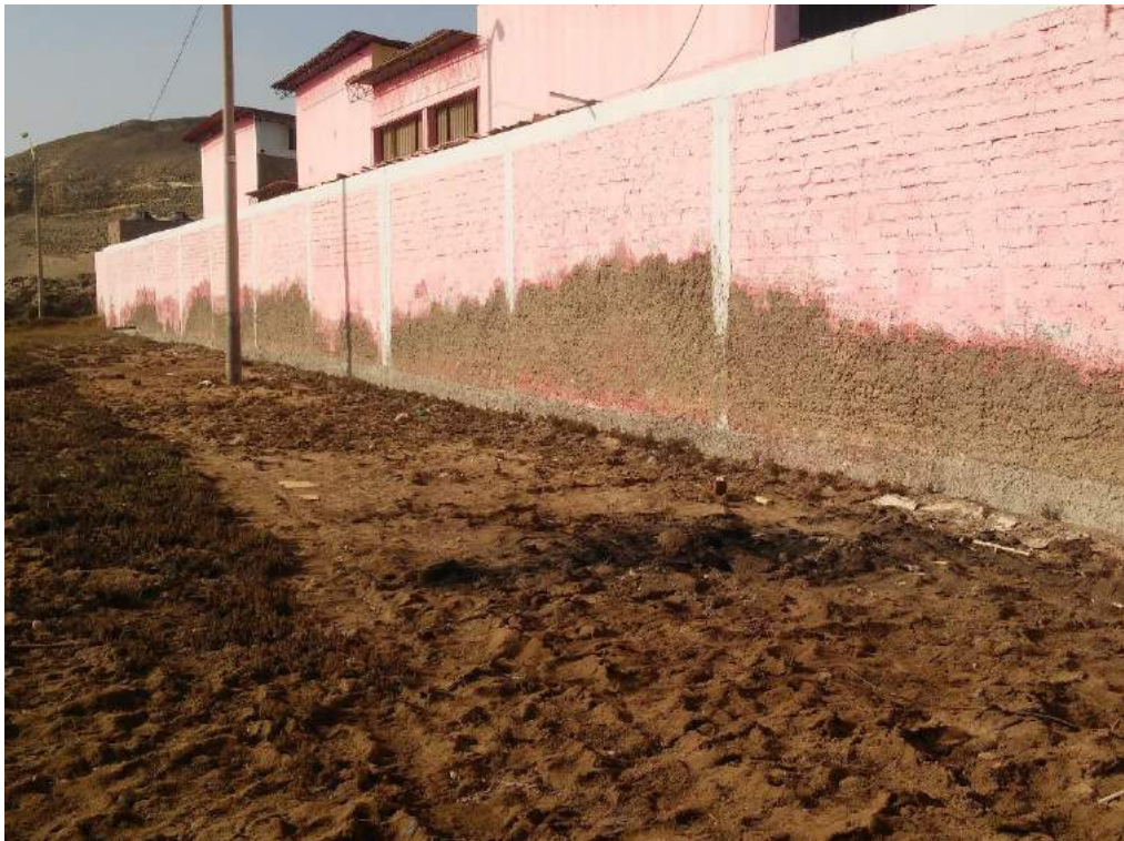
Figura 112: Fotografía donde se observa el suelo de la zona con sales - Eflorescencia
