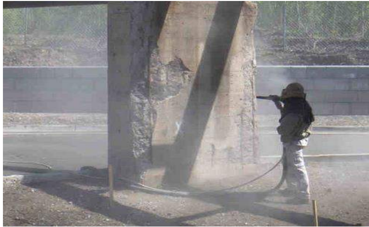
Figura 11. Imagen de delaminación
