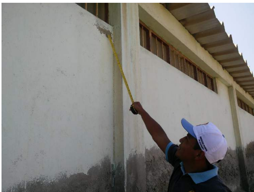
Figura 100: Fotografía donde se observa la patología de Delaminación
