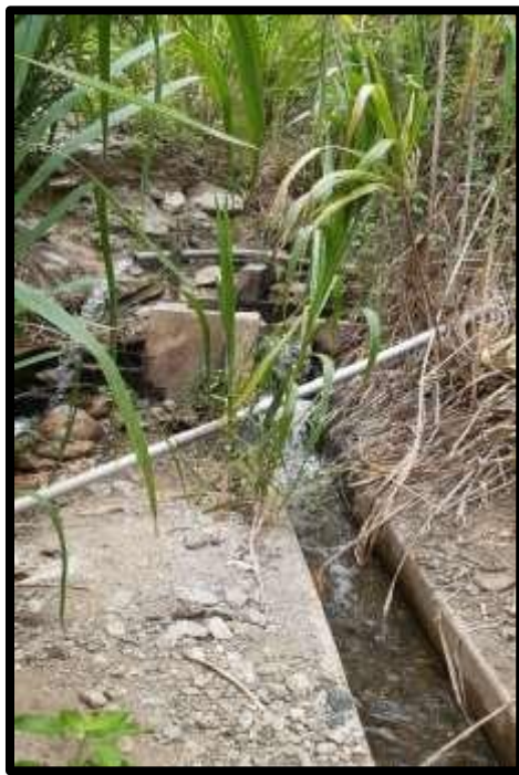
Fotografía 08. Vista de la línea de conducción expuesta a la intemperie.
