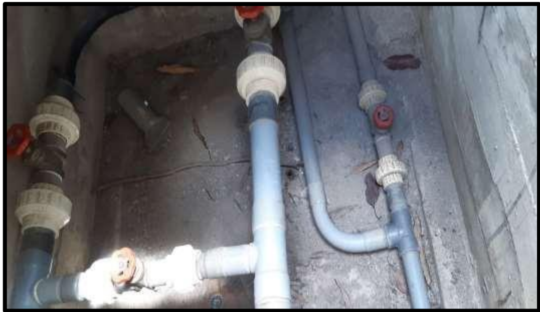
Fotografía 12. Vista interior de la caseta de válvulas.
