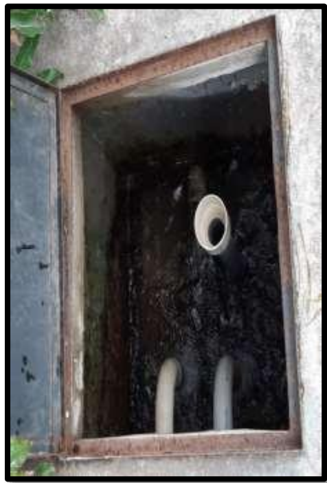
Fotografía 10. Vista interior de la CRP – 06.
