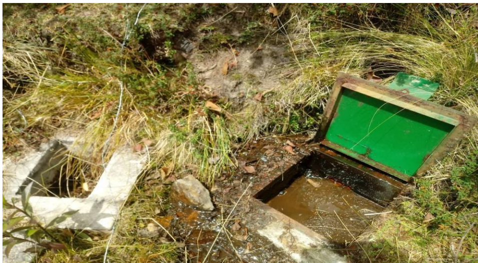
Imagen 17. Cámara de captación se encuentra en mal estado
