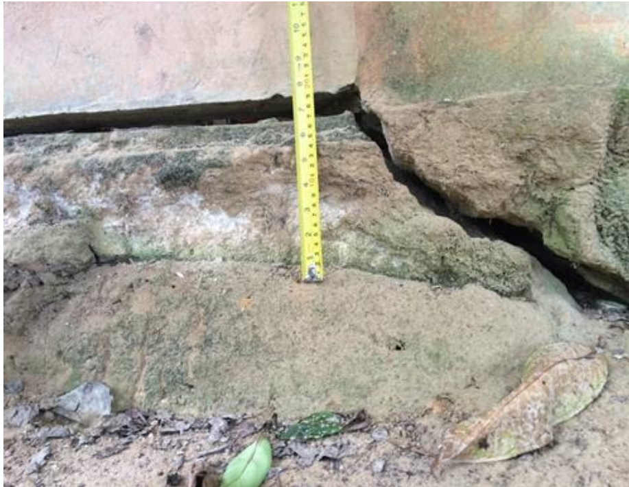
Fotografía 03: Grieta y erosión
