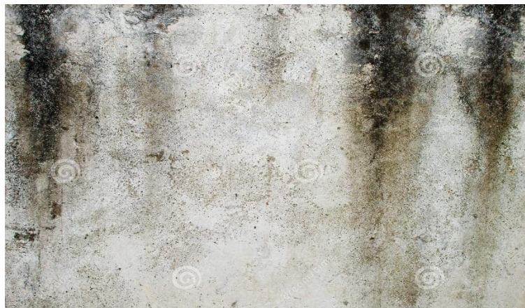
Figura 13. Imagen de suciedad en paredes
