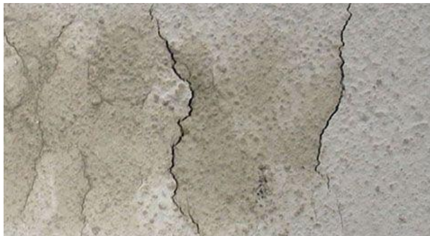
Figura 10. Imagen de fisuras en muros
