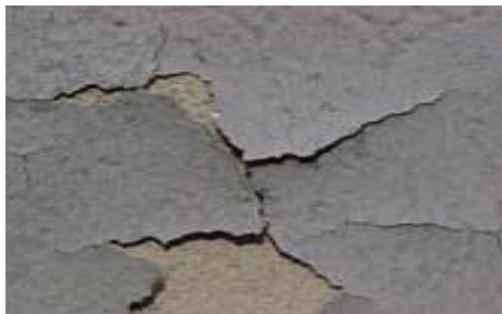
Figura 08. Imagen de Descascaramiento del concreto.
