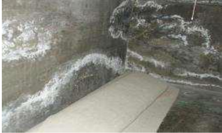
Figura 12. Imagen de eflorescencia en las paredes.
