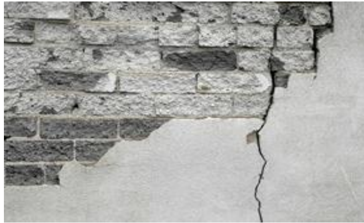
Figura 09. Imagen de grieta en muros
