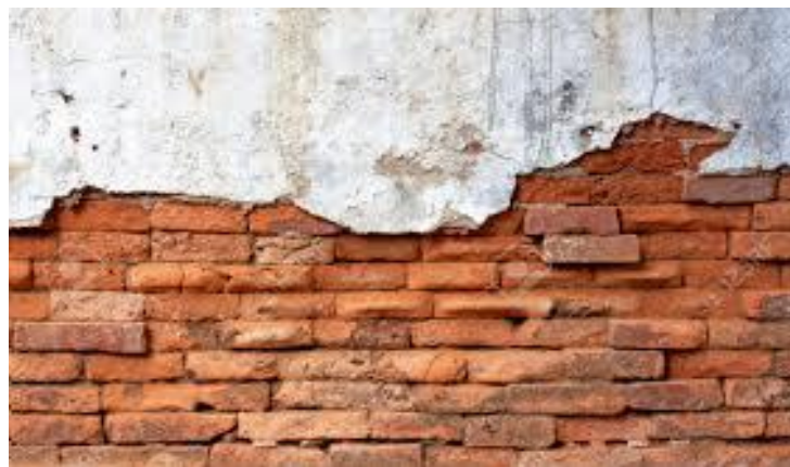
Figura 07. Imagen de erosión en los muros
