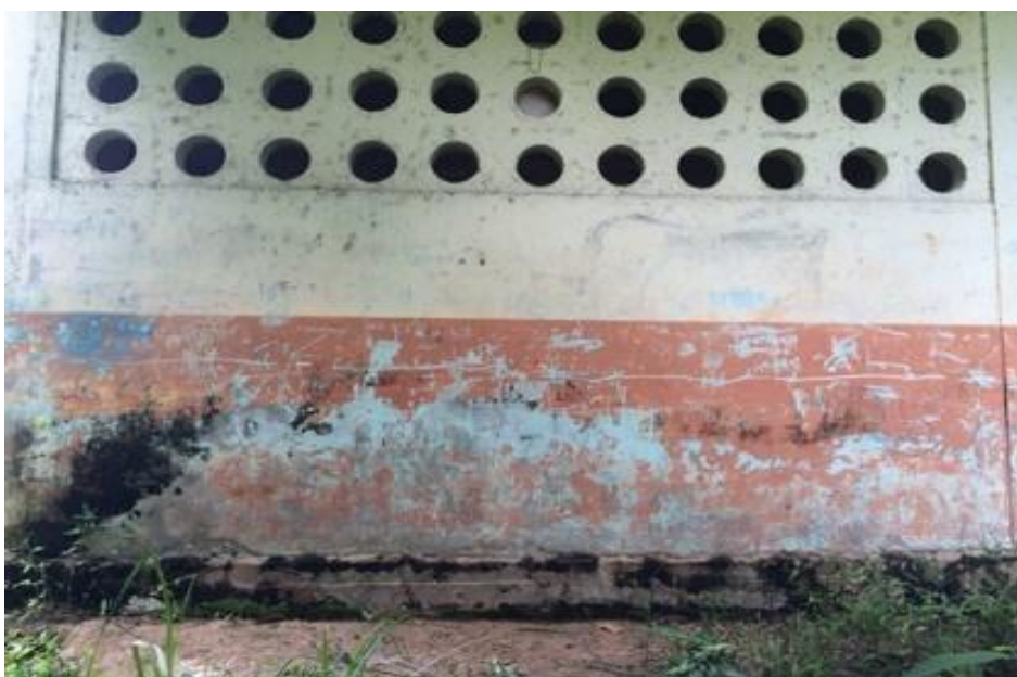
Fotografía 02: Humedad en muro de la Institución Educativa 601331
