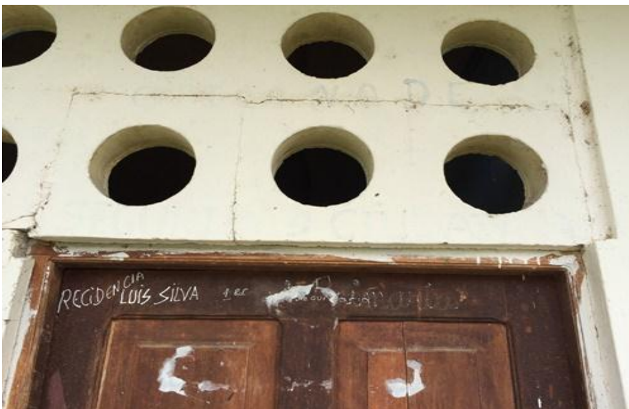
Fotografía 03: Fisura en muro
