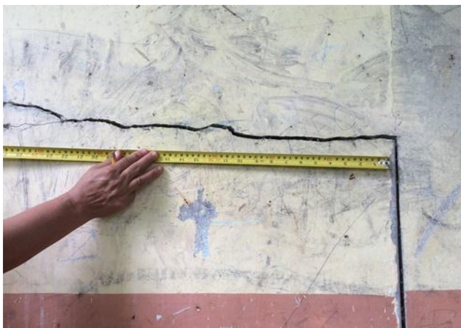
Fotografía 01: Grieta en muro de la Institución Educativa 601331
