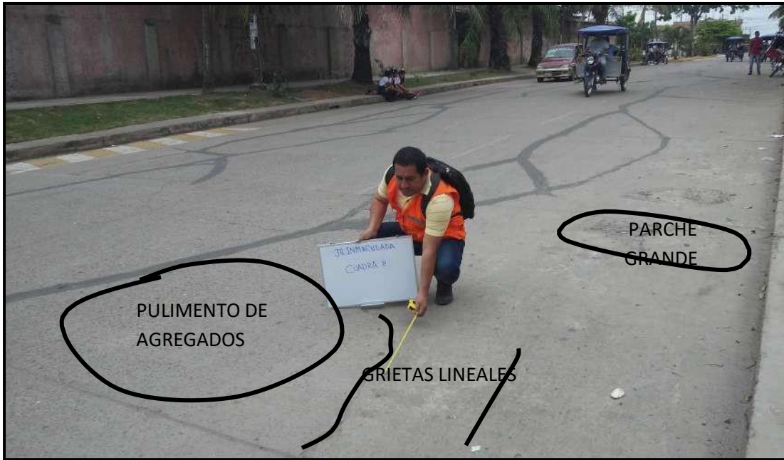
Figura 141: Vista de Patología en la cuadra 8 del Jr. Inmaculada.
