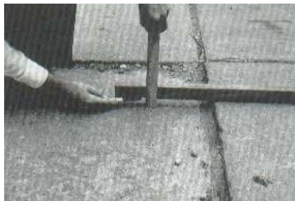
Figura 10: Escala de alta severidad.
