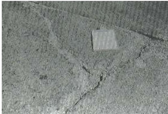
Figura 7: Grieta de esquina de alta severidad.
