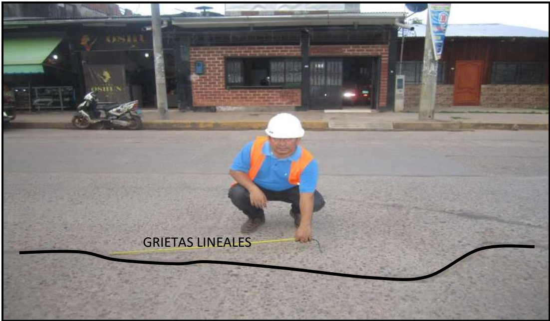
Figura 131: Vista de Patología en la cuadra 3 del Jr. Inmaculada.
