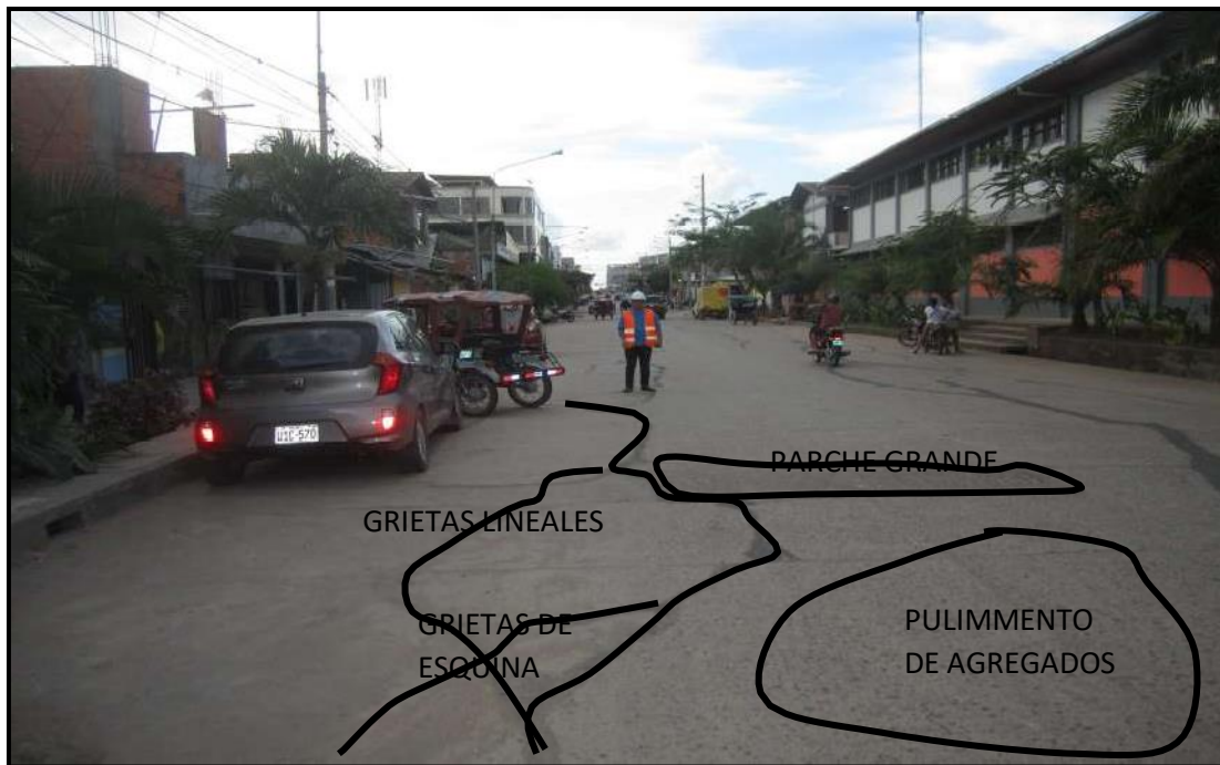
Figura 136: Vista de Patología en la cuadra 5 del Jr. Inmaculada.
