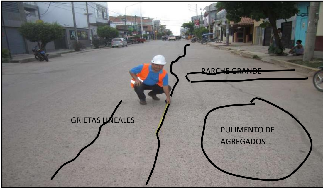
Figura 135: Vista de Patología en la cuadra 5 del Jr. Inmaculada.
