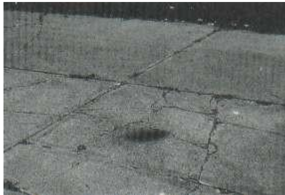
Figura 8: Losa dividida de alta severidad.
