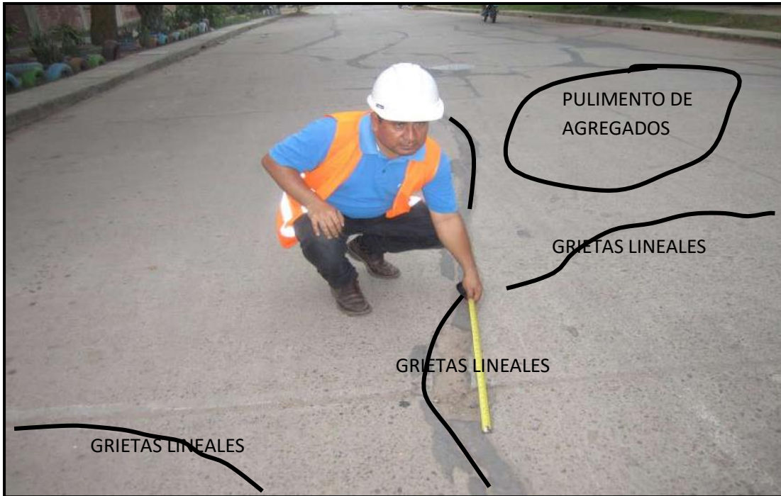
Figura 139: Vista de Patología en la cuadra 7 del Jr. Inmaculada.
