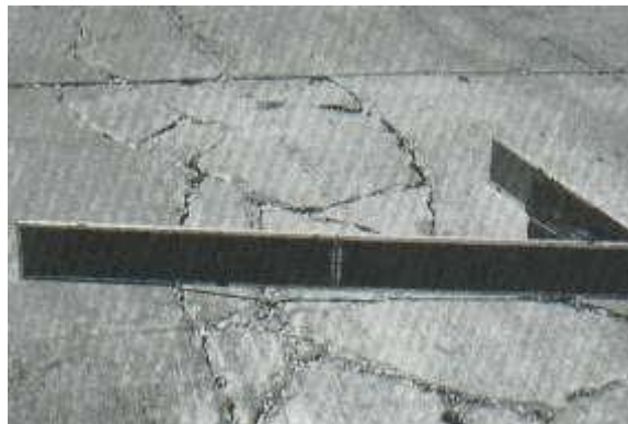
Figura 19: Punzonamiento de alta severidad.
