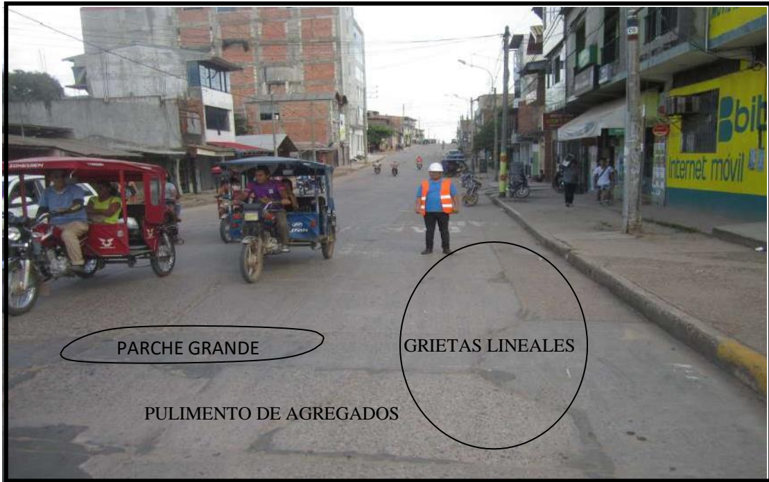
Figura 127: Vista de Patología en la cuadra 1 del Jr. Inmaculada.
