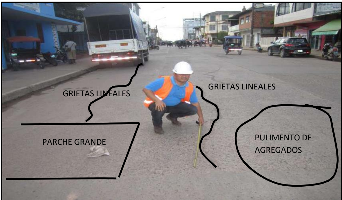
Figura 132: Vista de Patología en la cuadra 3 del Jr. Inmaculada.
