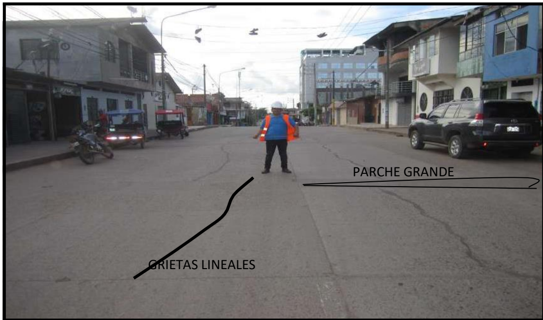
Figura 130: Vista de Patología en la cuadra 2 del Jr. Inmaculada.
