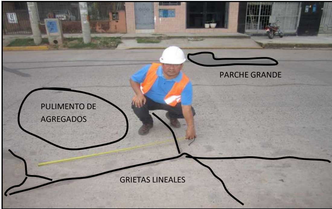
Figura 133: Vista de Patología en la cuadra 4 del Jr. Inmaculada.
