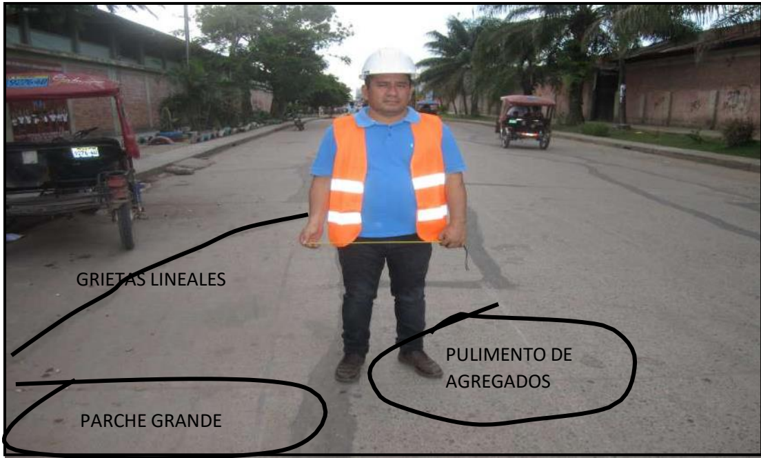
Figura 137: Vista de Patología en la cuadra 6 del Jr. Inmaculada.
