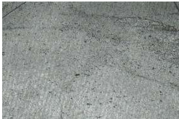
Figura 9: Grieta de durabilidad de alta severidad.
