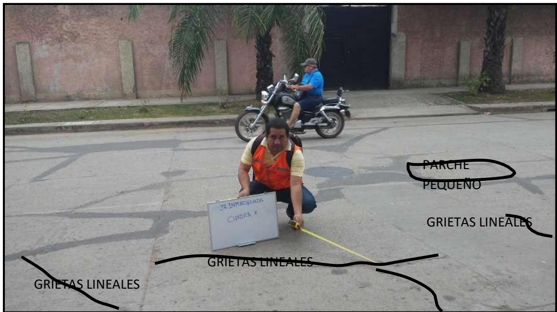
Figura 142: Vista de Patología en la cuadra 8 del Jr. Inmaculada.
