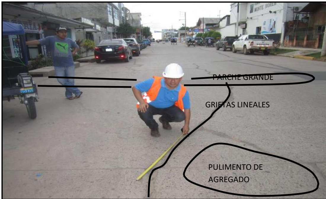
Figura 134: Vista de Patología en la cuadra 4 del Jr. Inmaculada.
