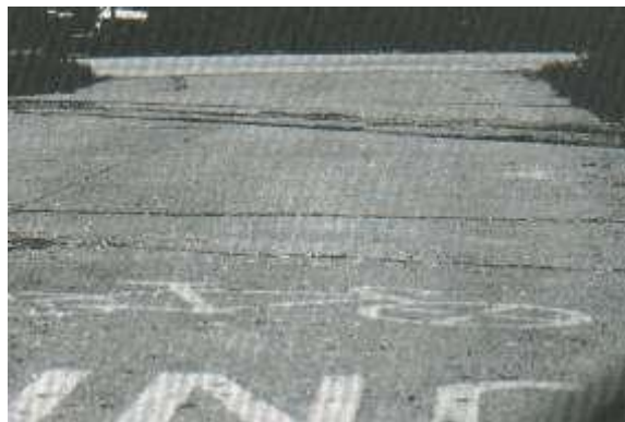
Figura 20: Cruce de vía férrea de severidad media.
