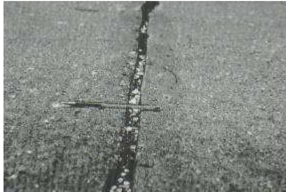
Figura 11: Daño del sello de junta de alta severidad.
