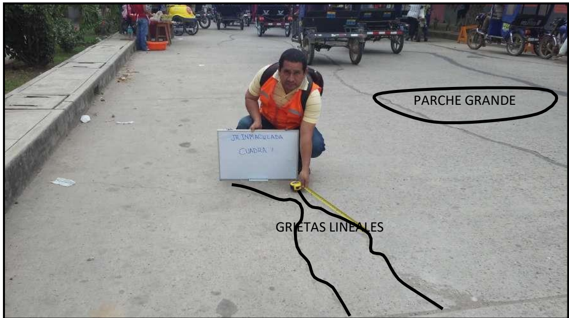
Figura 140: Vista de Patología en la cuadra 7 del Jr. Inmaculada.
