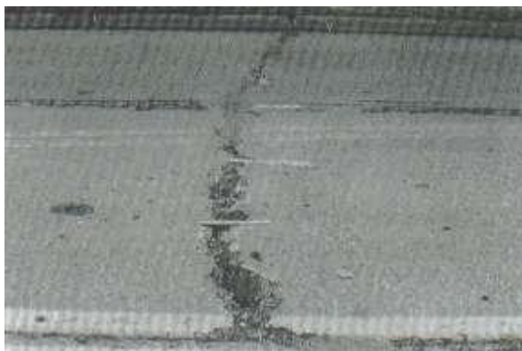
Figura 13: Grietas lineales de alta severidad en losa de concreto simple
