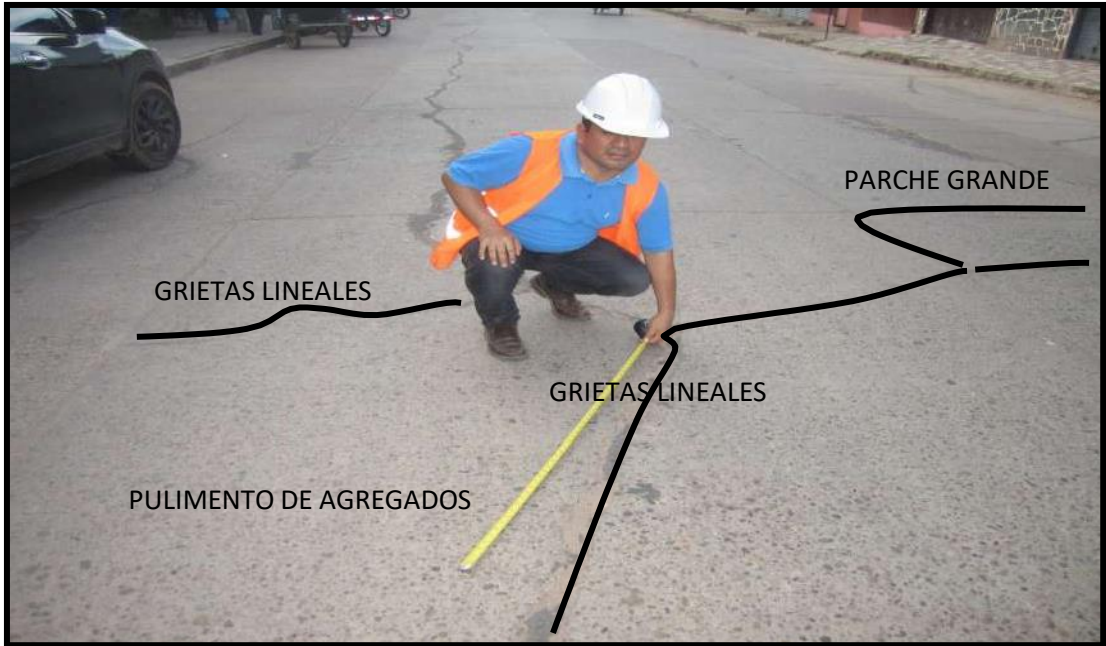
Figura 129: Vista de Patología en la cuadra 2 del Jr. Inmaculada.
