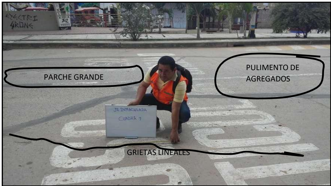
Figura 144: Vista de Patología en la cuadra 9 del Jr. Inmaculada
