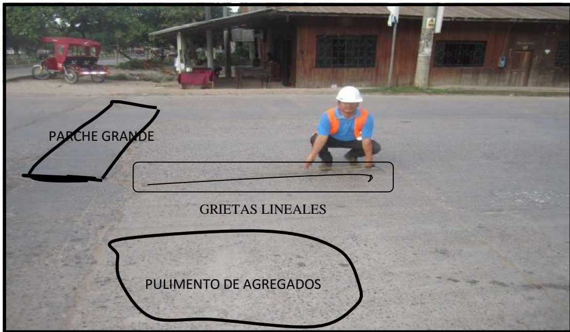
Figura 128: Vista de Patología en la cuadra 1 del Jr. Inmaculada.
