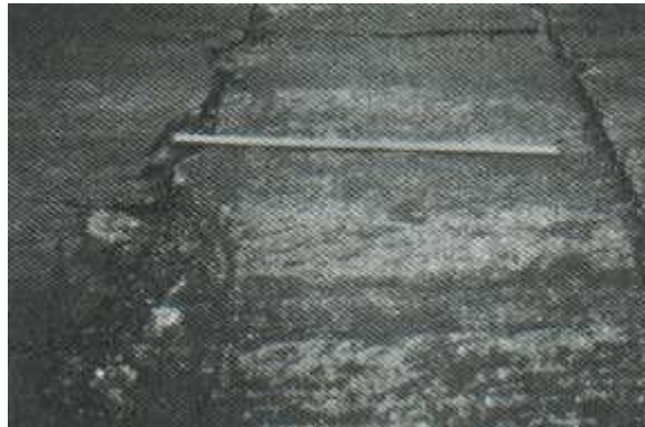
Figura 14: Parche grande y acometidas de servicios públicos de alta severidad
