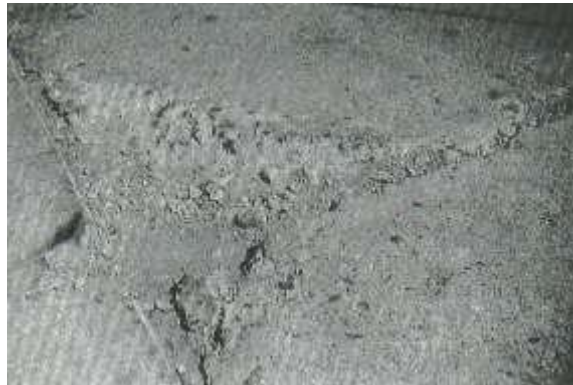
Figura 23: Descascaramiento de esquina de alta severidad.
