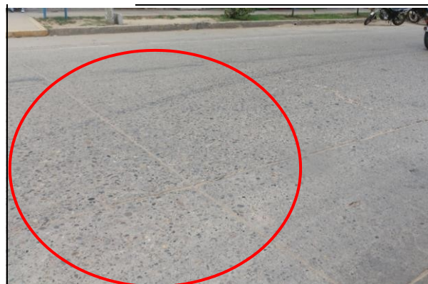
Figura 34. Patología de pulimento de agregados sin severidad, cuadra 1 del Jr. Ucayali, distrito de Calleria.
