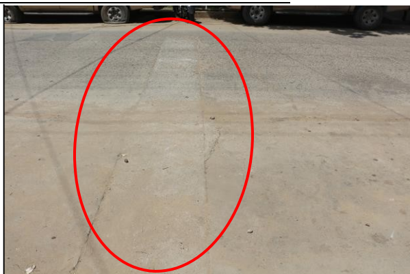
Figura 61. Patología de parche grande con nivel de severidad baja, en la cuadra 8 del Jr. Ucayali, distrito de Callería.
