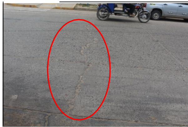
Figura 32. Patología de grieta lineal con nivel de severidad media; en la cuadra 1 del Jr. Ucayali, distrito de Calleria.
