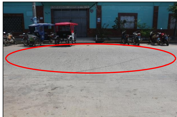
Figura 58. Patología de pulimento de agregados sin severidad, en la cuadra 7 del Jr. Ucayali, distrito de Callería.
