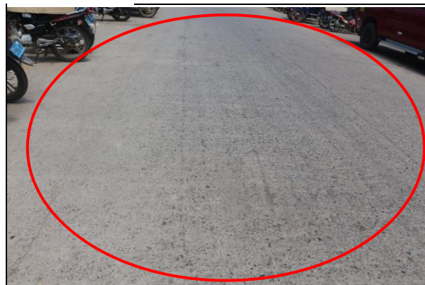
Figura 62. Patología de pulimento de agregados sin severidad, en la cuadra 8 del Jr. Ucayali, distrito de Callería.
