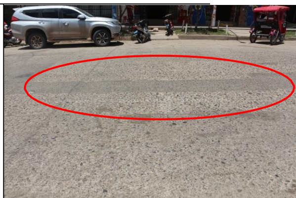
Figura 41. Patología de parche grande con nivel de severidad baja; en la cuadra 3 del Jr. Ucayali, distrito de Callería.
