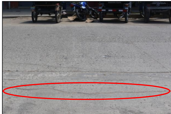
Figura 56. Patología de grieta lineal con nivel de severidad baja; en la cuadra 7 del Jr. Ucayali, distrito de Callería.
