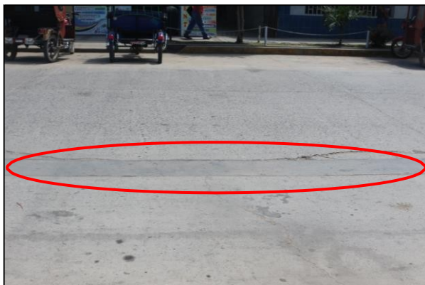
Figura 57. Patología de parche grande con nivel de severidad baja en la cuadra 7 del Jr. Ucayali, distrito de Callería.
