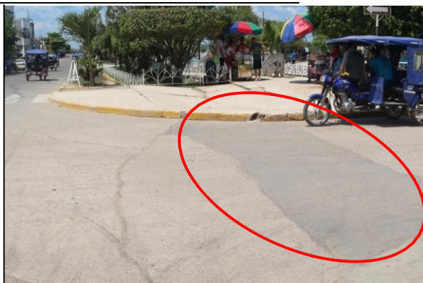
Figura 65. Patología de parche grande con nivel de severidad baja, en la cuadra 8 del Jr. Ucayali, distrito de Callería.
