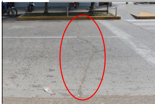
Figura 60. Patología de grieta lineal con nivel de severidad media; en la cuadra 8 del Jr. Ucayali, distrito de Callería.
