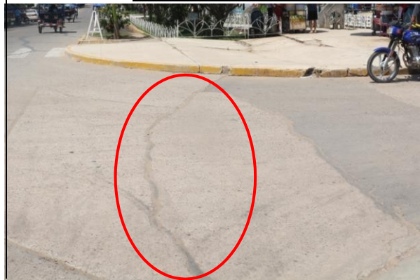
Figura 64. Patología de grieta lineal con nivel de severidad media; en la cuadra 9 del Jr. Ucayali, distrito de Callería.
