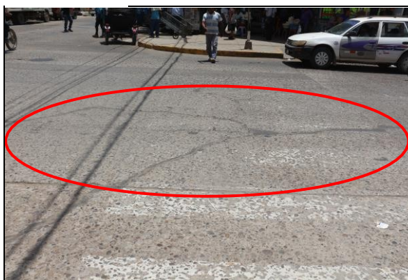
Figura 40. Patología de grieta lineal con nivel de severidad baja; en la cuadra 3 del Jr. Ucayali, distrito de Callería.
