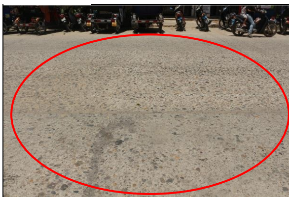
Figura 42. Patología de pulimento de agregados sin severidad, en la cuadra 3 del Jr. Ucayali, distrito de Callería.
