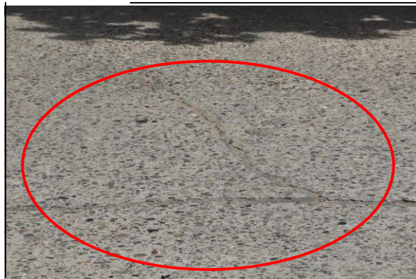
Figura 52. Patología de grieta lineal con nivel de severidad media; en la cuadra 6 del Jr. Ucayali, distrito de Callería.
