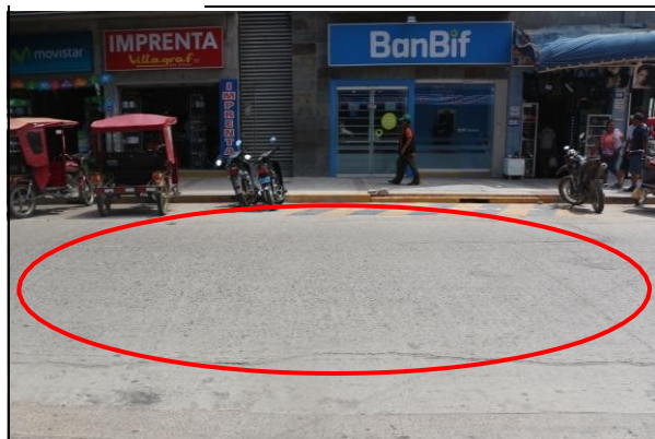
Figura 54. Patología de pulimento de agregados sin severidad, en la cuadra 6 del Jr. Ucayali, distrito de Callería.
