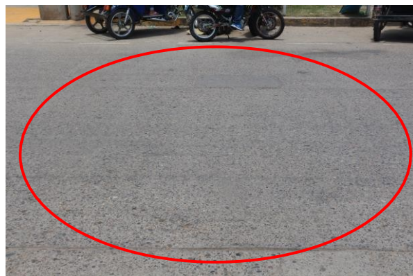
Figura 50. Patología de pulimento de agregados sin severidad, en la cuadra 5 del Jr. Ucayali, distrito de Calleria.
