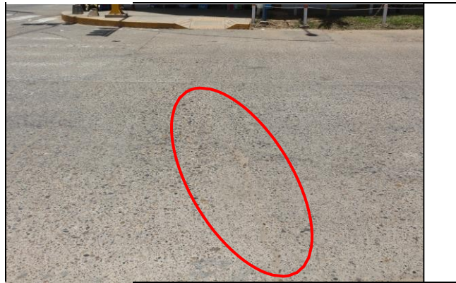
Figura 48. Patología de grieta lineal con nivel de severidad baja; en la cuadra 5 del Jr. Ucayali, distrito de Calleria.
