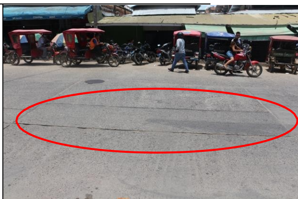
Figura 45. Patología de parche grande con nivel de severidad baja; en la cuadra 4 del Jr. Ucayali, distrito de Calleria.
