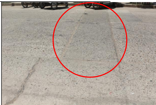
Figura 37. Patología de parche grande, con nivel de severidad baja; en la cuadra 2 del Jr. Ucayali, distrito de Callería.
