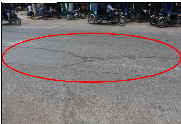
Figura 44. Patología de grieta lineal con nivel de severidad media; en la cuadra 4 del Jr. Ucayali, distrito de Calleria.
