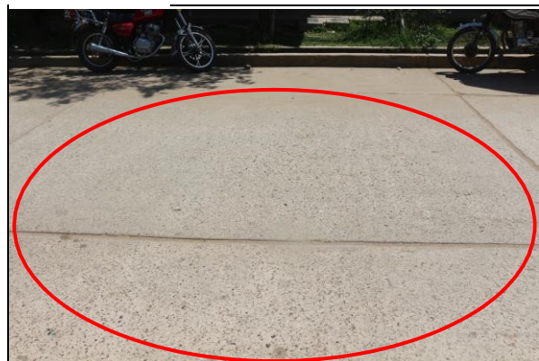
Figura 66. Patología de pulimento de agregados sin severidad, en la cuadra 9 del Jr. Ucayali, distrito de Callería.
