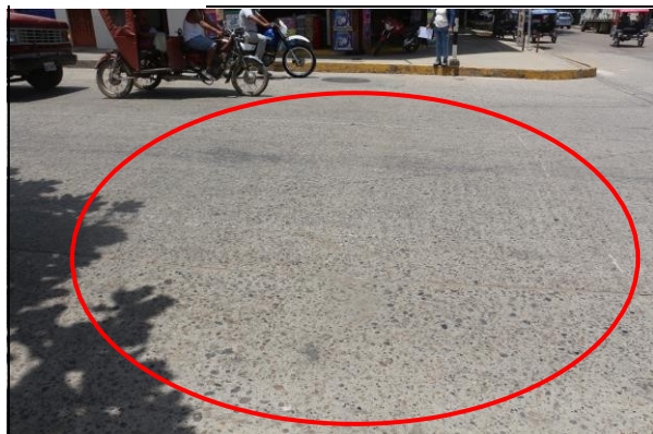
Figura 38. Patología de pulimento de agregados; sin severidad, en la cuadra 2 del Jr. Ucayali, distrito de Callería.
