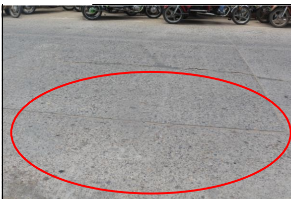
Figura 46. Patología de pulimento de agregados sin severidad, en la cuadra 4 del Jr. Ucayali, distrito de Calleria.
