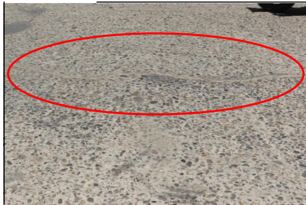
Figura 36. Patología de grieta lineal con nivel de severidad media; en la cuadra 2 del Jr. Ucayali, distrito de Callería.
