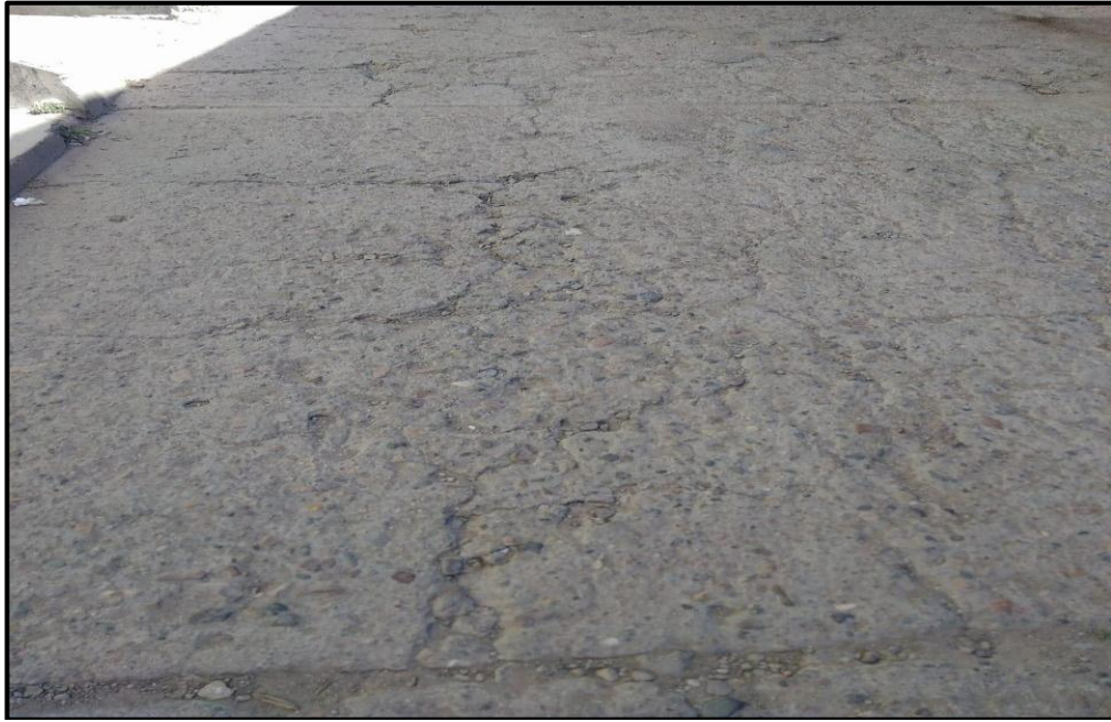
Figura 7. Descascaramiento de Junta, pulimiento de agregado y grieta transversal Fuente: propia 2018
