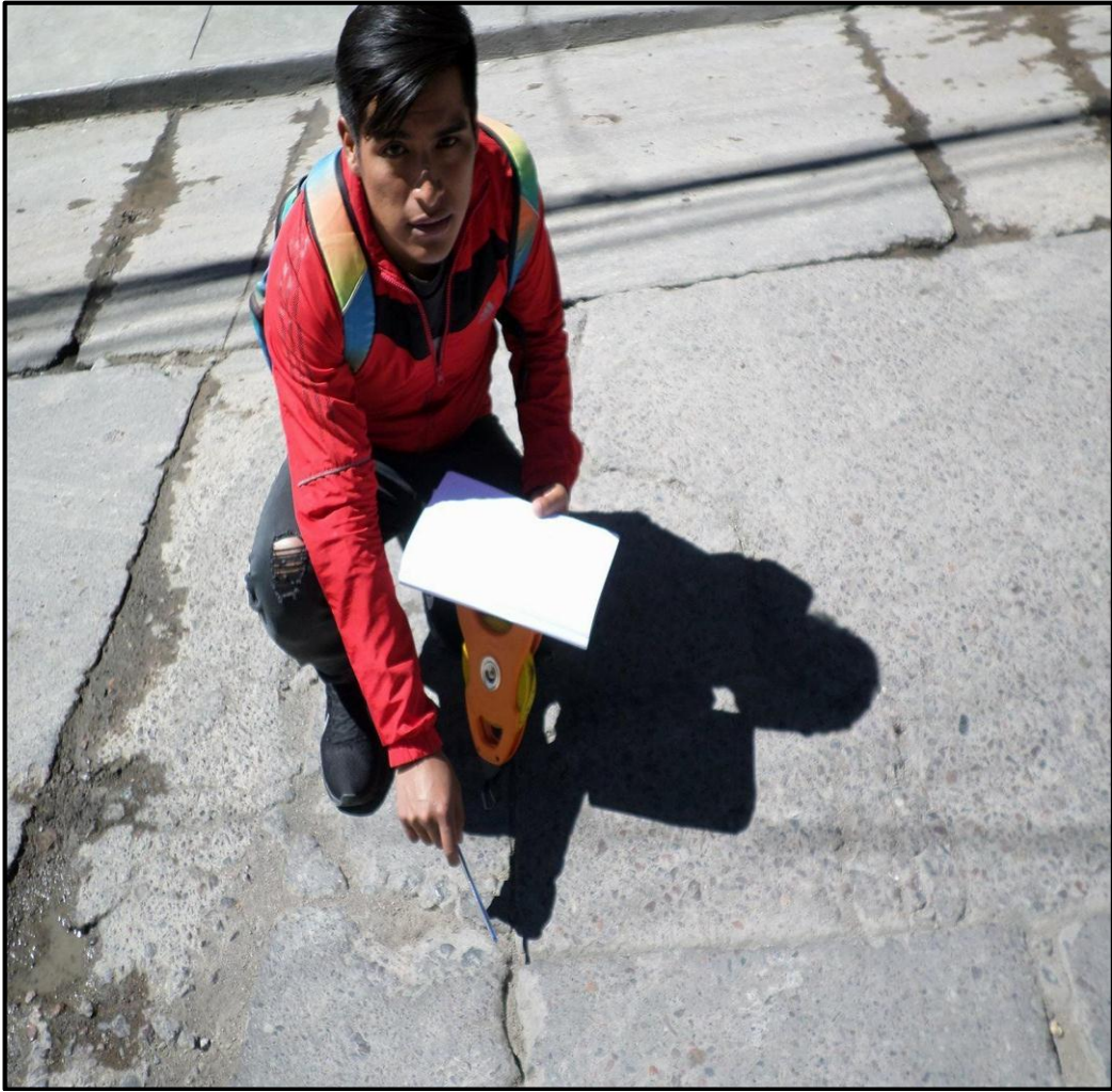
Figura 9. Escala, Parche grande, pulimiento de agregado y descacaramiento de junta Fuente: propia 2018
