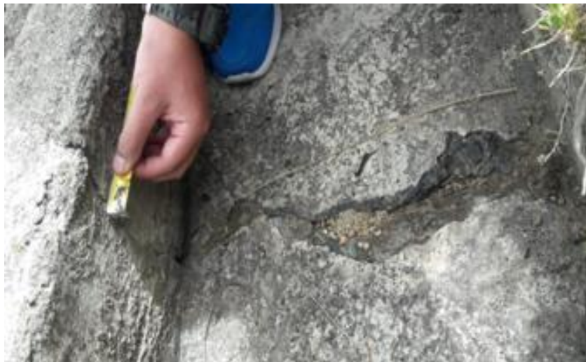
Fotografía 6. Vista de patologías en el canal de riego
