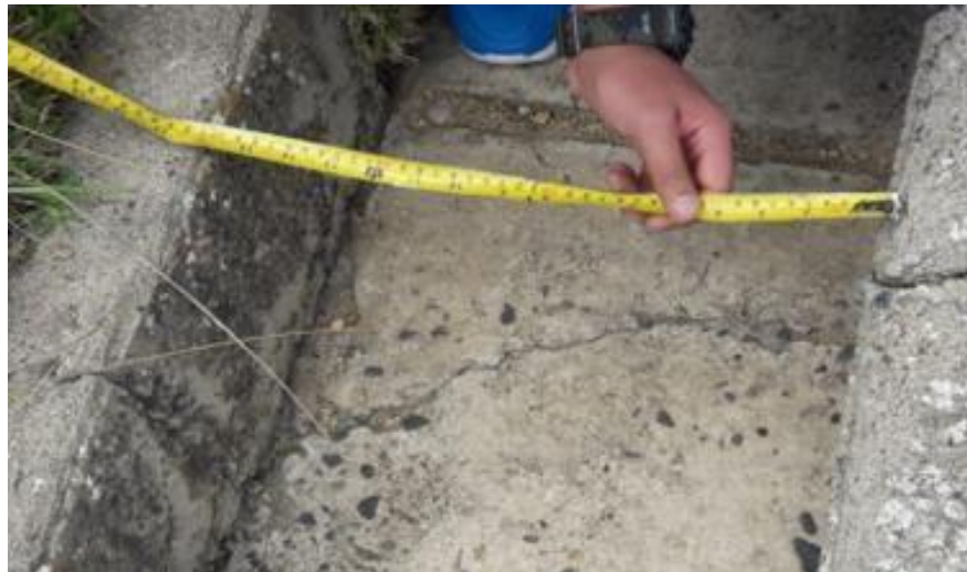
Fotografía 4. Vista de patologías en el canal de riego
