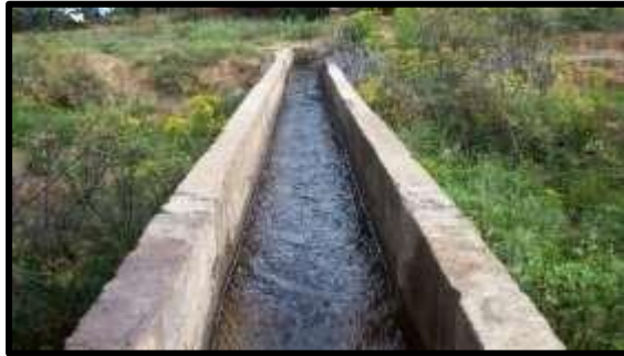
Figura 1. Canal de riego-rectangular
