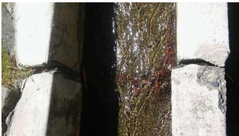
Imagen 6. Patologías de sello de junta en el canal de riego.
