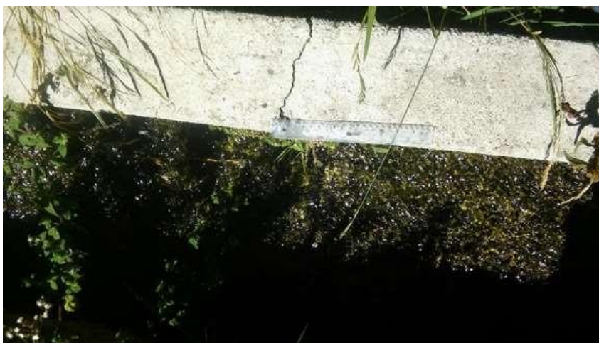
Imagen 3. Patologías de grietas en el canal de riego.
