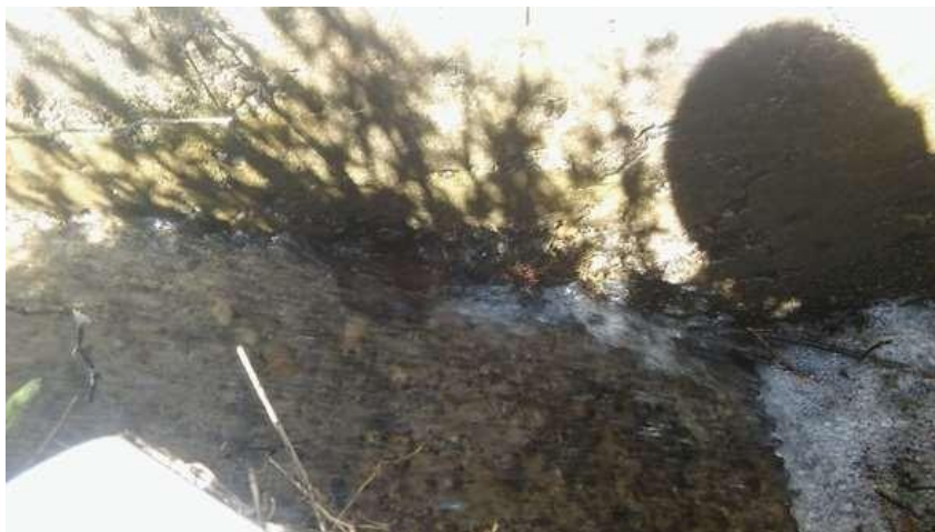
Imagen 2. Patología de erosión en el canal de riego.
