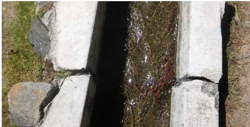
Imagen 5. Patologías de grietas en el canal de riego.
