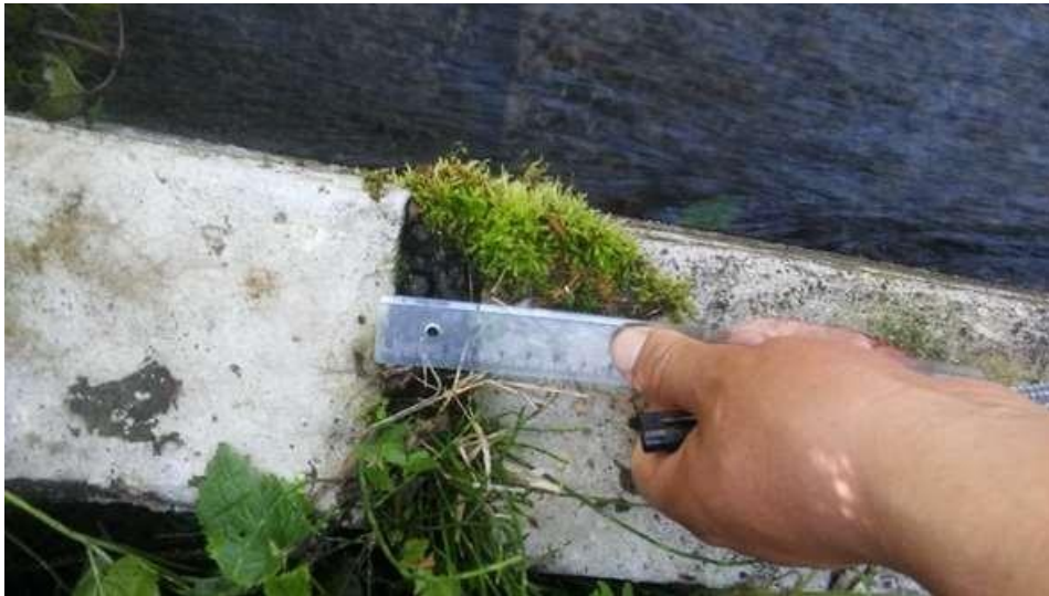
Imagen 4. Patologías de vegetación en el canal de riego.
