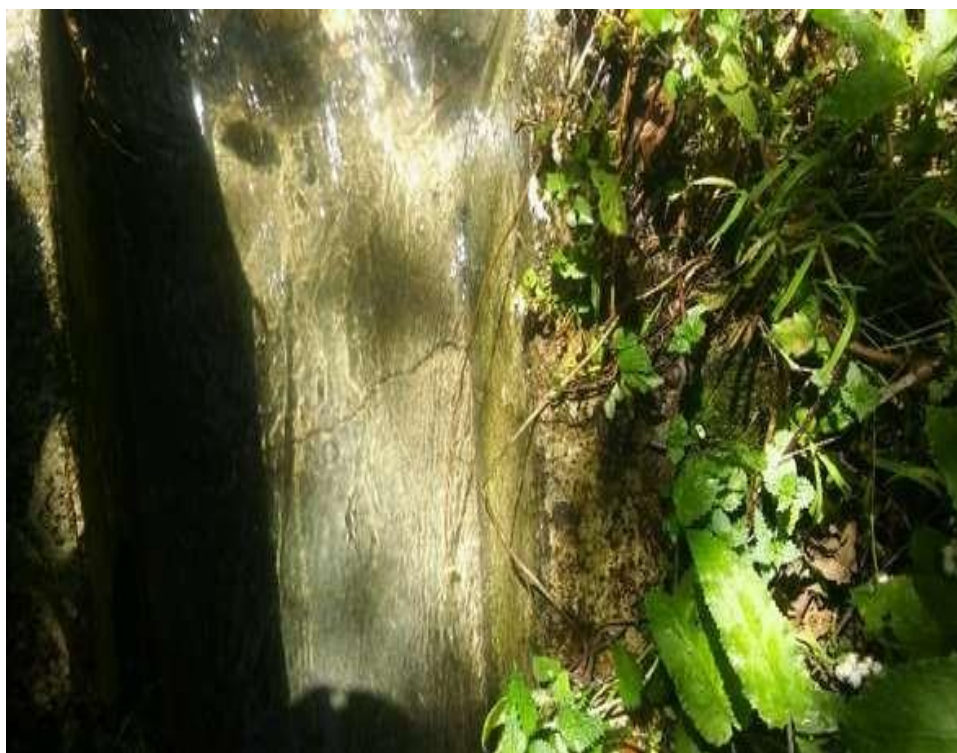
Imagen 8. Patologías de fisura en el canal de riego - tramo 6
