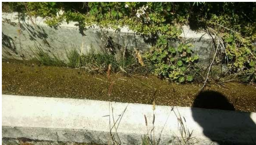
Imagen 1. Patología de vegetación en el canal de riego
