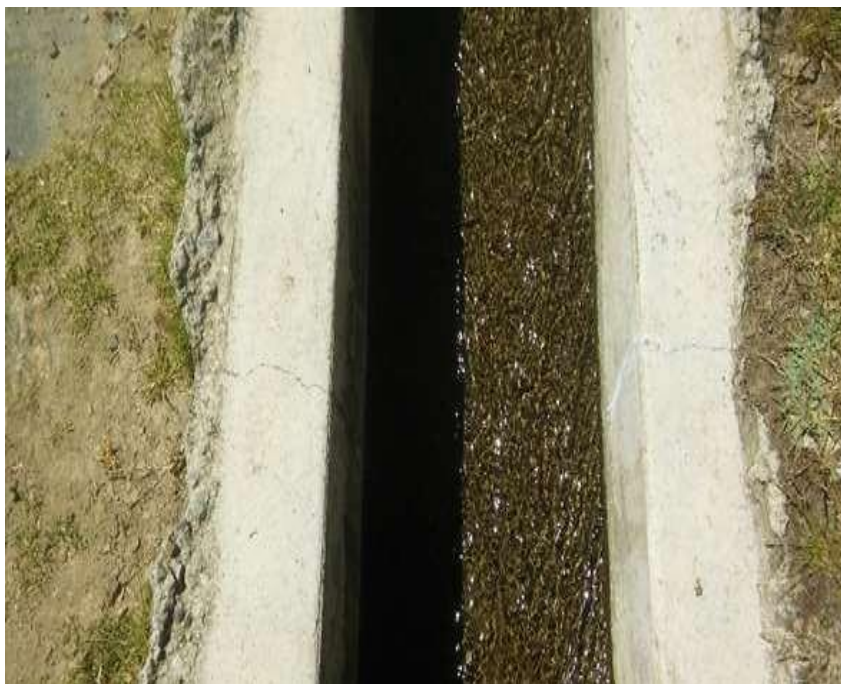
Imagen 7. Patologías de grietas en el canal de riego - tramo 5
