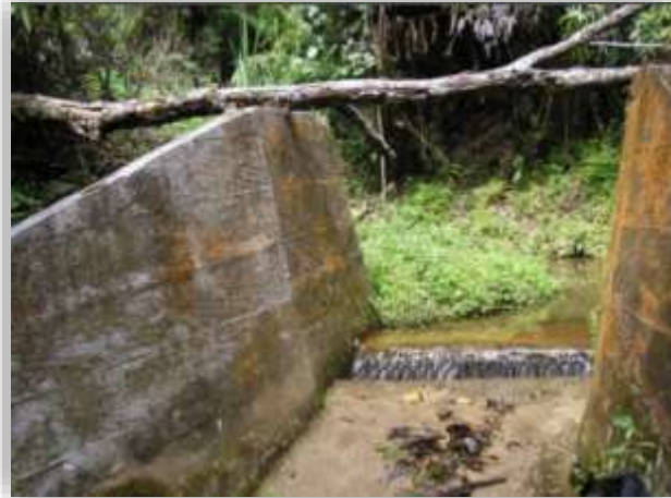
Gráfico 7: Captación de fondo Fuente: Hidráulicas Cautilling
