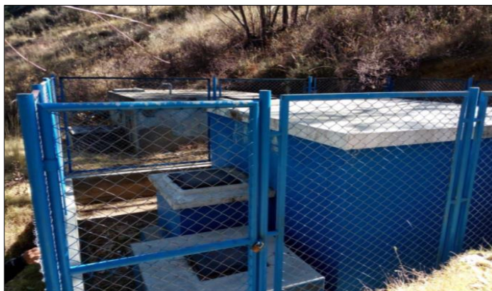
Imagen 04: Cámara de captación Fuente: Elaboración propia (2021)
