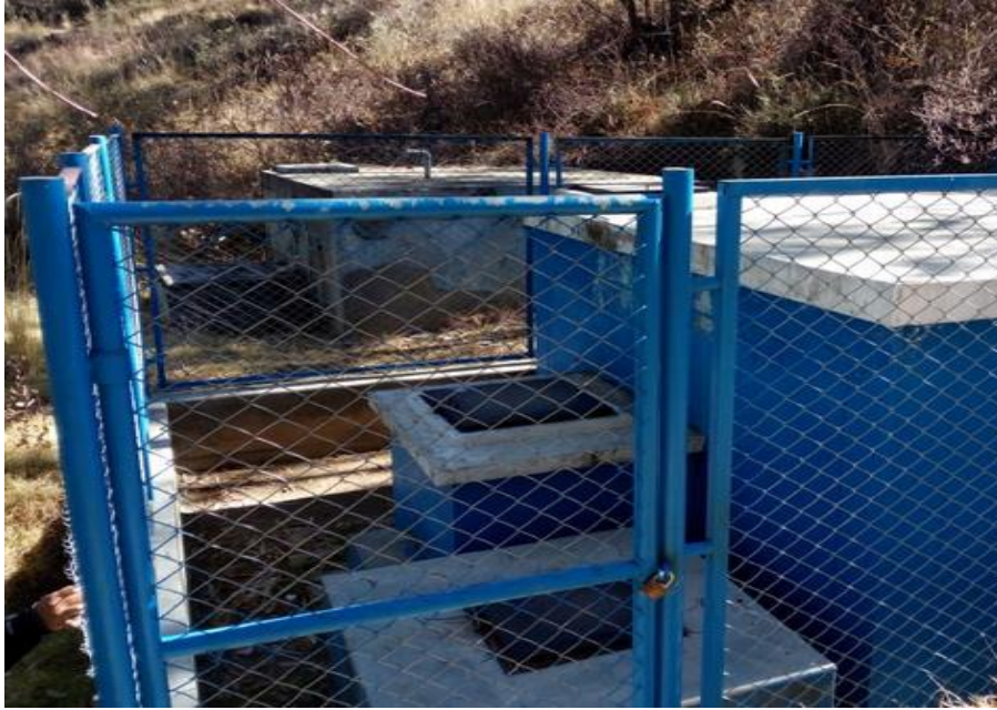
Imagen 03: Captación del sistema de abastecimiento de agua potable del caserío Caururo, distrito de Independencia, provincia de Huaraz, región Áncash – 2021.
