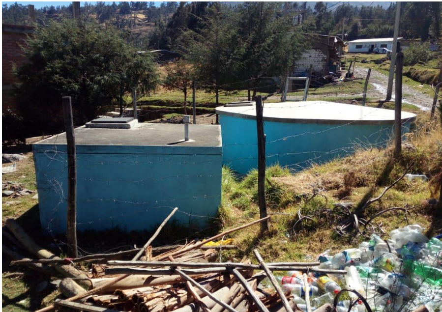
Imagen 04: Reservorio de almacenamiento del sistema de abastecimiento de agua potable del caserío Caururo, distrito de Independencia, provincia de Huaraz, región Áncash – 2021.
