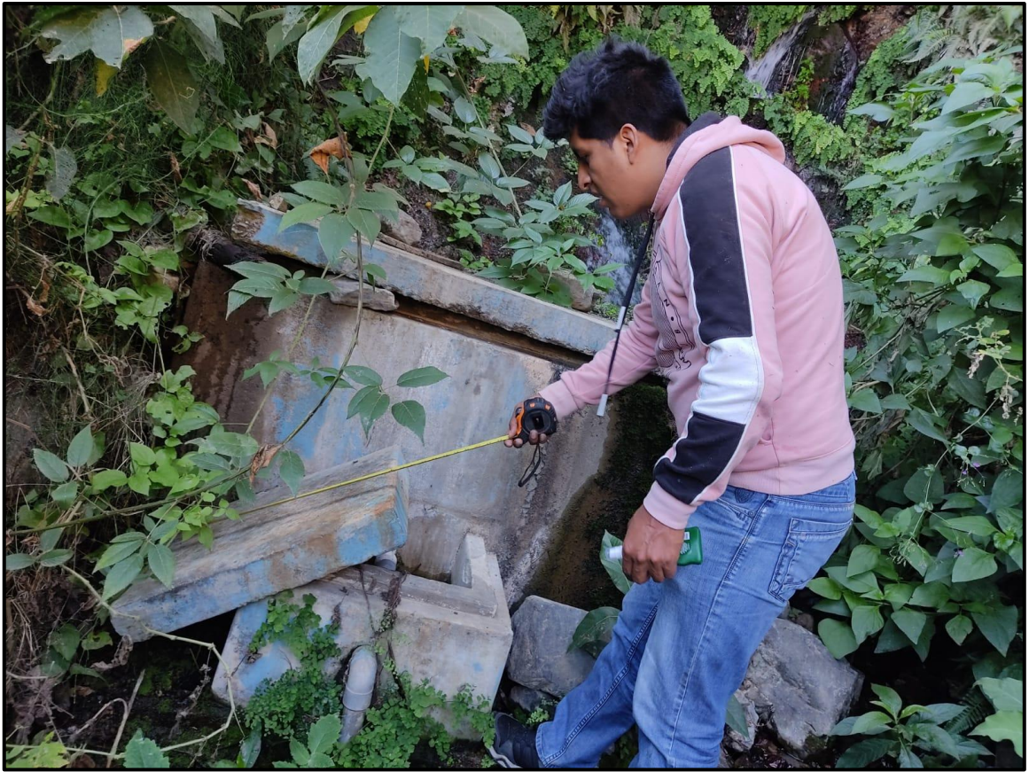
Fotografía 01: Verificación de la Captación, la cual se encuentra en estado de abandono
