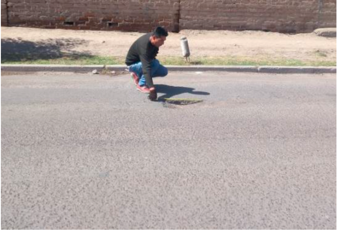
Fotografía 1: Vista de la Patología tipo Bache en la cuadra 5.
