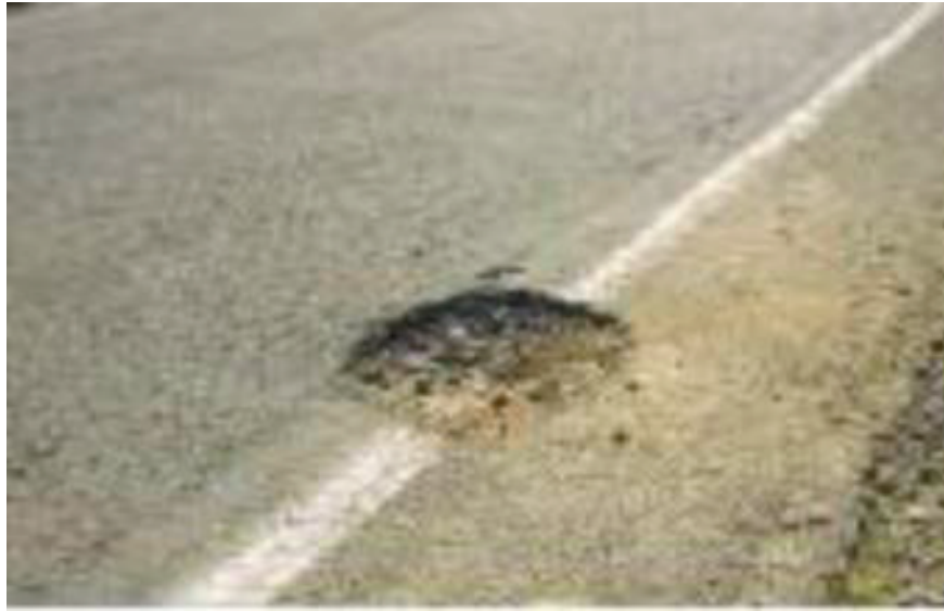
Figura 2.14: Patología tipo Baches.
