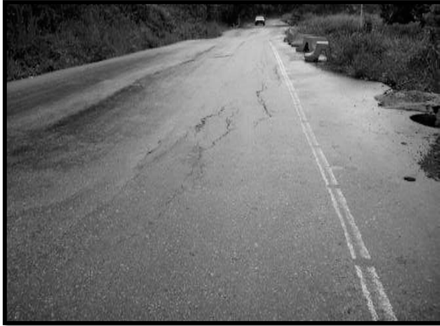
Figura 2.7: Patología tipo Grietas longitudinales.
