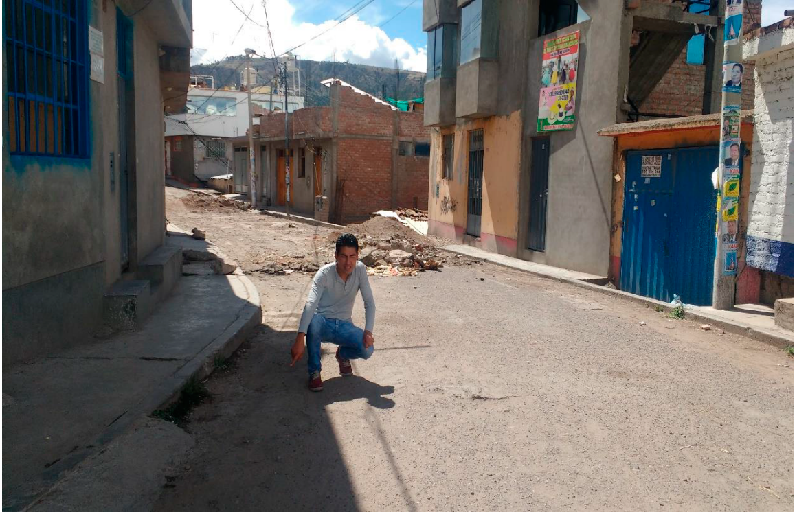
Fotografía 3: Vista de la Patología Parcheo, Bache y Desprendimiento de agregados cuadra 3.
