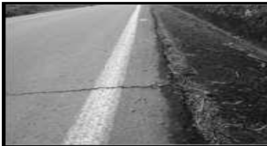
Figura 2.6: Patología tipo Grietas de borde.
