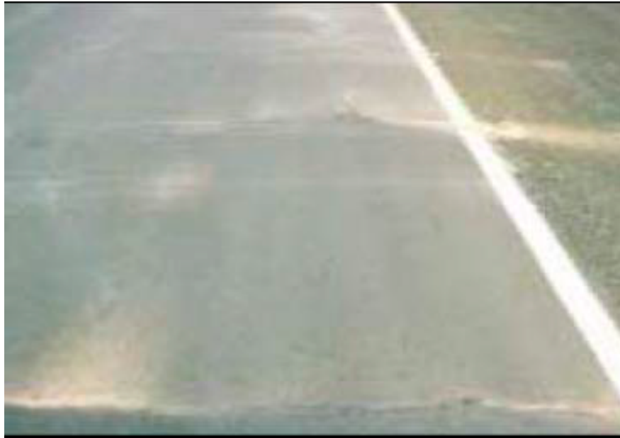
Figura 2.19: Patología tipo Afloramiento de finos.
