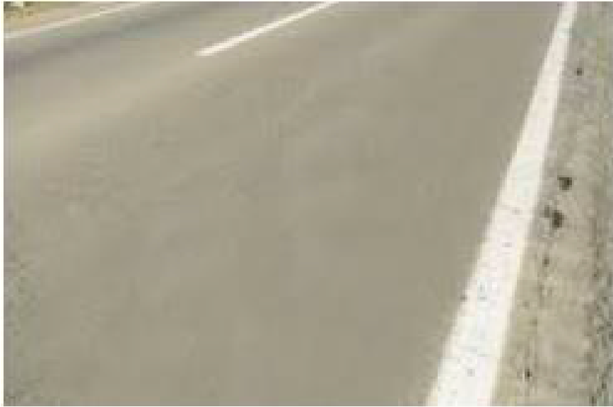
Figura 2.17: Patología tipo Desnivel de carril-berma.
