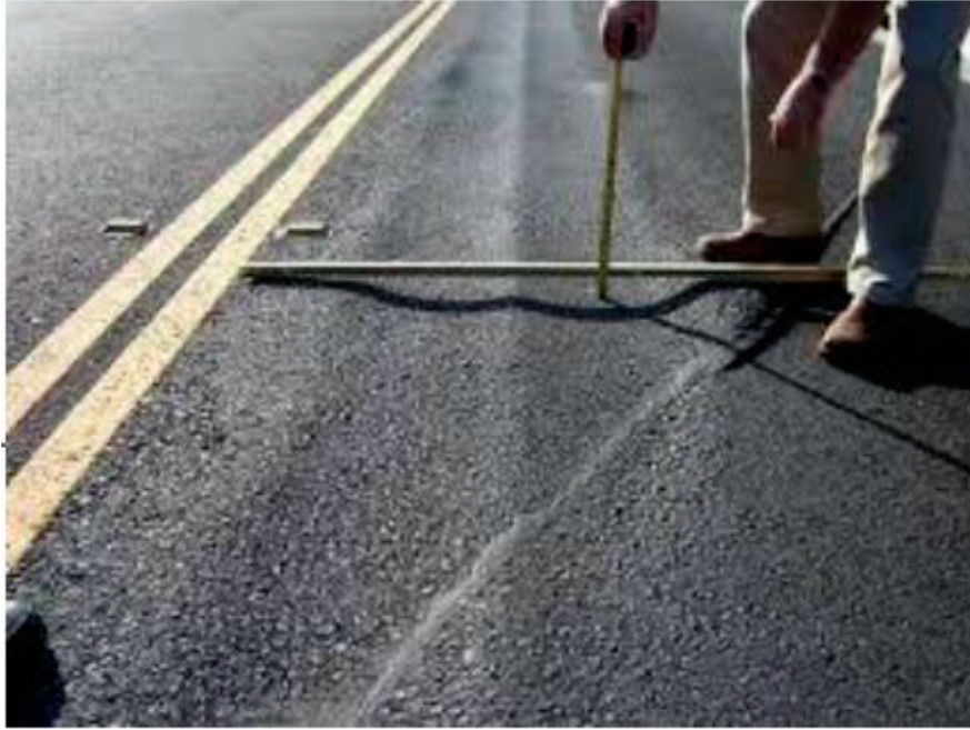
Figura 2.12: Patología tipo Ahuellamiento.
