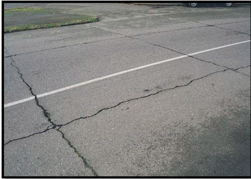
Figura 2.8: Patología tipo Fisura de reflexión de junta.
