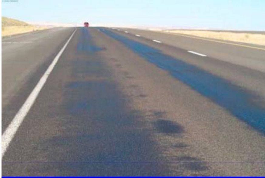
Figura 2.16: Patología tipo Exudación.
