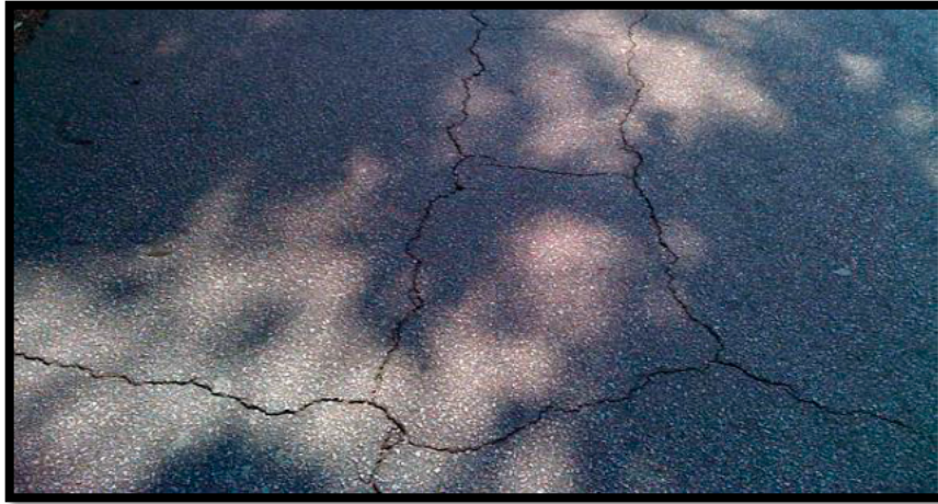
Figura 2.5: Patología tipo Grietas de borde.
