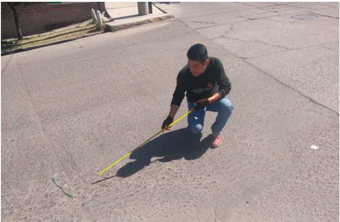
Fotografía 2: Vista de la Patología tipo Pulimiento de agregados cuadra 1.
