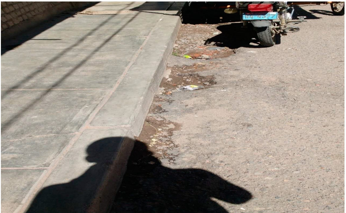
Fotografía 4: Vista de la Patología tipo Baches de borde por falta de cunetas cuadra 6.
