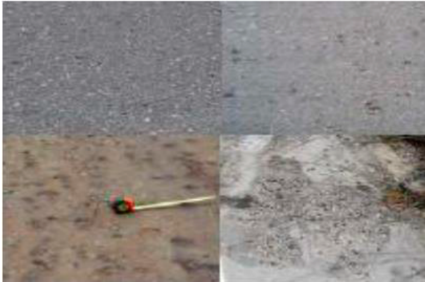
Figura 2.15: Patología tipo Desprendimiento de agregados.
