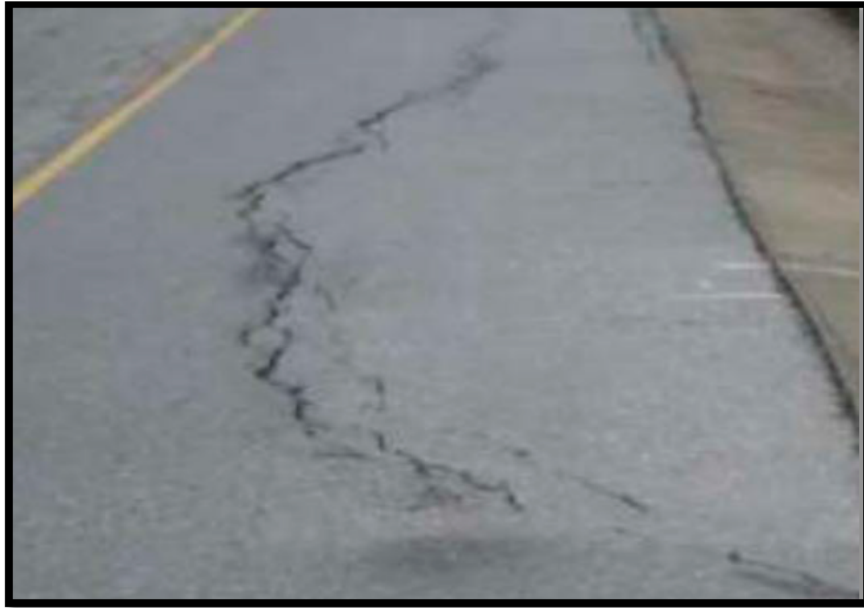
Figura 2.9: Patología tipo Fisuras parabólicas.
