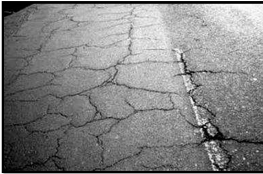
Figura 2.4: Patología tipo Piel de cocodrilo.
