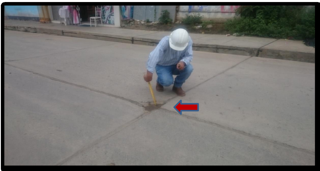
Figura 219. Fotografía con presencia, descascamiento de esquina, de nivel de severidad medio (38M), identificado en la unidad de muestra 02, del Jirón San Martín, cuadra 06.
