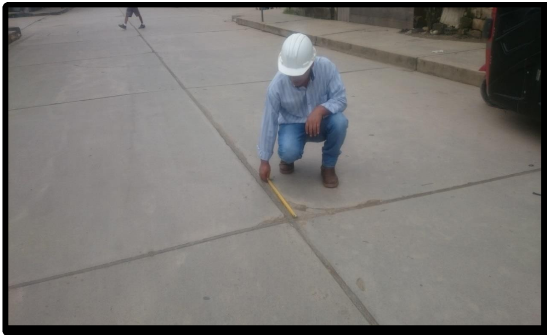
Figura 232. Fotografía con presencia, descascaramiento de esquina de nivel de severidad baja (38L), identificado en la unidad de muestra 05, del Jirón San Martín, cuadra 08.
