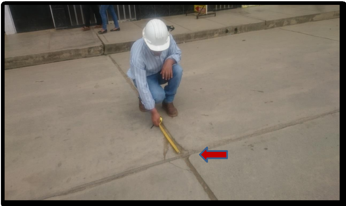
Figura 237. Fotografía con presencia, descascamiento de esquina de nivel de severidad baja (38L), identificado en la unidad de muestra 06, del Jirón San Martín, cuadra 08.
