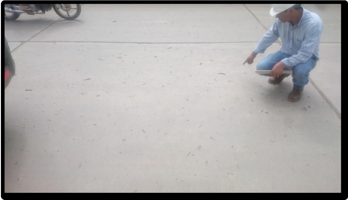
Figura 216. Fotografía con presencia, de popoust (32), identificado en la unidad de muestra 01, del Jirón San Martín, cuadra 06.
