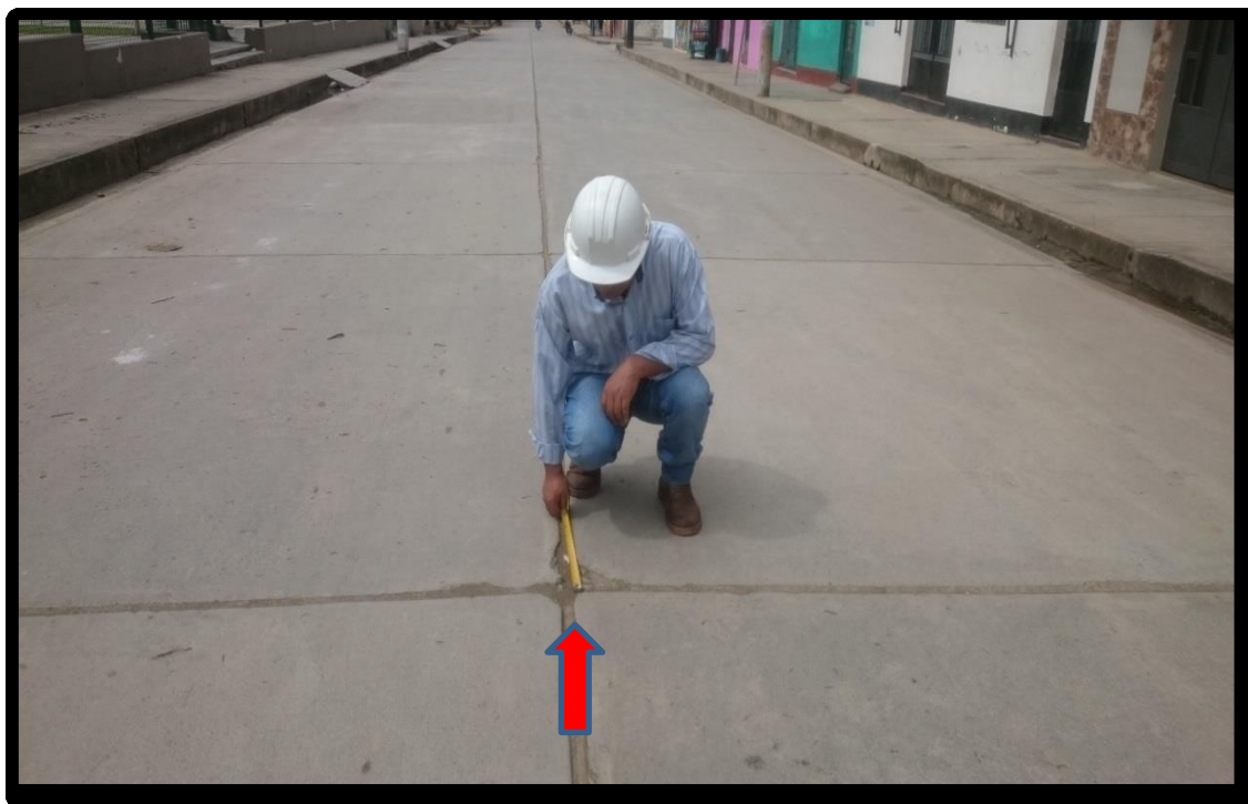
Figura 248. Fotografía con presencia, descascaramiento de esquina de nivel de severidad baja (38L), identificado en la unidad de muestra 09, del Jirón San Martín, cuadra 09.
