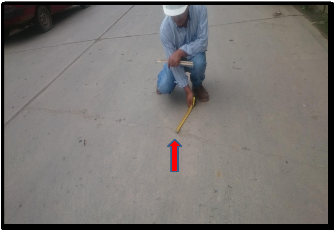
Figura 215. Fotografía con presencia, grietas lineales de nivel de severidad media (28M), identificado en la unidad de muestra 01, del Jirón San Martín, cuadra 06.
