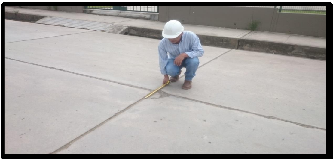
Figura 245. Fotografía con presencia, descascaramiento de esquina de nivel de severidad baja (38L), identificado en la unidad de muestra 08, del Jirón San Martín, cuadra 09.
