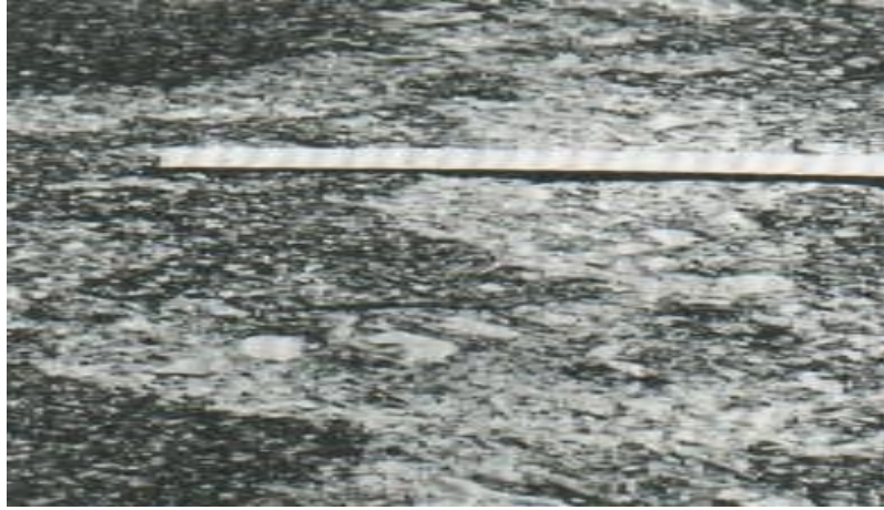
Figura 46. Desconchamiento / Mapa de grietas / Craquelado de severidad media.
