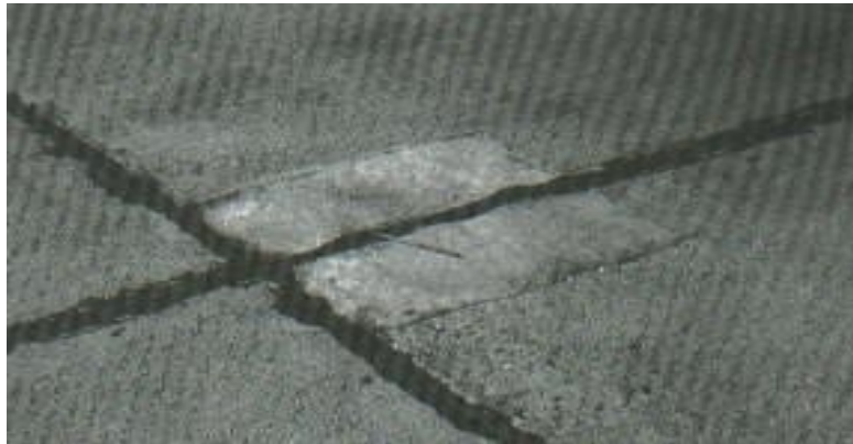
Figura 32. Parche pequeño de baja severidad.
