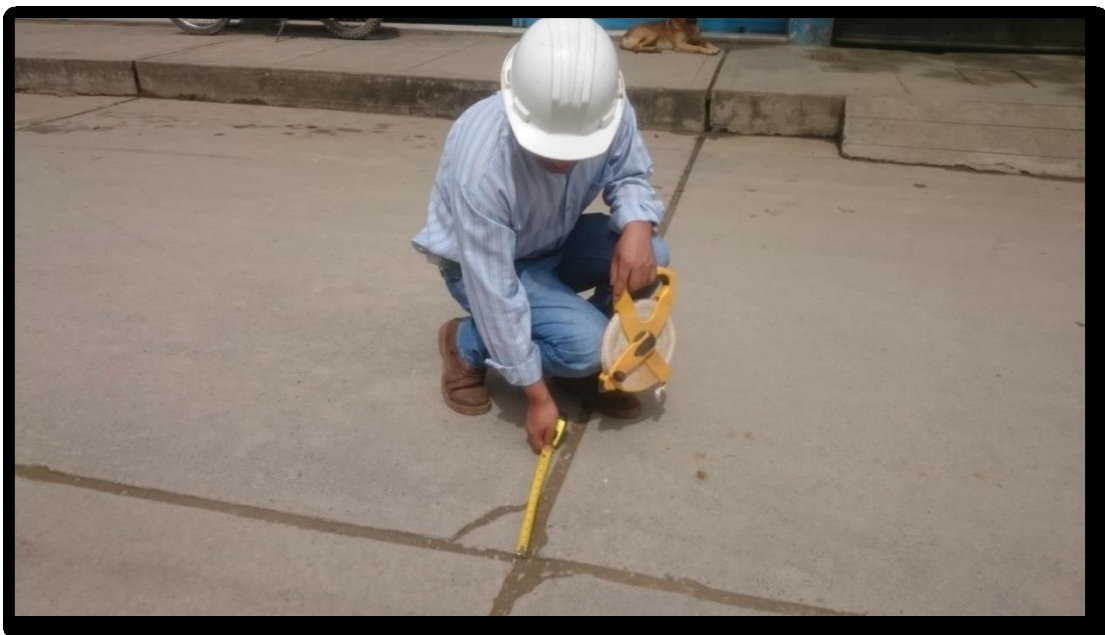
Figura 255. Fotografía con presencia Descascaramiento de esquina de nivel de severidad baja (38L), identificado en la unidad de muestra 11 del Jirón San Martín.
