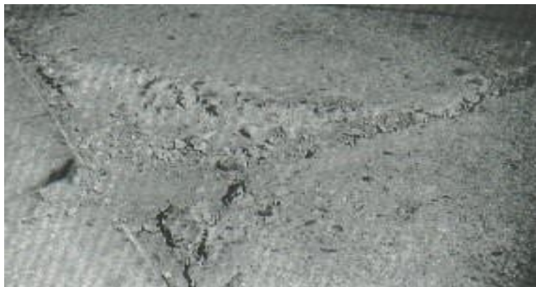
Figura 51. Descascaramiento de esquina de alta severidad.
