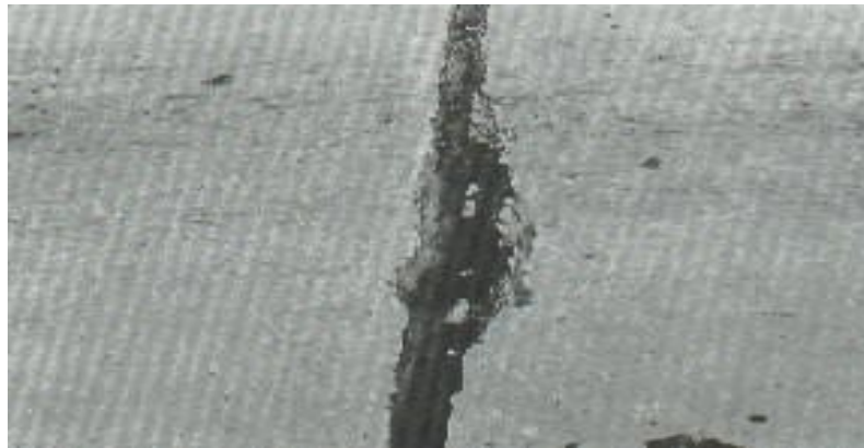
Figura 21. Daño del sello de junta de severidad media.
