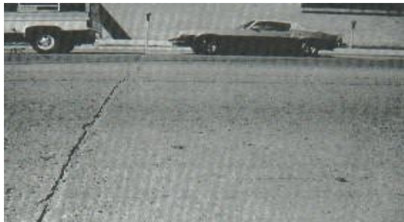
Figura 52. Descascaramiento de junta de baja severidad.
