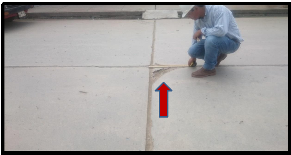
Figura 212. Fotografía con presencia, descascaramiento de esquina de nivel de severidad media (38M), en la unidad de muestra 01, del Jirón San Martín cuadra 06.
