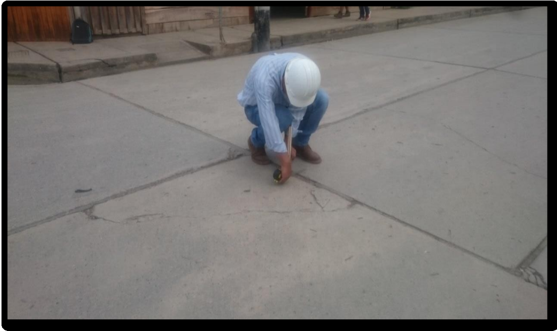
Figura 224. Fotografía con presencia, Grita de equina (22M) de nivel de severidad medio, identificado en la unidad de muestra 03, del Jirón San Martín, cuadra 07.
