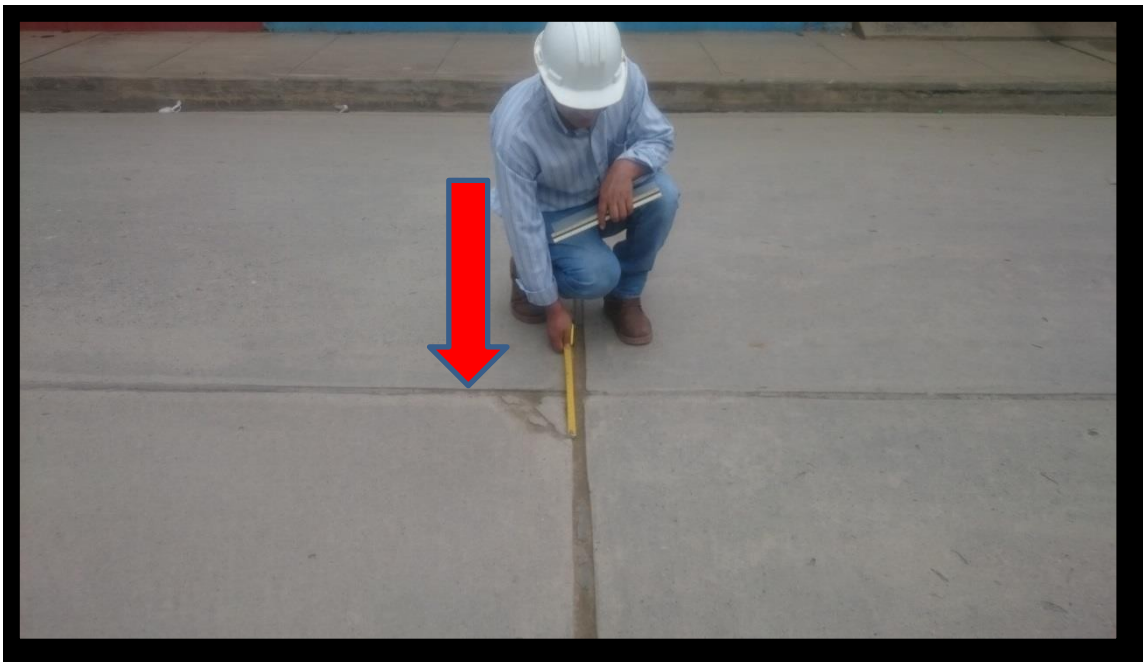
Figura 223. Fotografía con presencia, descascaramiento de equina de nivel de severidad bajo (38L), identificado en la unidad de muestra 03, del Jirón San Martín, cuadra 07.
