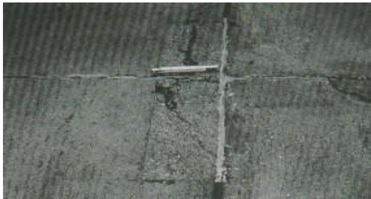
Figura 34. Parche pequeño de alta severidad
