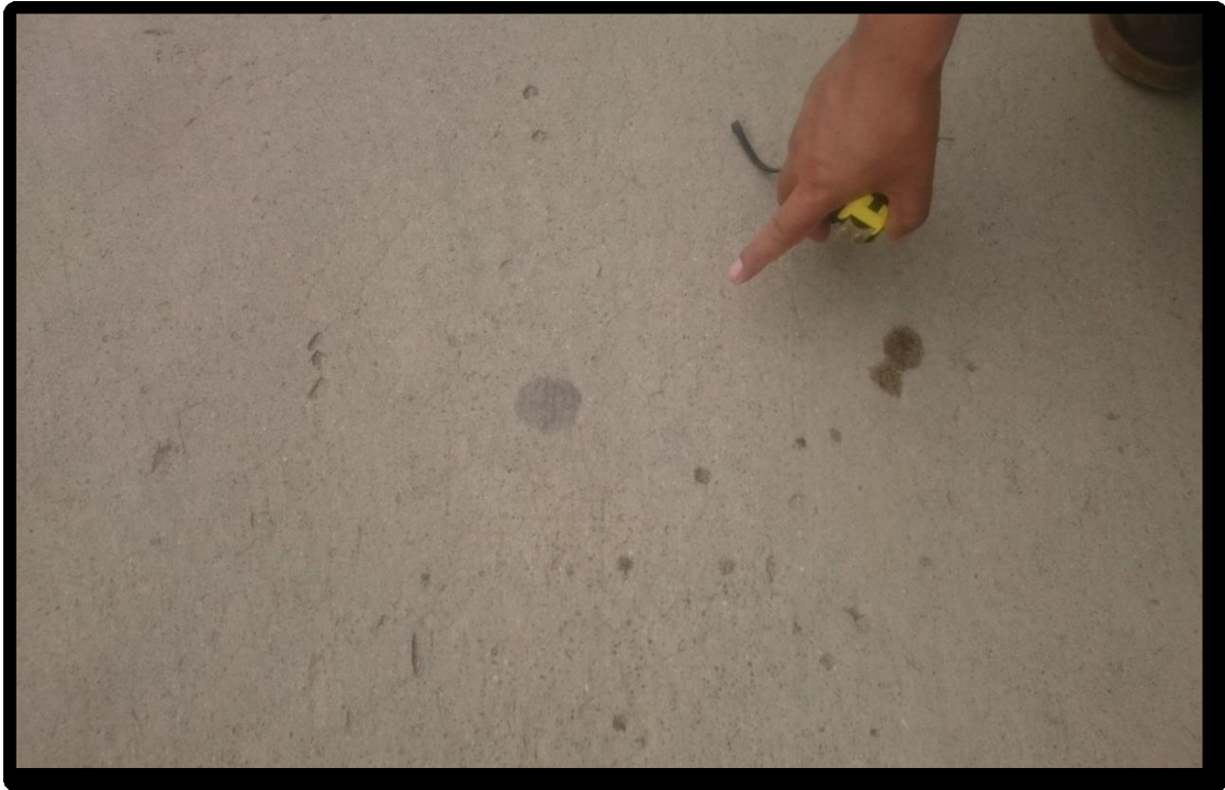
Figura 236. Fotografía con presencia, desconchamiento, mapa de grietas craquelado de nivel de severidad baja (36L), identificado en la unidad de muestra 05, del Jirón San Martín, cuadra 08.
