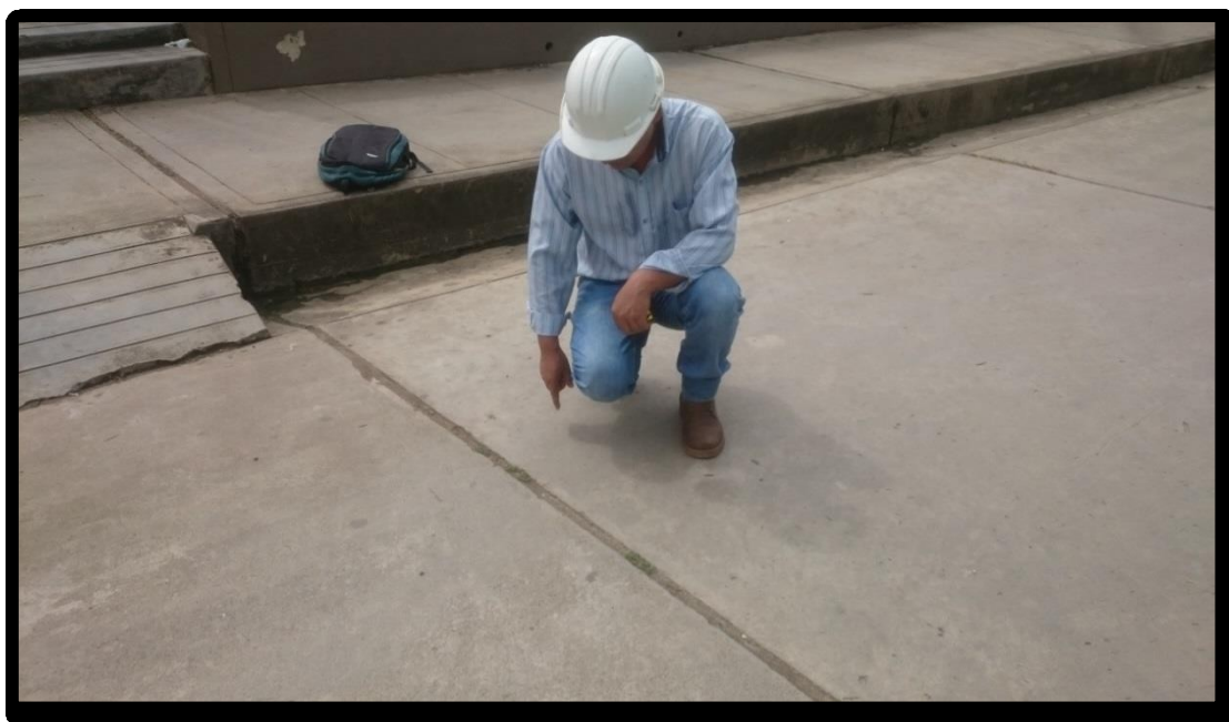
Figura 249. Fotografía con presencia, daño sello de junta de nivel de severidad medio (26M), identificado en la unidad de muestra 09, del Jirón San Martín, cuadra 09.
