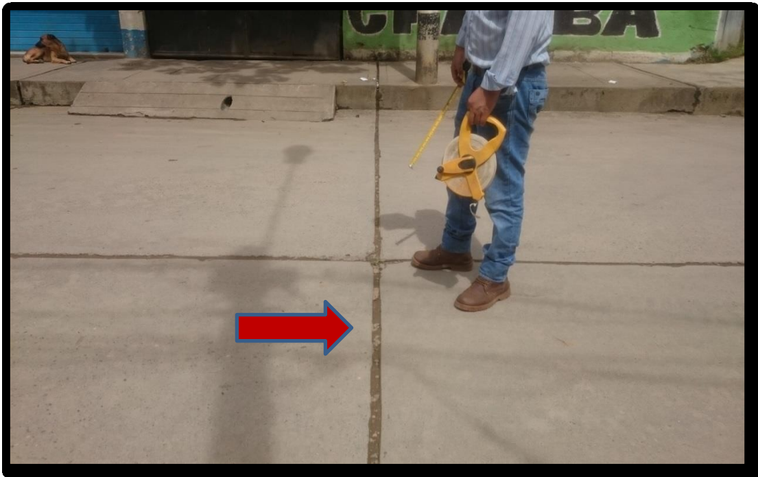
Figura 259. Fotografía con presencia daño sello de junta, nivel de severidad baja (26M), identificado en la unidad de muestra 11, del Jirón San Martín, cuadra 10.
