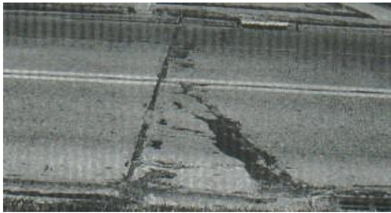
Figura 40. Punzonamiento de severidad media.
