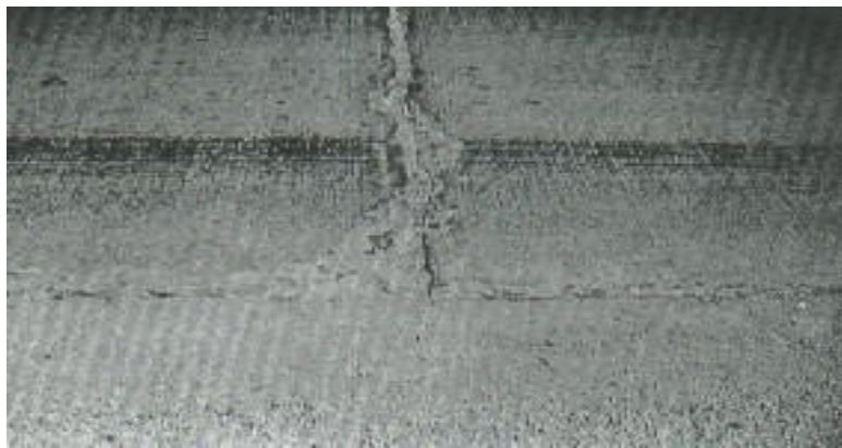
Figura 50. Descascaramiento de esquina de severidad media.
