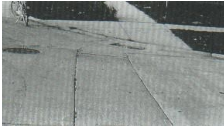
Figura 29. Parche grande y acometidas de servicios públicos de baja severidad.
