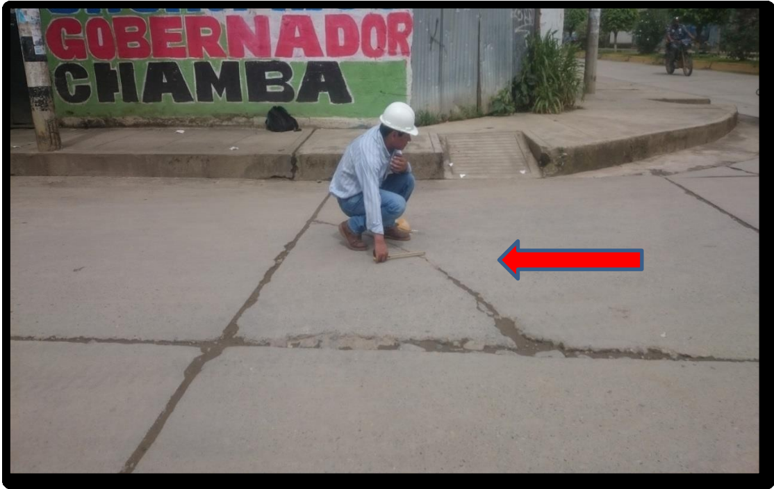
Figura 256. Fotografía con presencia, grieta de esquina, de nivel de severidad baja (38L), identificado en la unidad de muestra 11, del Jirón San Martín, cuada 10.
