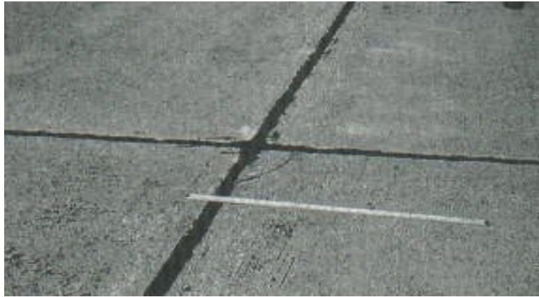
Figura 49. Descascaramiento de esquina de baja severidad.
