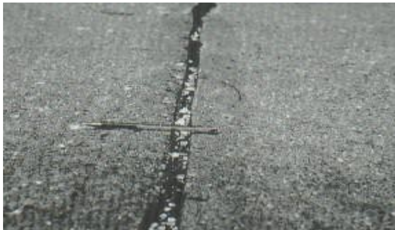
Figura 22. Daño del sello de junta de alta severidad.
