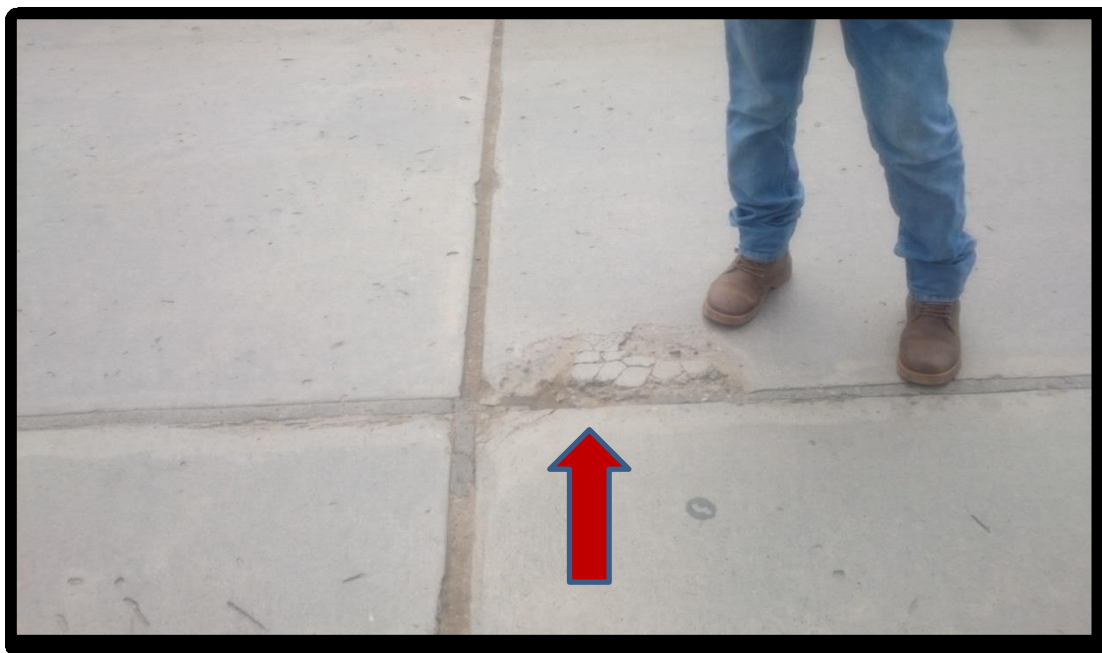
Figura 213. Fotografía con presencia, punzonamiento de nivel de severidad media (34M), identificado en la unidad de muestra 01 del Jirón San Martín, cuadra 06.
