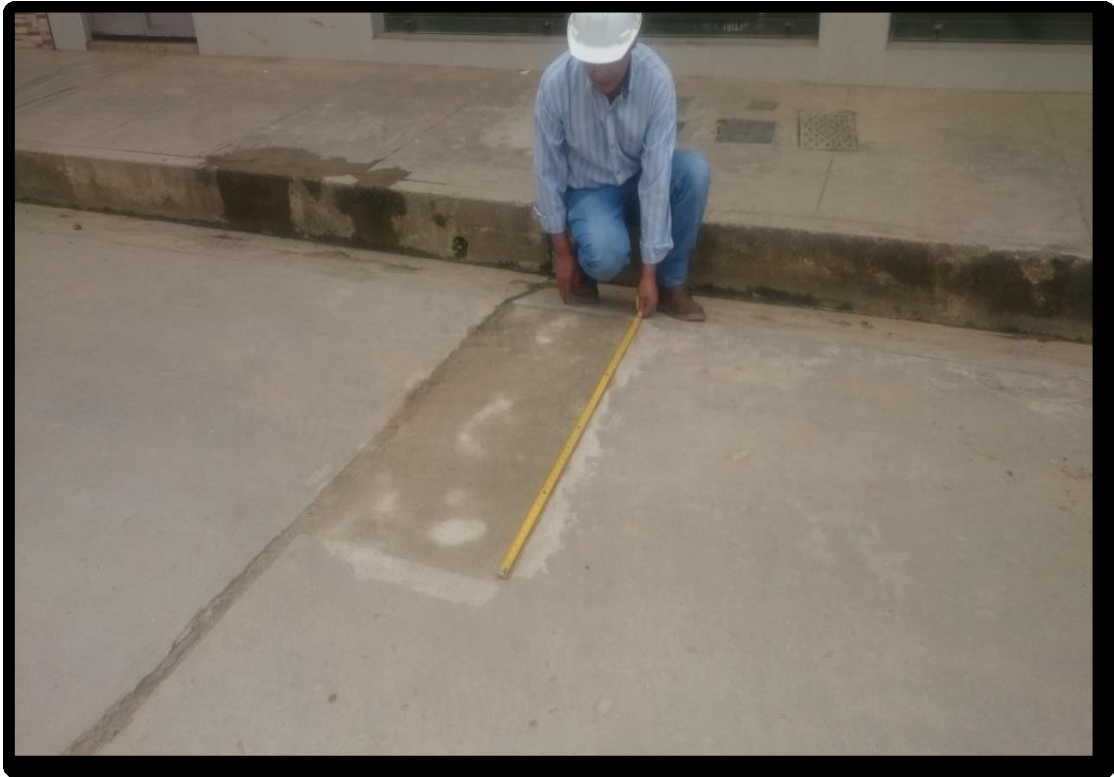
Figura 238. Fotografía con presencia, parche grande mayor a 0.45m 2 de nivel de severidad baja (29L), identificado en la unidad de muestra 06, del Jirón San Martín, cuadra 08.
