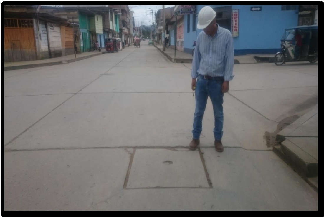
Figura 235. Fotografía con presencia, parche grade mayor a 0.45m 2 de nivel de severidad baja (29L), identificado en la unidad de muestra 05, del Jirón San Martín, cuadra 08.
