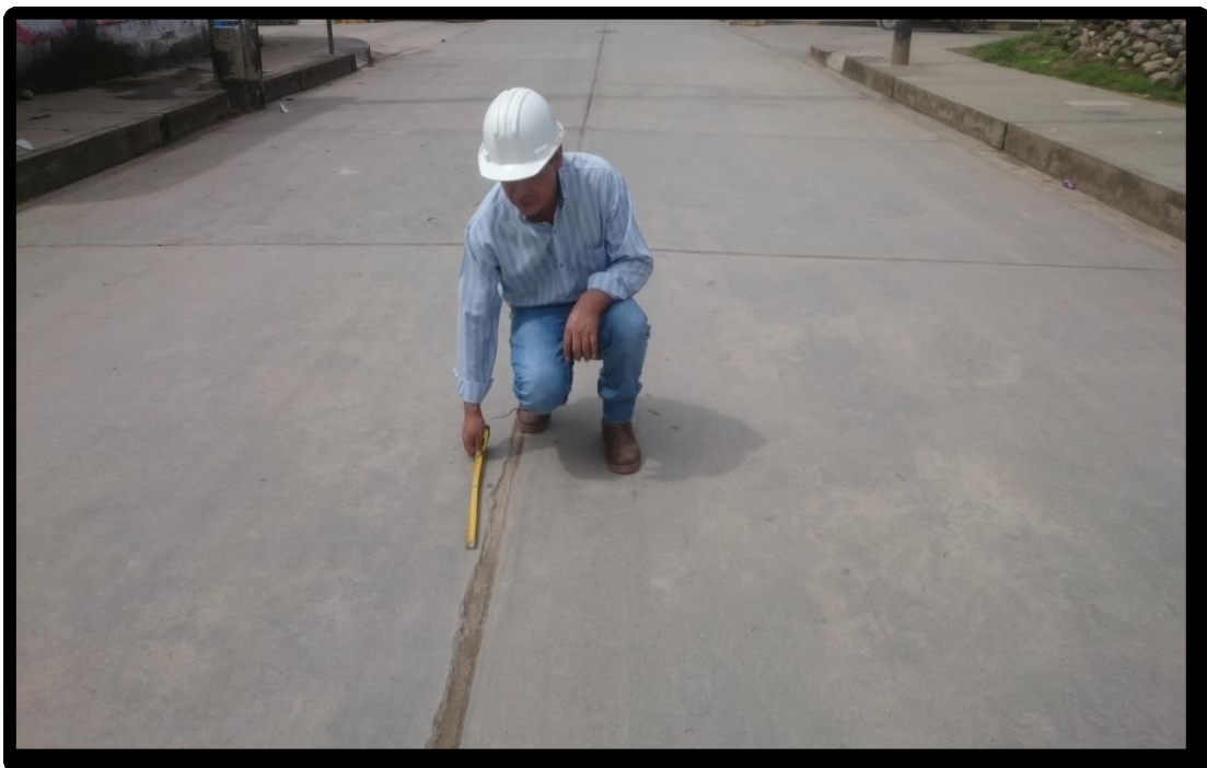
Figura 253. Fotografía con presencia, Descascaramiento de junta de nivel de severidad baja (39L), identificado en la unidad de muestra 10, del Jirón San Martín, cuadra 10.
