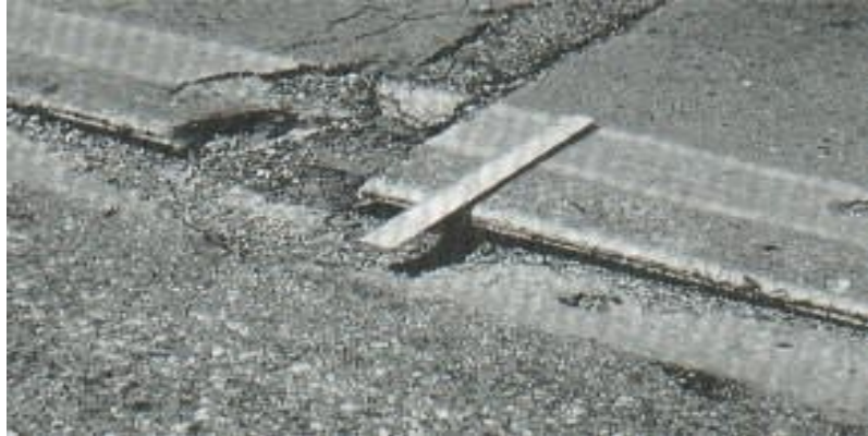
Figura 23. Desnivel carril / berma de baja severidad.
