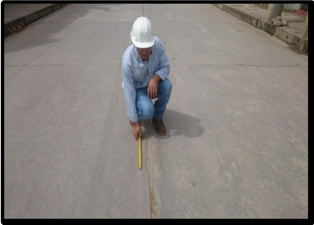
Figura 246. Fotografía con presencia, descascamiento de junta de nivel de severidad baja (39L), identificado en la unidad de muestra 08, del Jirón San Martín, cuadra 09.
