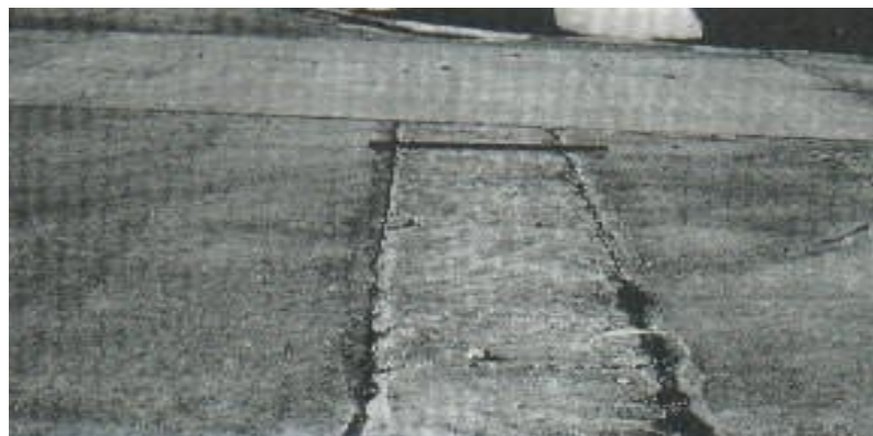
Figura 30. Parche grande y acometida de servicios públicos de severidad media.
