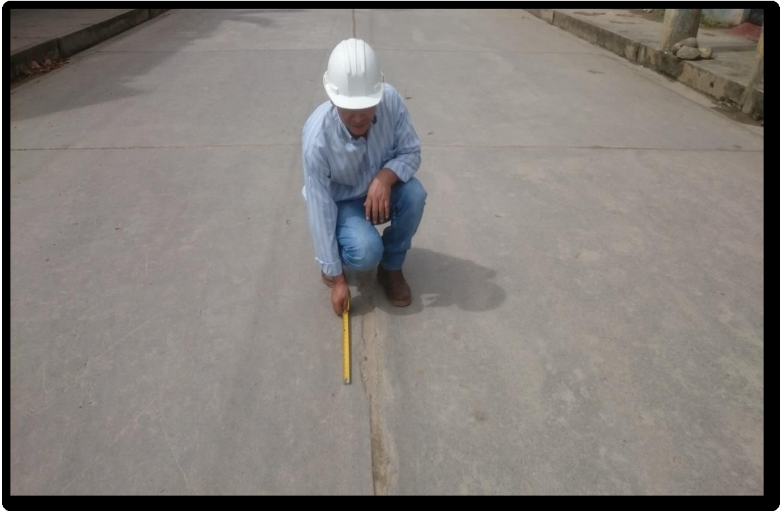
Figura 250. Fotografía con presencia, Descascaramiento de junta de nivel de severidad baja (39L), identificado en la unidad de muestra 09, del Jirón San Martín, cuadra 09.
