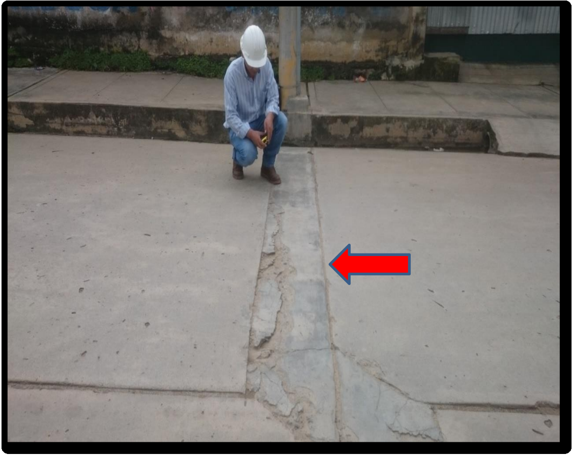
Figura 244. Fotografía con presencia, parche grande mayor a 0.45m 2 de nivel de severidad media (29M), identificado en la unidad de muestra 07, del Jirón San Martín, cuadra 08.
