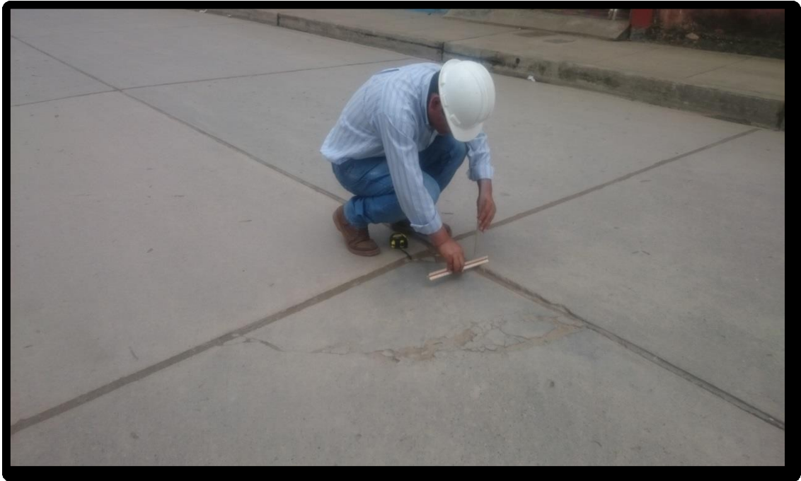
Figura 228. Fotografía con presencia, grieta de esquina, presenta escala, de nivel de severidad media (22M), identificado en la unidad de muestra 04 del Jirón San Martín, cuadra 07.
