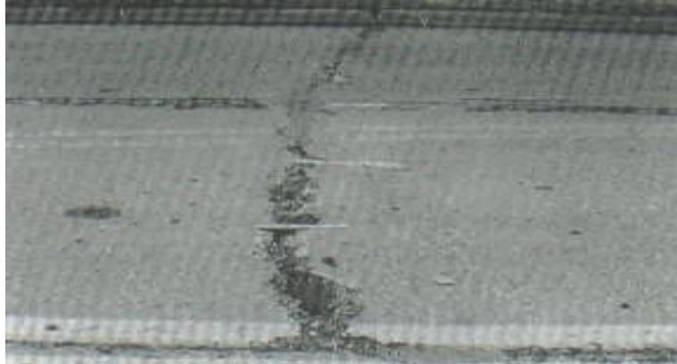
Figura 28. Grietas lineales de alta severidad en losa de concreto simple.
