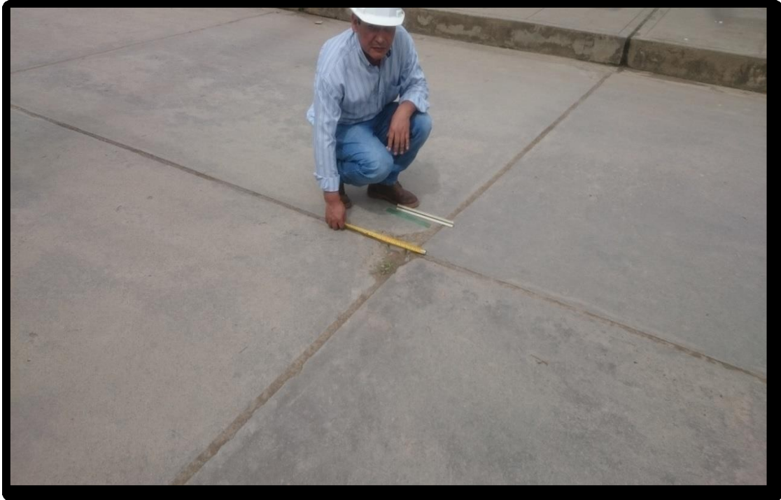
Figura 252. Fotografía con presencia, Descascaramiento de esquina de nivel de severidad baja (38L), identificado en la unidad de muestra 10, del Jirón San Martín, cuadra 10.
