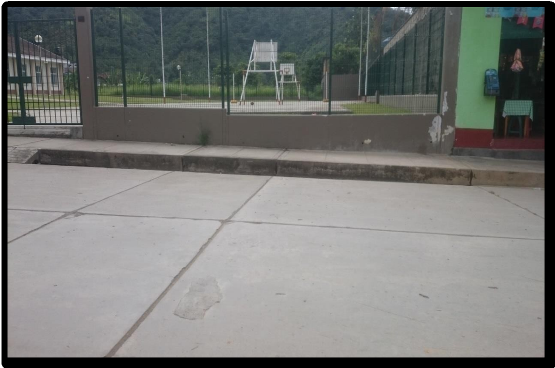
Figura 247. Fotografía con presencia, daño sello de junta de nivel de severidad (26M), identificado en la unidad de muestra 08 del Jirón San Martín, cuadra 09.
