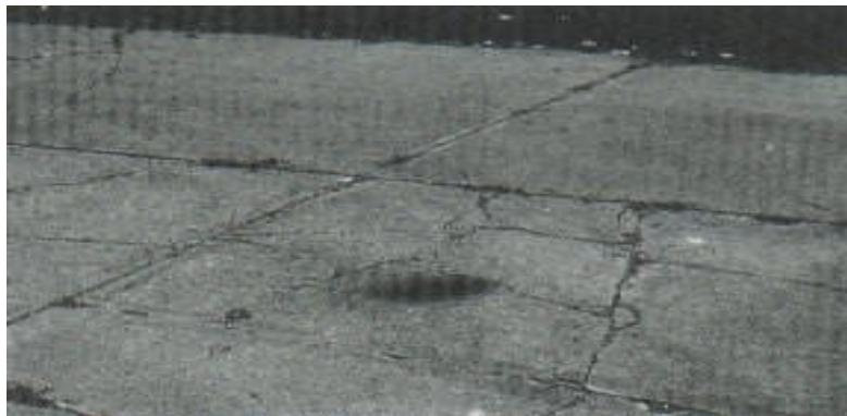
Figura 13. Losa dividida de alta severidad.
