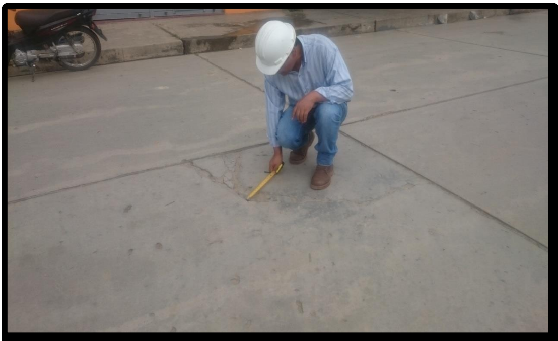
Figura 241. Fotografía con presencia, grieta de esquina, de nivel de severidad alta (22H), identificado en la unidad de muestra 07, del Jirón San Martín, cuadra 08.
