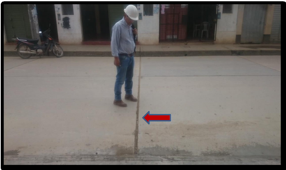
Figura 243. Fotografía con presencia, daño sello de junta, de nivel de severidad media (26M), identificado en la unidad de muestra 07 del Jirón San Martín, cuadra 08.
