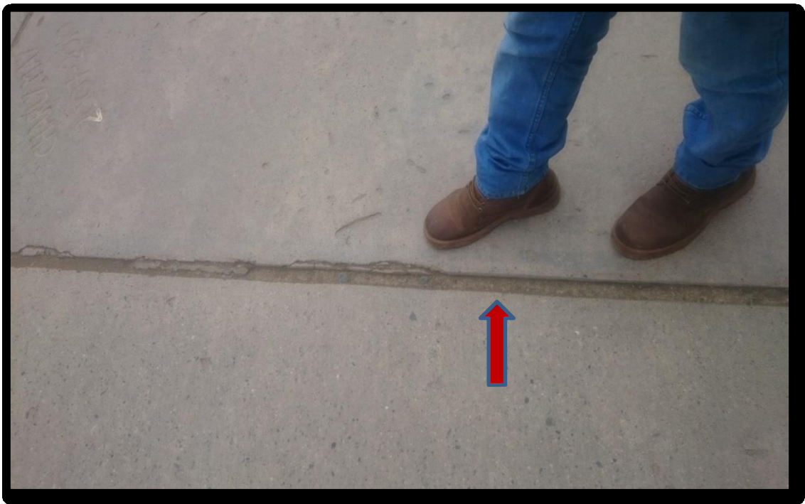
Figura 229. Fotografía con presencia daño sello de junta de nivel de severidad medio (26M), identificado en la unidad de muestra 04 del Jirón San Martín, cuadra 07.
