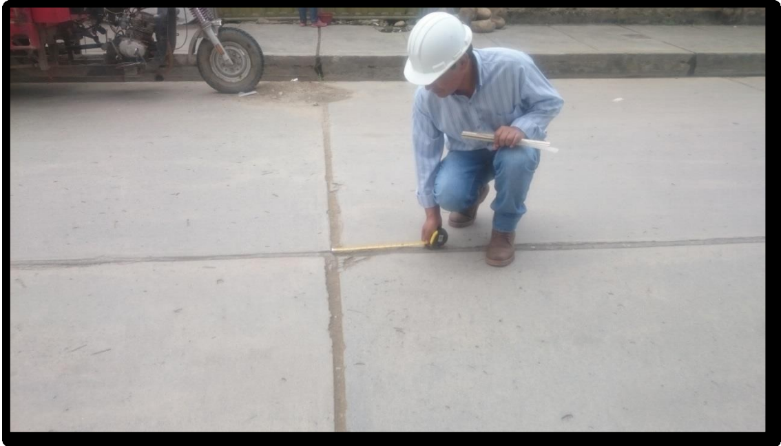
Figura 218. Fotografía con presencia, descascamiento de esquina de nivel de severidad bajo (38L), identificado en la unidad de muestra 02, del Jirón San Martín, cuadra 06.
