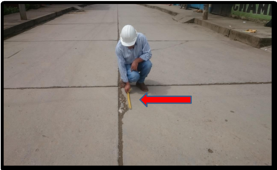
Figura 257. Fotografía con presencia, descascaramiento de junta, de nivel de severidad baja (39L), identificado en la unidad de muestra 11 del Jirón San Martín.
