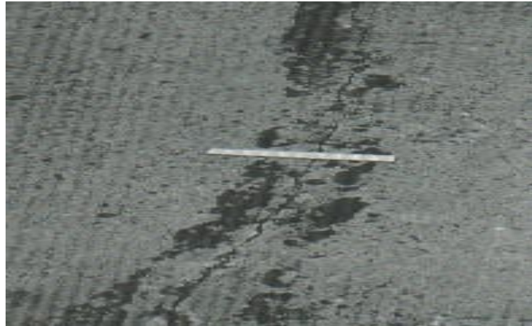
Figura 26. Grietas lineales de baja severidad en losa de concreto simple.
