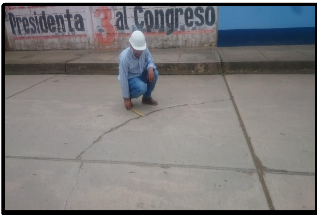
Figura 233. Fotografía con presencia, grieta de esquina, de nivel de severidad medio (22M), identificado en la unidad de muestra 05, del Jirón San Martín, cuadra 08.
