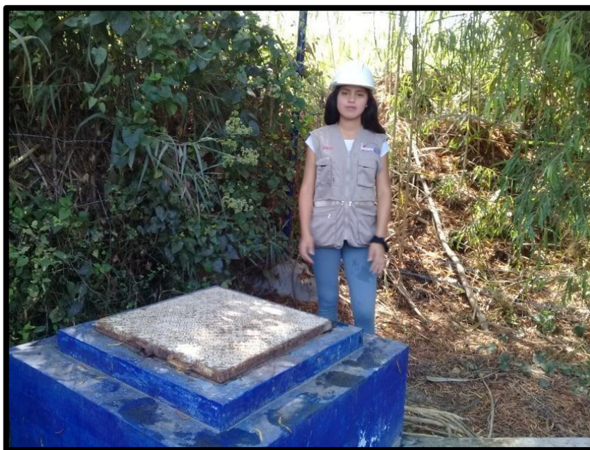
Imagen N° 04: Cámara de captación del caserío de Larea Baja, Distrito de Moro, Provincia de Santa, departamento Áncash.
