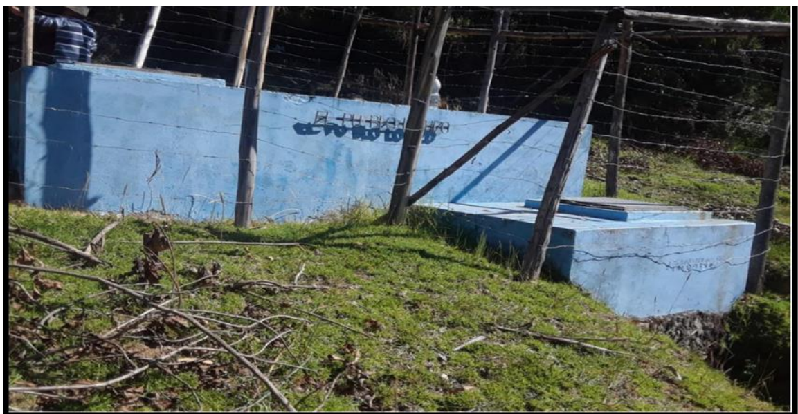
Figura 23. Se muestra el estado en que se encuentra el reservorio y su caseta de válvula de control en el Caserío El Milagro, distrito de Independencia, provincia de Huaraz, departamento de Áncash y su incidencia en la condición sanitaria de la población– 2019.
