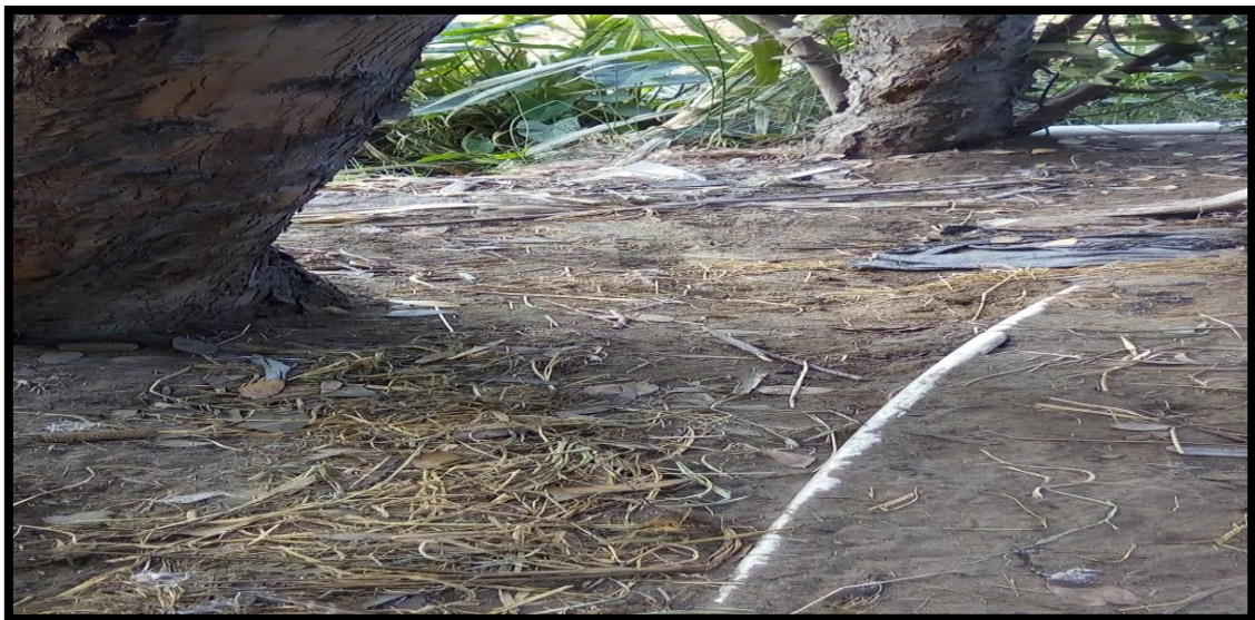
Figura 25. Se muestra el estado en que se encuentra la línea de conducción expuesta cualquier peligro en el Caserío El Milagro, distrito de Independencia, provincia de Huaraz, departamento de Áncash y su incidencia en la condición sanitaria de la población– 2019.
