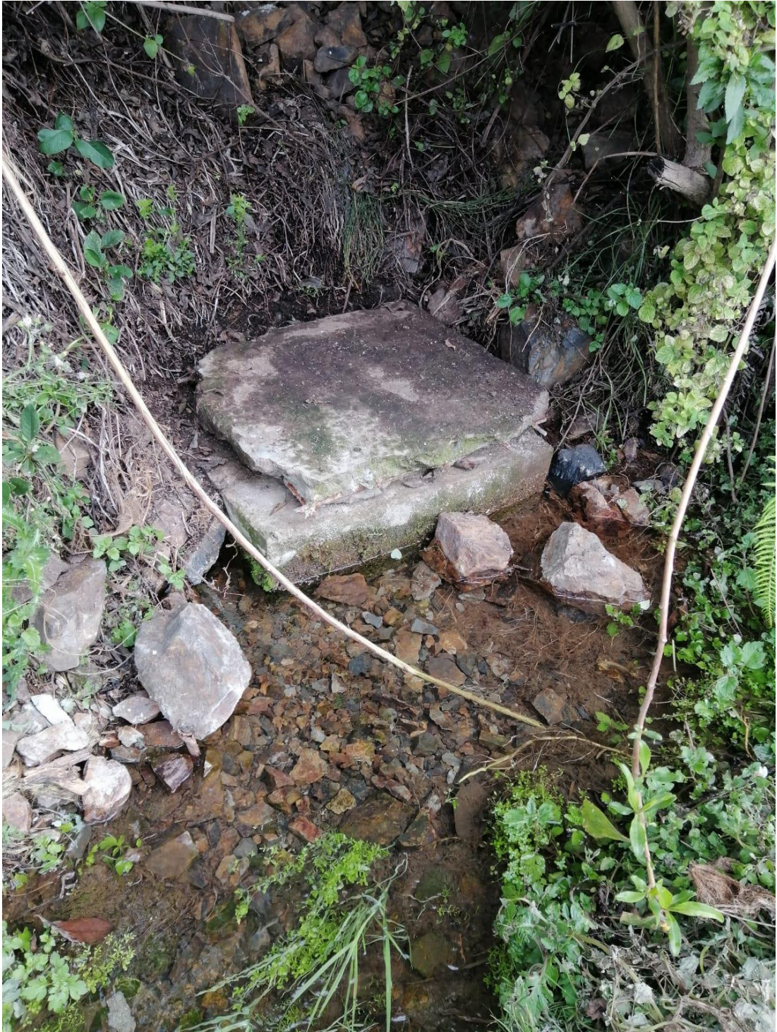
Fotografía 03: fuente de abastecimiento actual colapsado
