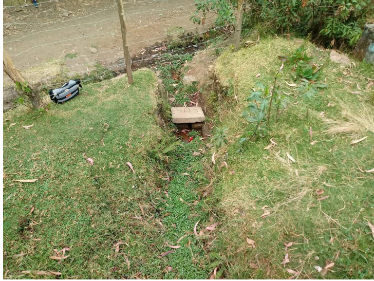
Figura 25. Caja de válvulas del reservorio de almacenamiento
