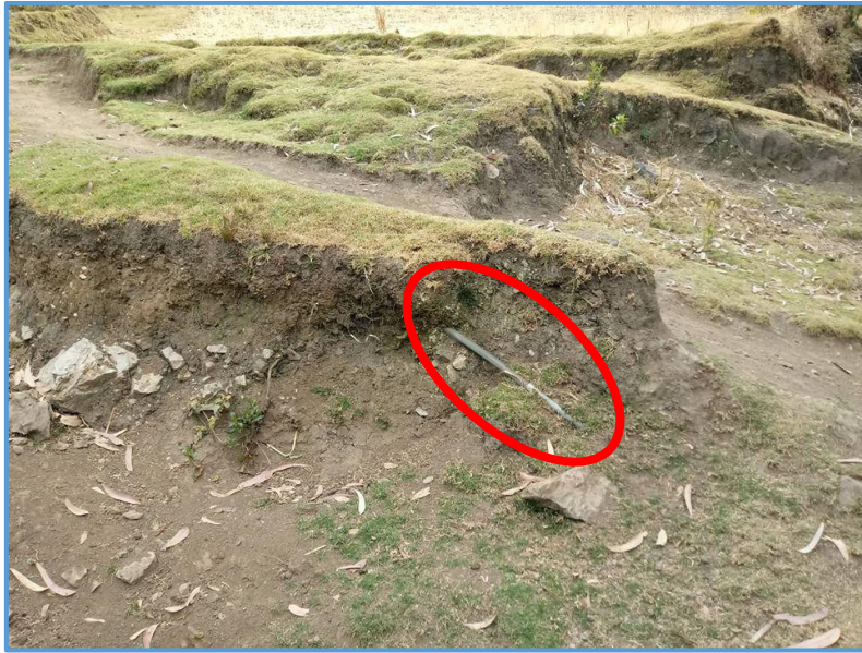
Figura 21. Línea de conducción expuesta, progresiva 0+120
