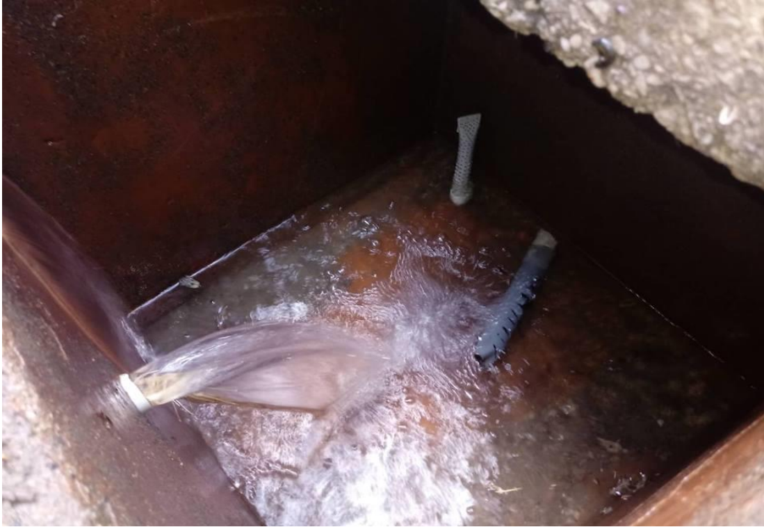
Imagen 10: Vista fotográfica de la captación Agua Blanca, vista interior en mal estado y sin cumplir con normas técnicas para la construcción de la captación.
