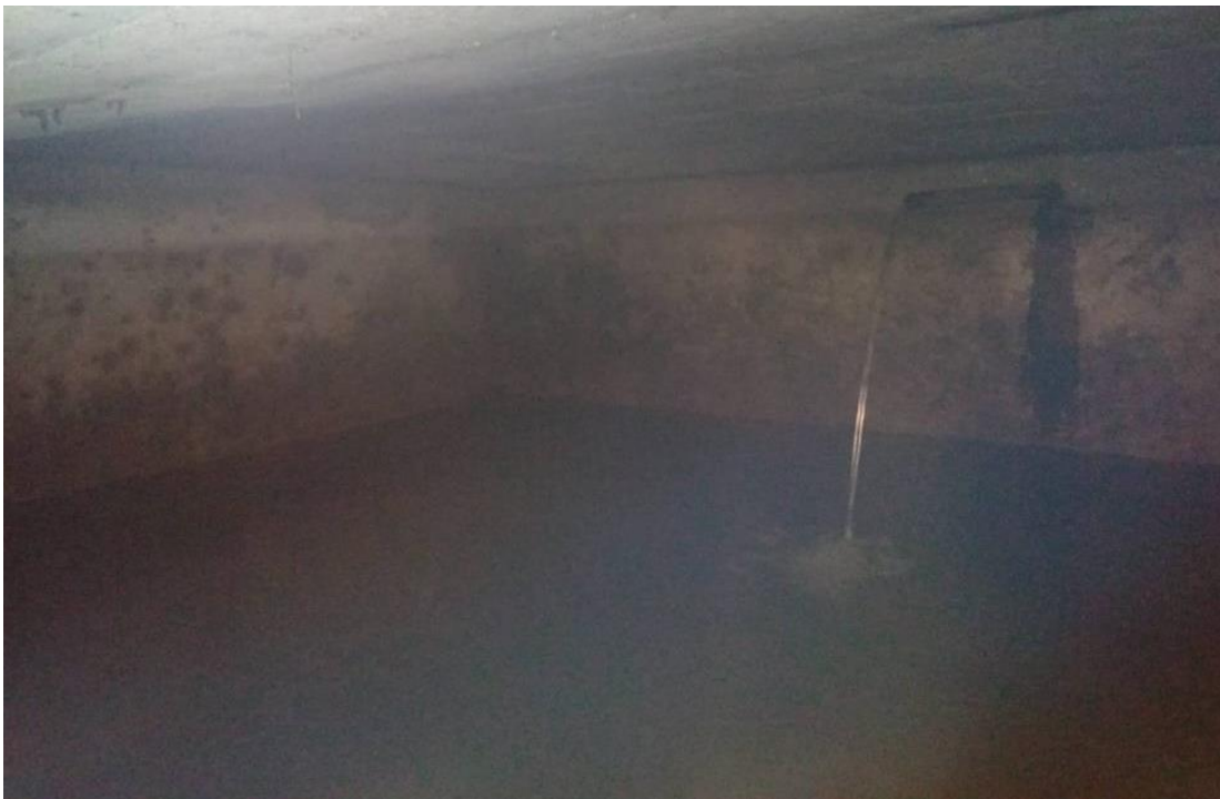
Imagen 13: Vista fotográfica del interior del reservorio de Katanya, observando que por cumplir ya su año útil ya se encuentra en mal estado.
