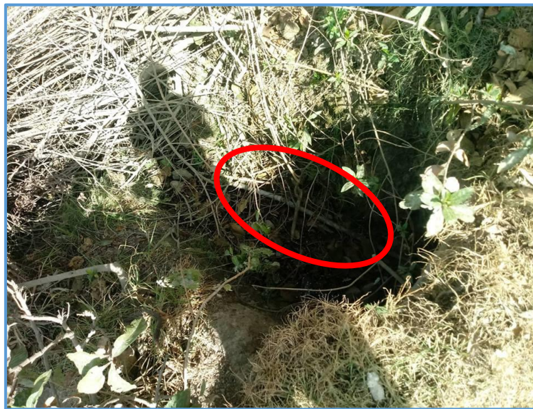
Figura 22. Línea de conducción expuesta, progresiva 0+020
