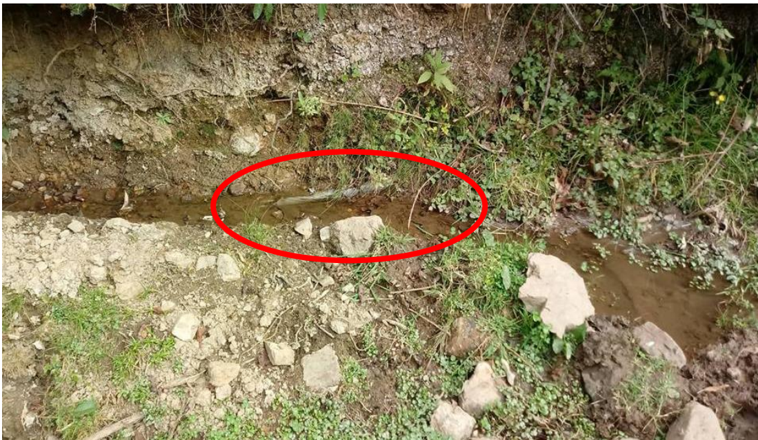
Imagen 11: Vista fotográfica de la línea de conducción, vista que se observa que las tuberías están expuestas, mostrándose así en múltiples puntos en la línea de conducción.
