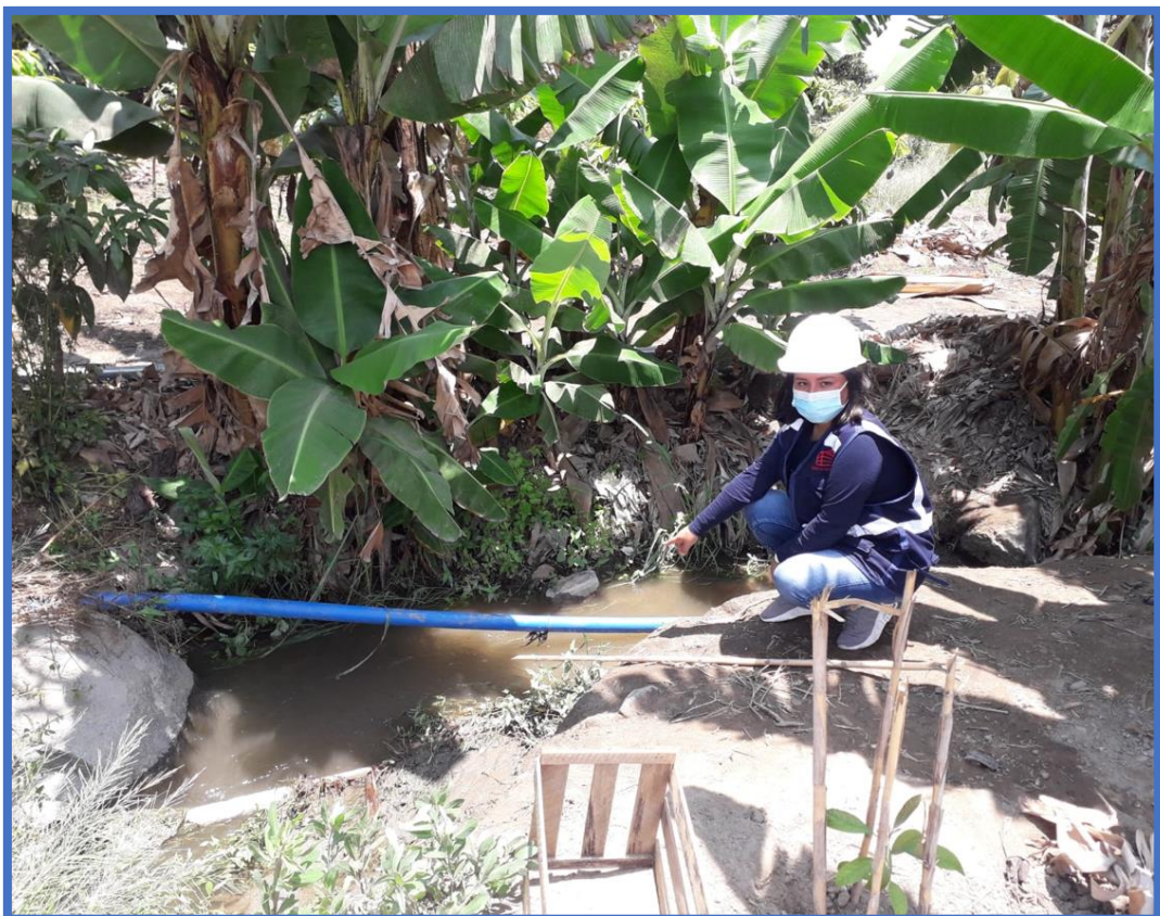
Imagen N° 02. – Se aprecia las tuberías de línea de conducción, expuesta a la intemperie
