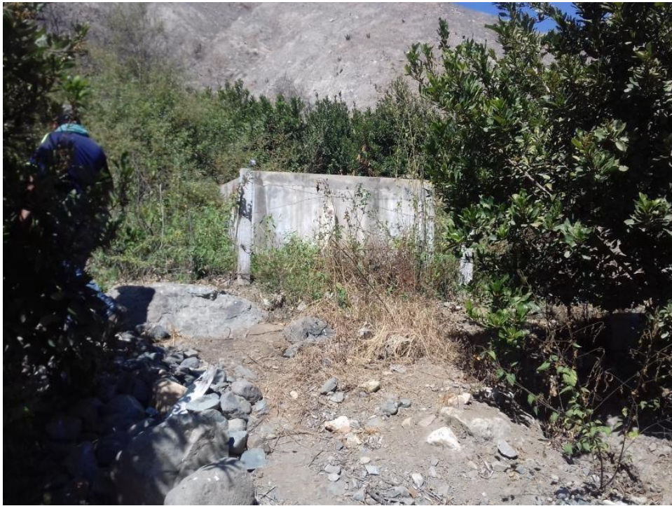
FOTO N° 03: VISTA DEL RESERVORIO EXISTENTE EN ESTADO DE DETERIORO, QUE REQUIERE SU RECONSTRUCCIÓN
