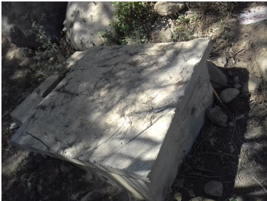
FOTO N° 02: VISTA DEL CRP T-6 EXISTENTE EN ESTADO DETERIORADO, YA QUE CUMPLIO SU VIDA UTIL
