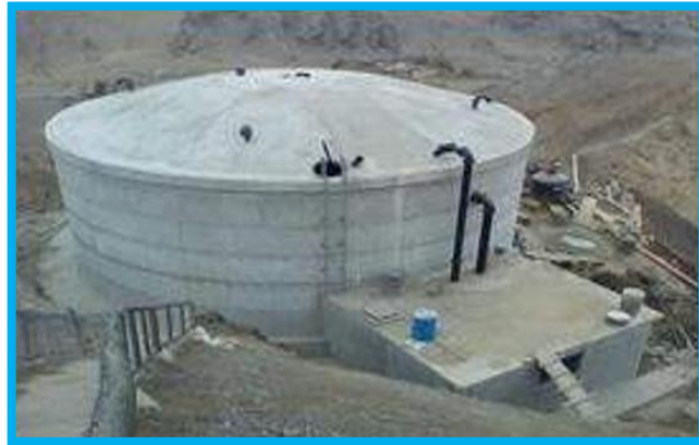
Figura 23. Reservoirio apoyado. Fuente: Cesel ingenieros (2016).
