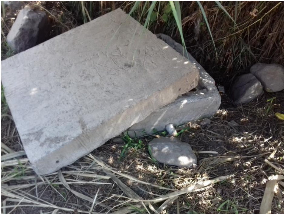
FOTO N° 05: VISTA DEL CRP T-7 EN LA LINEA DE ADUCCION EN ESTADO DETERIORADO REQUIERE SU RECONSTRUCCION URGENTE.
