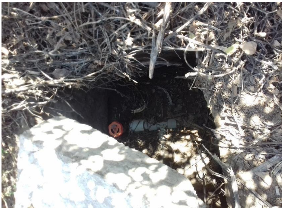
FOTO N° 06: VISTA DE LAS VALVULAS DE CONTROL DE DIAMETRO DE 1 ½", EN LAS RED DE ADUCCION Y DISTRIBUCION EN ESTADO DETERIORADO, REQUIERE RECONSTRUCCION
