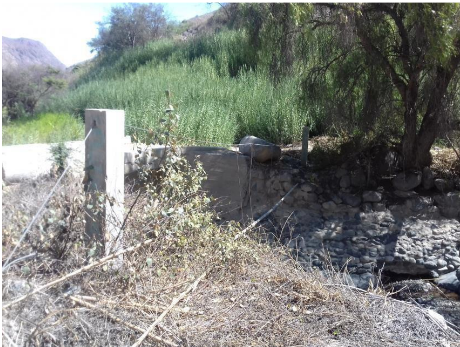
FOTO N° 04: VISTA DEL TRASVASE EXISTENTE EN LA LINEA DE CONDUCCION DEL SISTEMA DE AGUA POTABLE DEL CASERIO SANPEDRO REQUIERE SU RECONSTRUCCION
