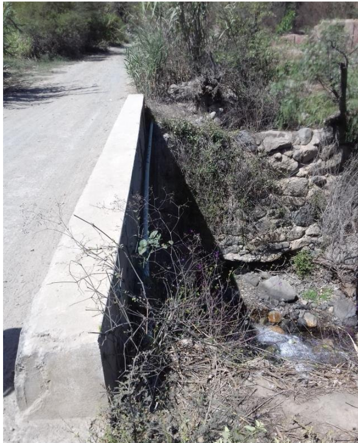
FOTO N° 07: VISTA DEL PASE AEREO DE LA TUBERIA DE DIAMETRO 1 ½", EN LA LINEA DE ADUCCION, REQUIERE SU CAMBIO URGENTE
