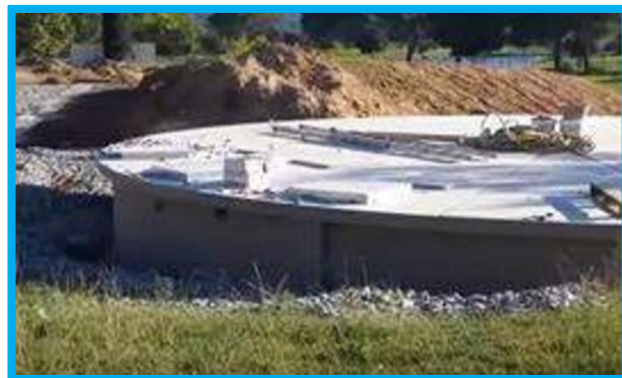
Figura 24 Reservoirio apoyado. Fuente: Cesel ingenieros (2016).
