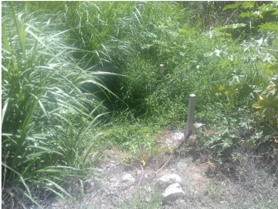
FOTO N° 01: VISTA DE LA CAPTACION DE SAN PEDRO EN ESTADO DECOLAPZO Y LLENO DE VEGETACION
