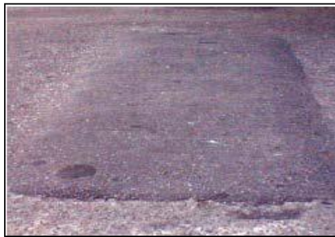
Hinchamiento de B severidad
