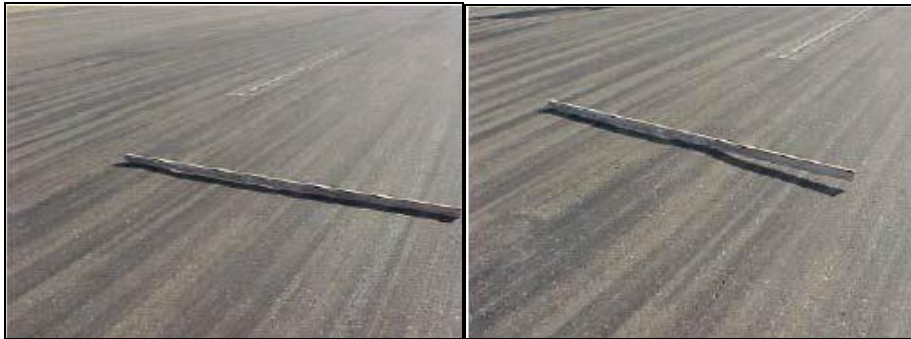
Ahuellamiento Media Severidad
