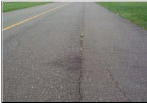
Fisuras longitudinales y transversales de severidad Media
