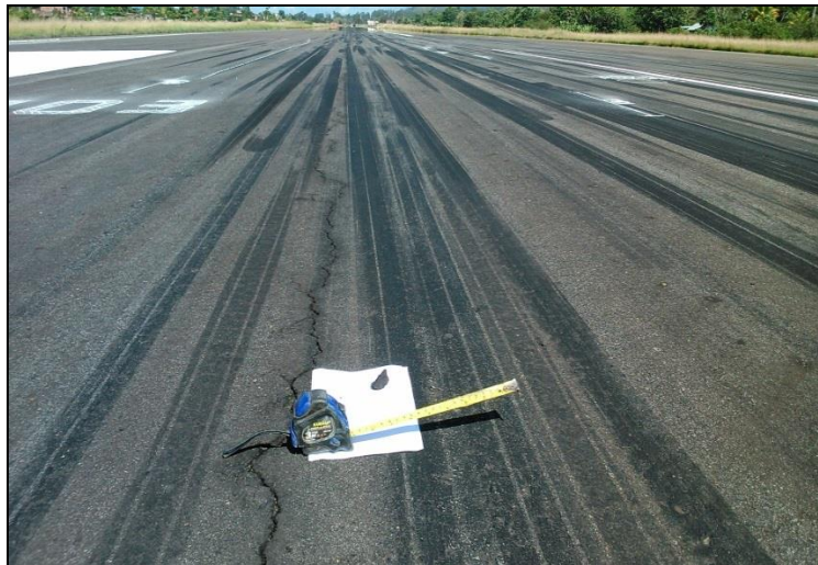
Piel de Cocodrilo de Mediana severidad
