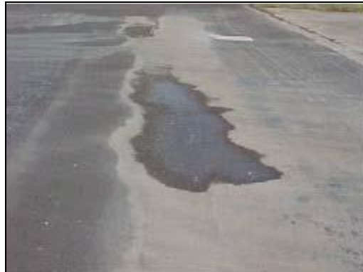
Depresiones de severidad Media
