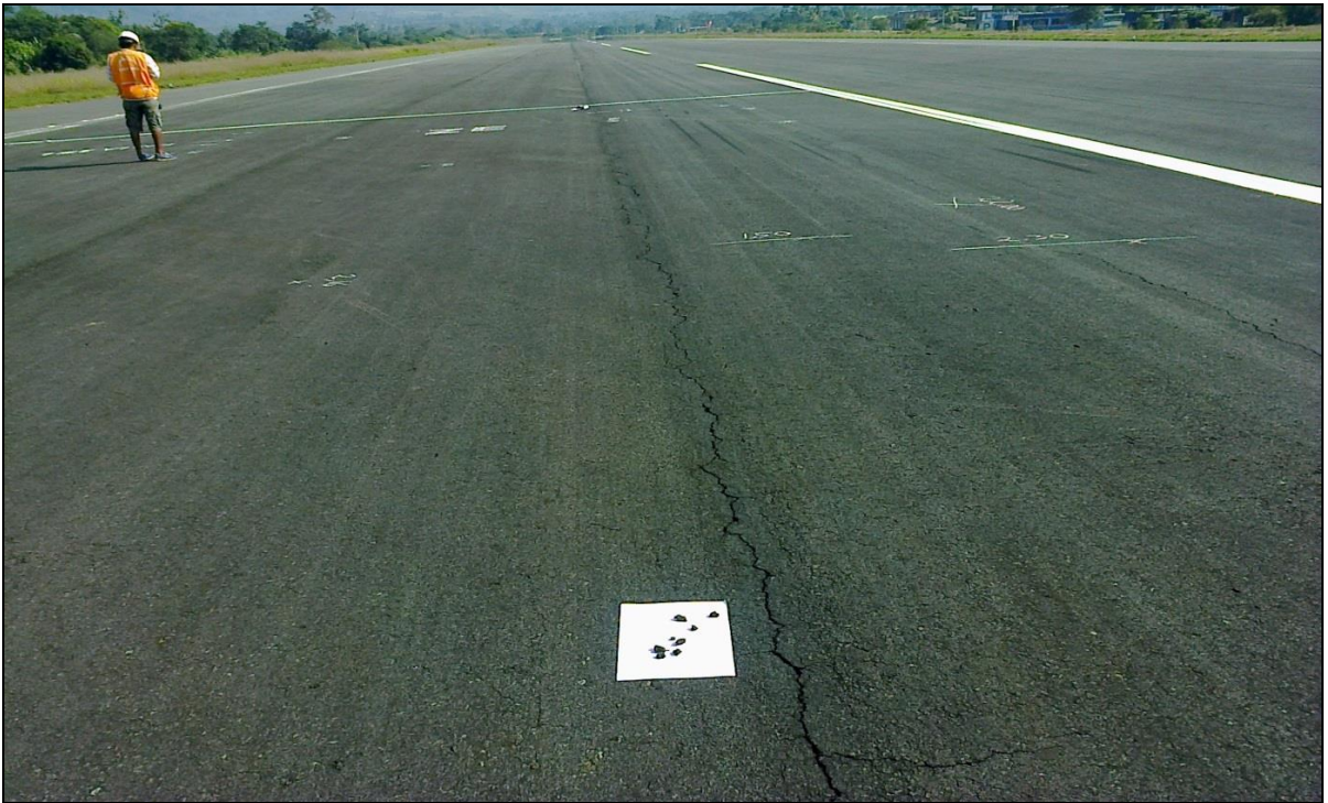
Falla: Fisuras Longitudinales y Transversales Severidad M
