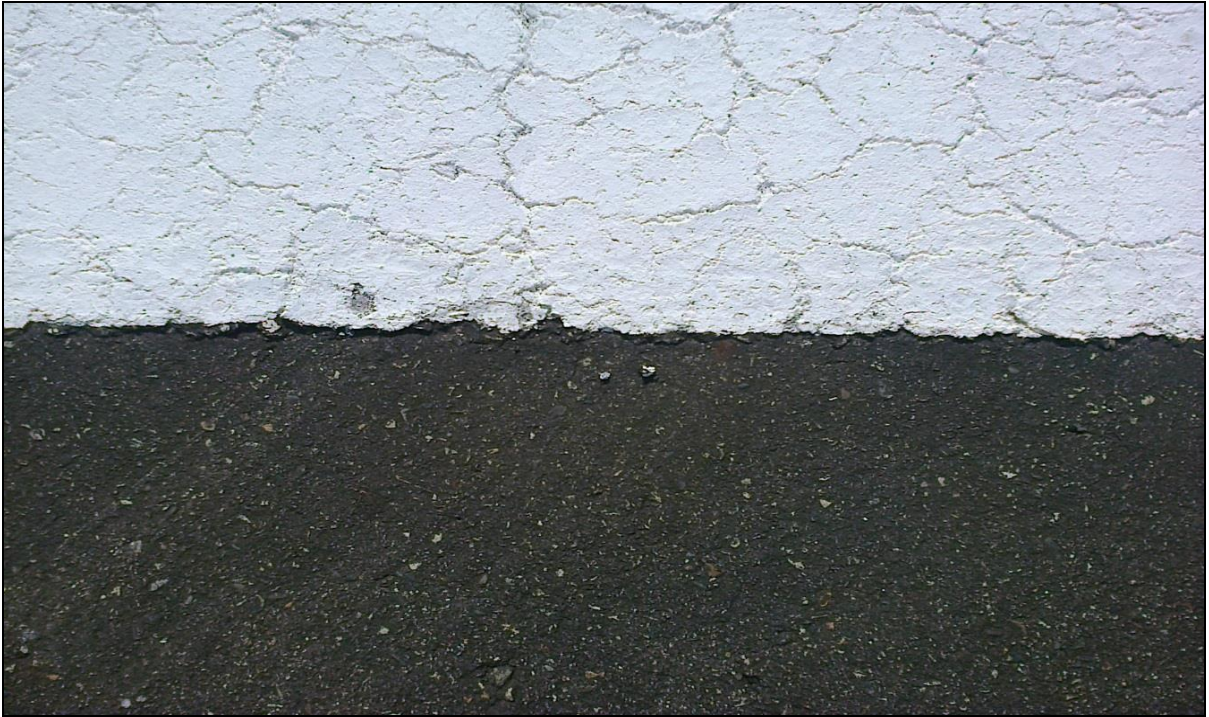
Desprendimiento de Agregado (FOD)
