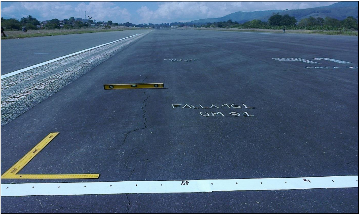
Falla: Hinchamiento Severidad L
