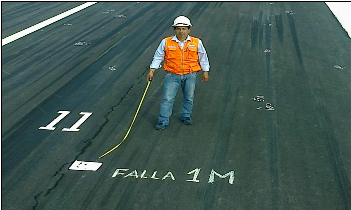
Falla: Piel de Cocodrilo Severidad L
