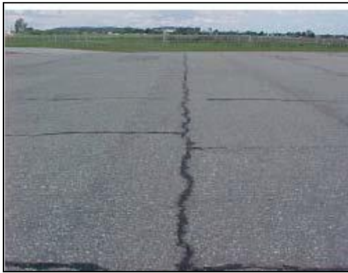
Reflexión de junta de Baja severidad
