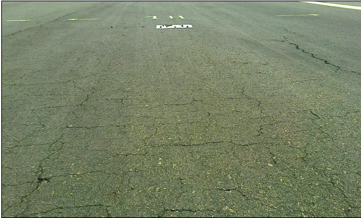
Falla: Piel de Cocodrilo Severidad M
