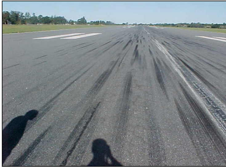
Piel de Cocodrilo de Baja severidad
