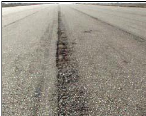
Fisuras longitudinales y transversales de Alta severidad.
