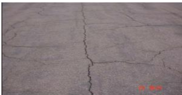
Fisura de Bloque de severidad Media
