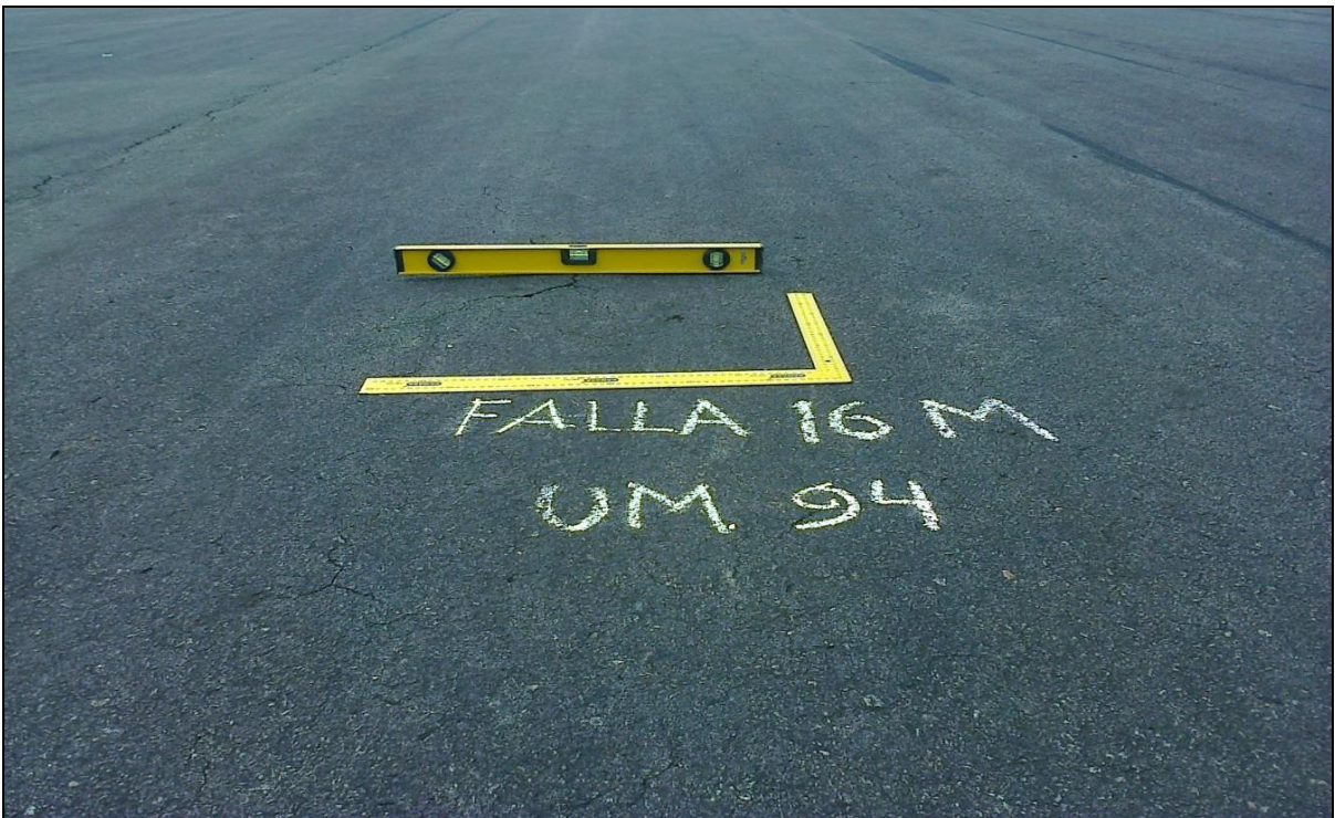
Falla: Hinchamiento Severidad M
