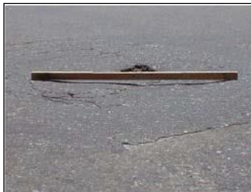
Depresiones de Alta severidad
