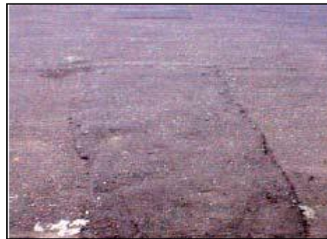
Hinchamiento de severidad Media
