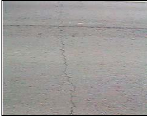
Reflexión de junta de Baja severidad
