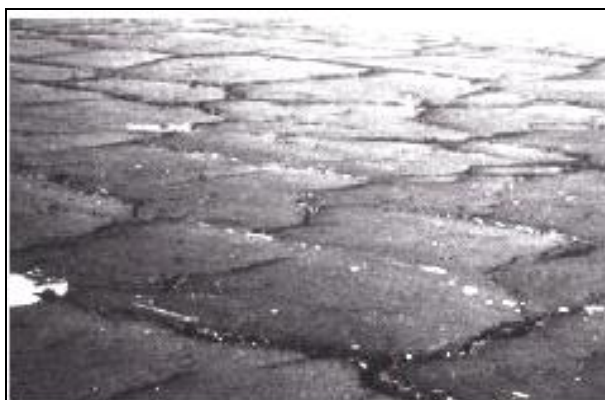
Fisura de Bloque de Alta severidad
