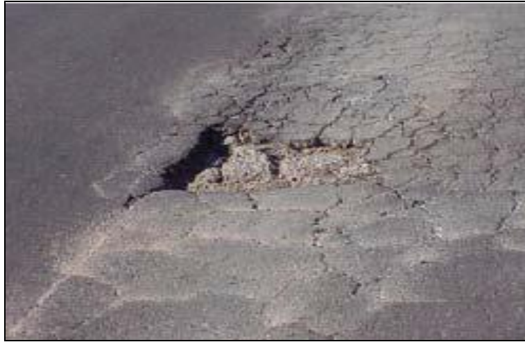
Piel de Cocodrilo de Alta severidad
