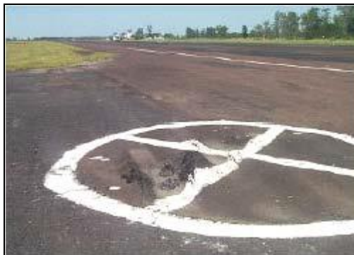
Ahuellamiento Alta Severidad
