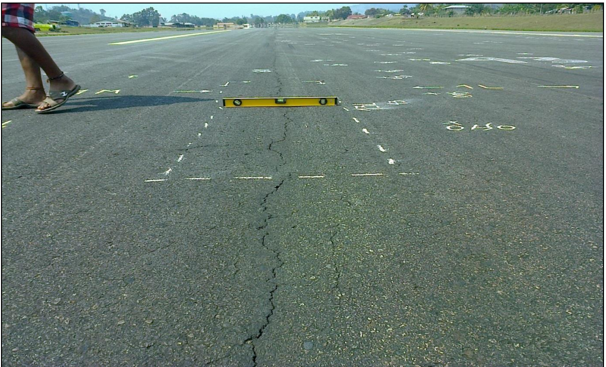
Falla: Ahuellamiento Severidad L
