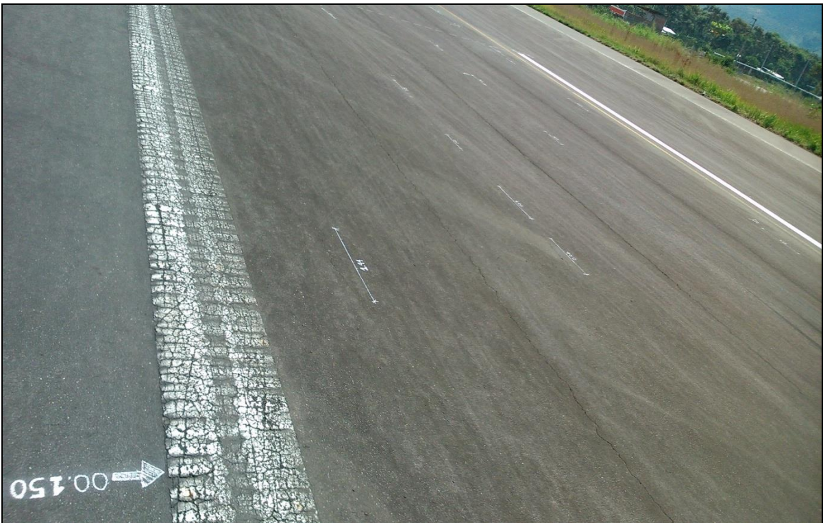
Falla: Fisuras Longitudinales y Transversales Severidad L
