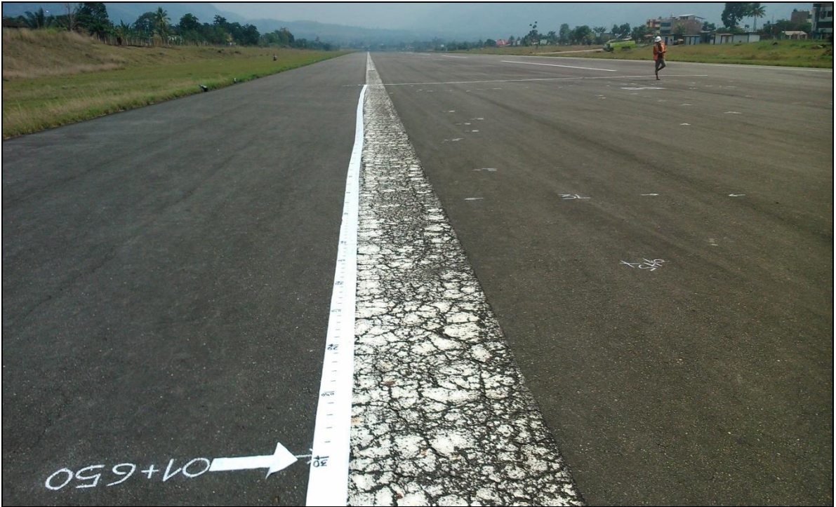
Falla: Fisura en Bloque Severidad M
