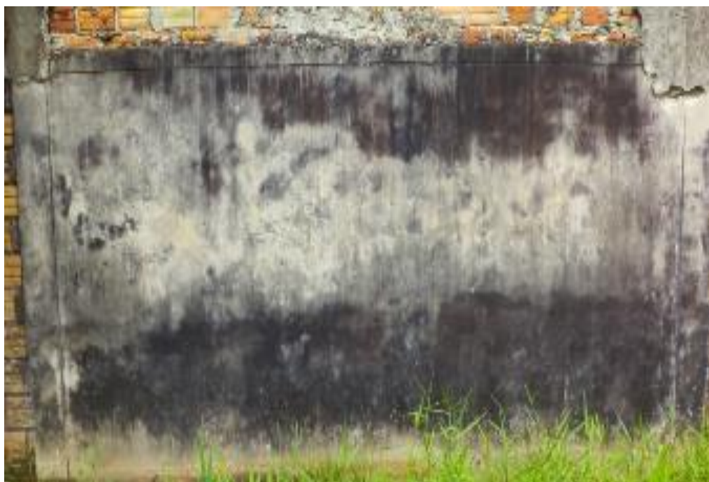
Fotografía 03: Eflorescencia en los muros y columna, distorsión en viga.
