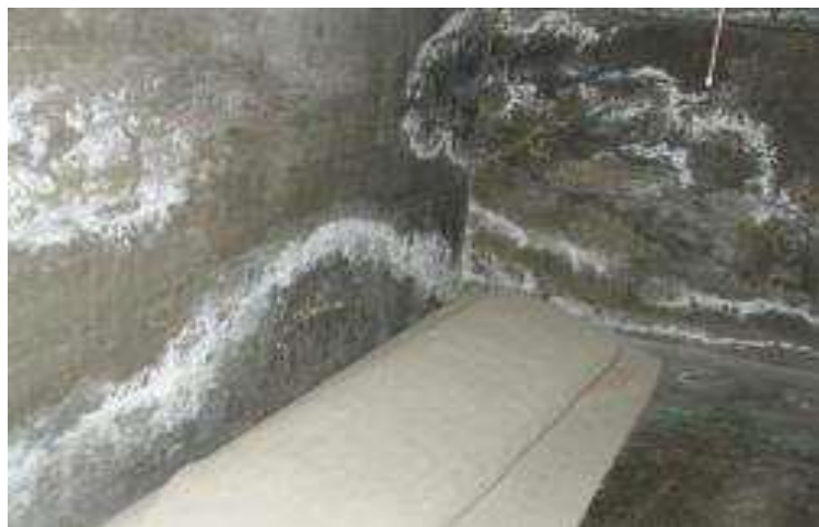
Figura 09: imagen de eflorescencia en paredes.
