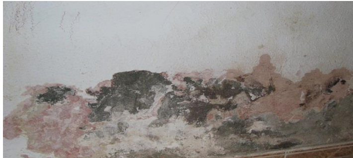
Figura 12: imagen de humedad en paredes.
