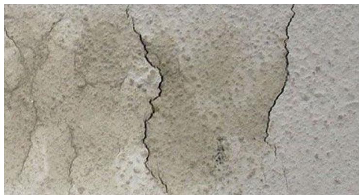
Figura 11: imagen de fisura en paredes.
