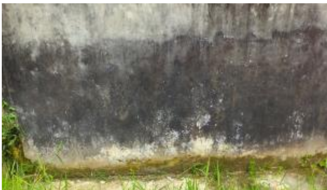
Fotografía 04: Eflorescencia y erosión en muros.
