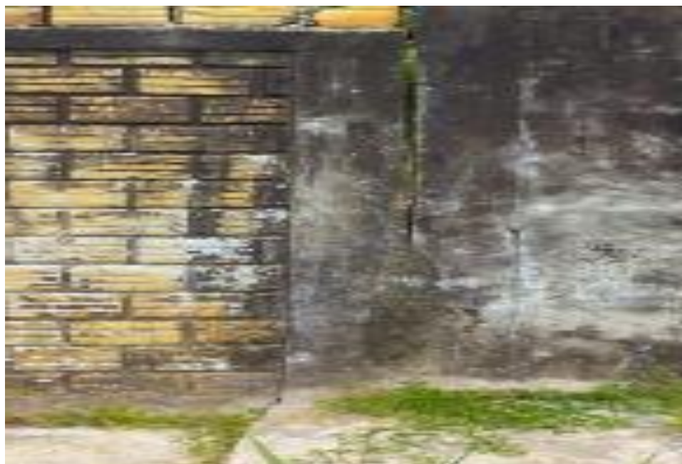
Fotografía 02: erosión en columna
