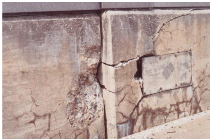
Figura 14: distorsión en paredes.
