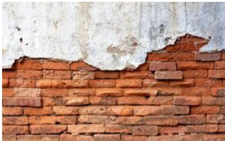
Figura 08: imagen de erosión en muro.
