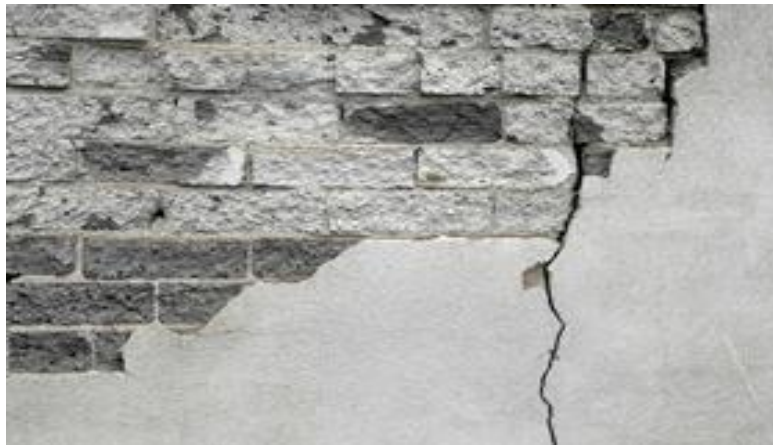
Figura 10: imagen de grieta en muro.
