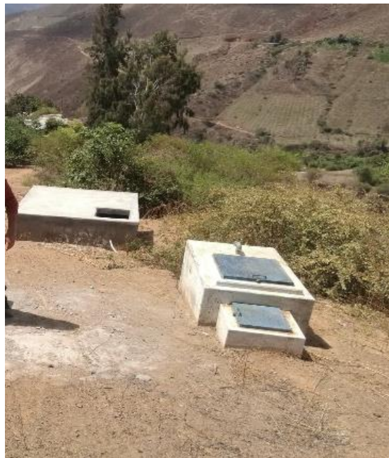
Fotografía 02: Cámara rompe presión tipo 6
