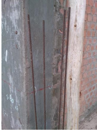
Imagen 20: Varillas de acero afectadas de por corrosión
