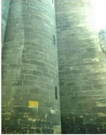
Imagen 16: Estructura afectada por suciedad.
