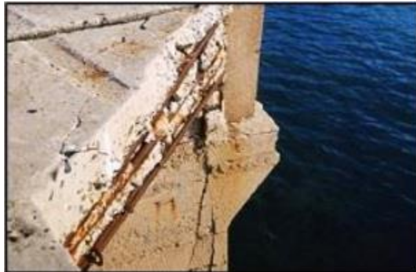
Imagen 2: Estructura afectada por erosión, desintegración y corrosión.
