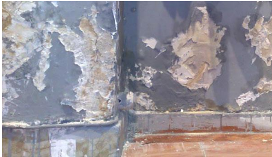
Imagen 12: Patologías en pared(humedad, erosión, etc)
