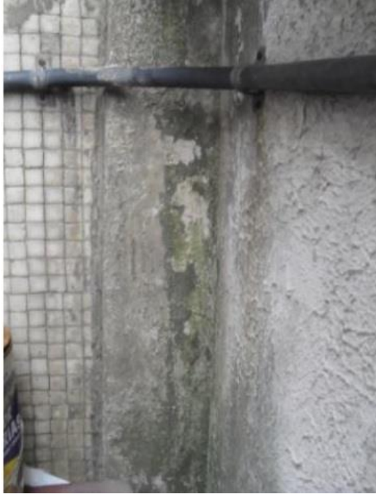
Imagen 1: Humedad y erosión en pared.
