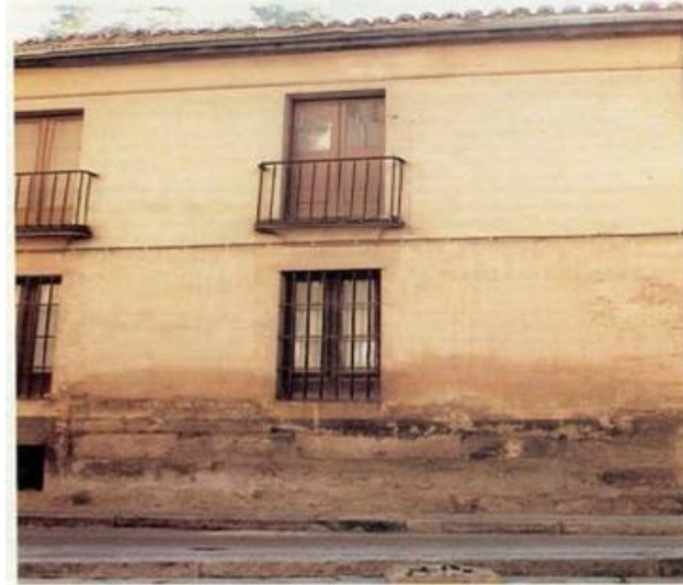
Imagen 14: Edificación afectada notablemente por humedad
