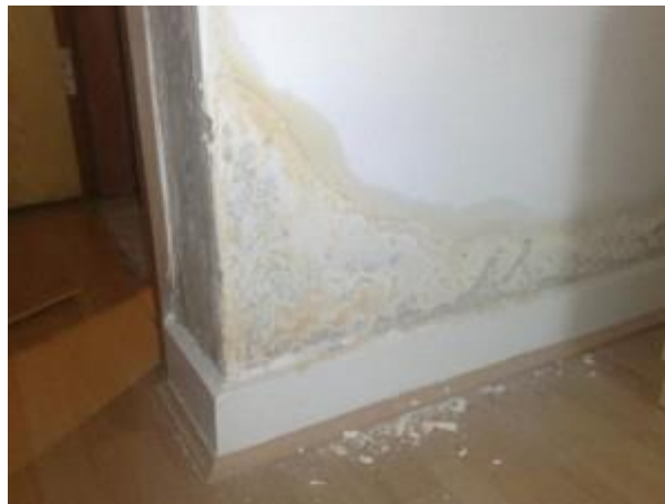
Imagen 4: Interior de vivienda afectada por humedad y eflorescencia.
