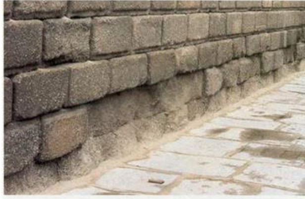
Imagen 18: Muro erosionado en su parte inferior.
