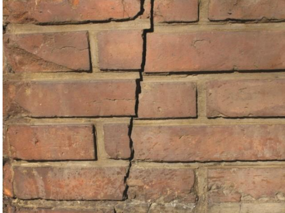
Imagen 17: Muro agrietado verticalmente
