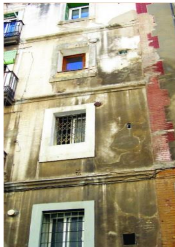
Imagen 11: Edificación afectada mayormente por humedad
