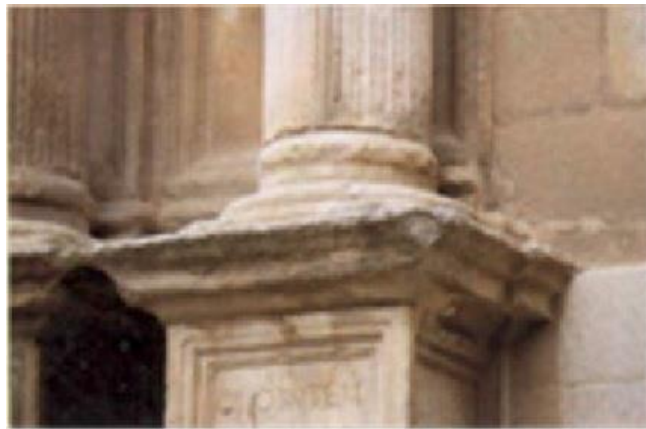
Imagen 15: Elemento afectado por erosión.
