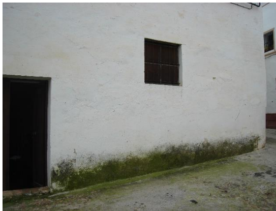
Imagen 13: El muro muestra humedad.
