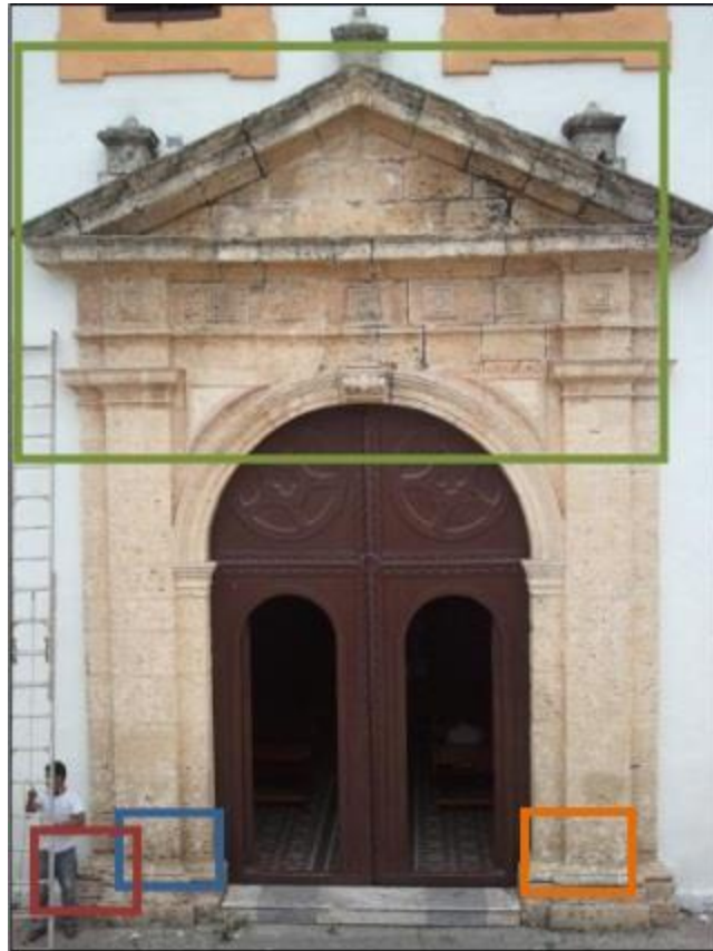
Imagen 3: En la entrada de la iglesia se aprecia humedad, erosión y desintegración.
