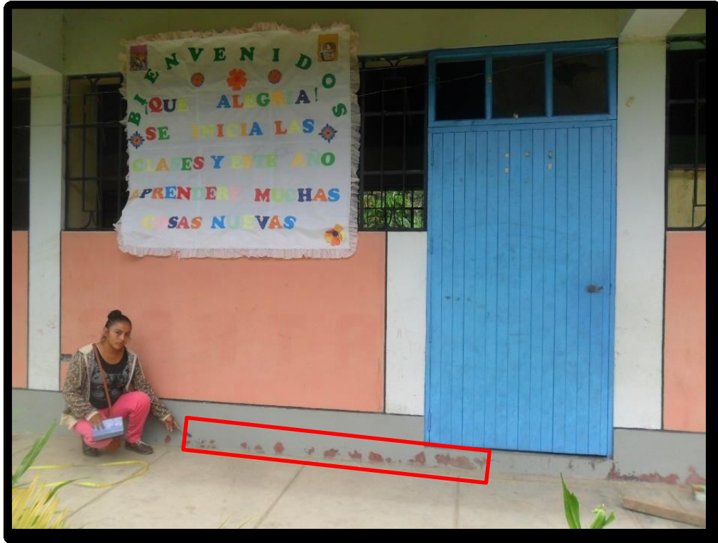
Figura 47. Se puede apreciar que en el eje A – entre eje 2 y 3 existen humedad
