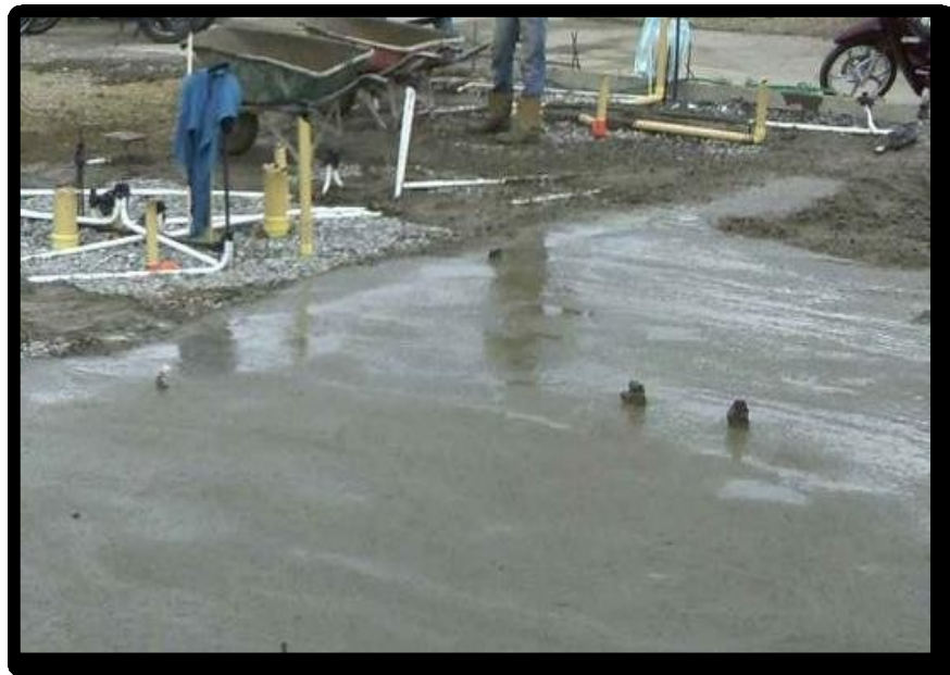
Figura 9. Exudación del concreto.
