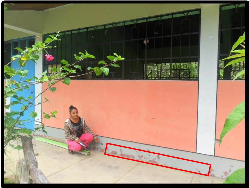
Figura 48. Se puede apreciar que en el eje A – entre eje 3 y 4 existen humedad
