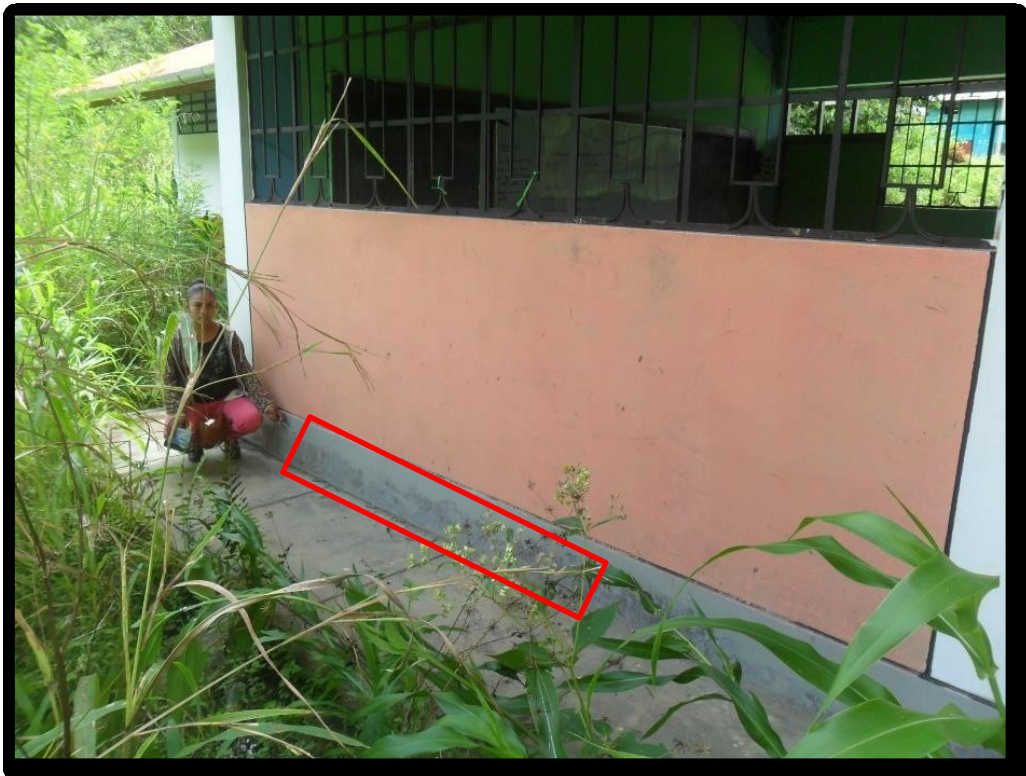
Figura 54. Se puede apreciar que en el eje B – entre eje 4 y 5 existen humedad
