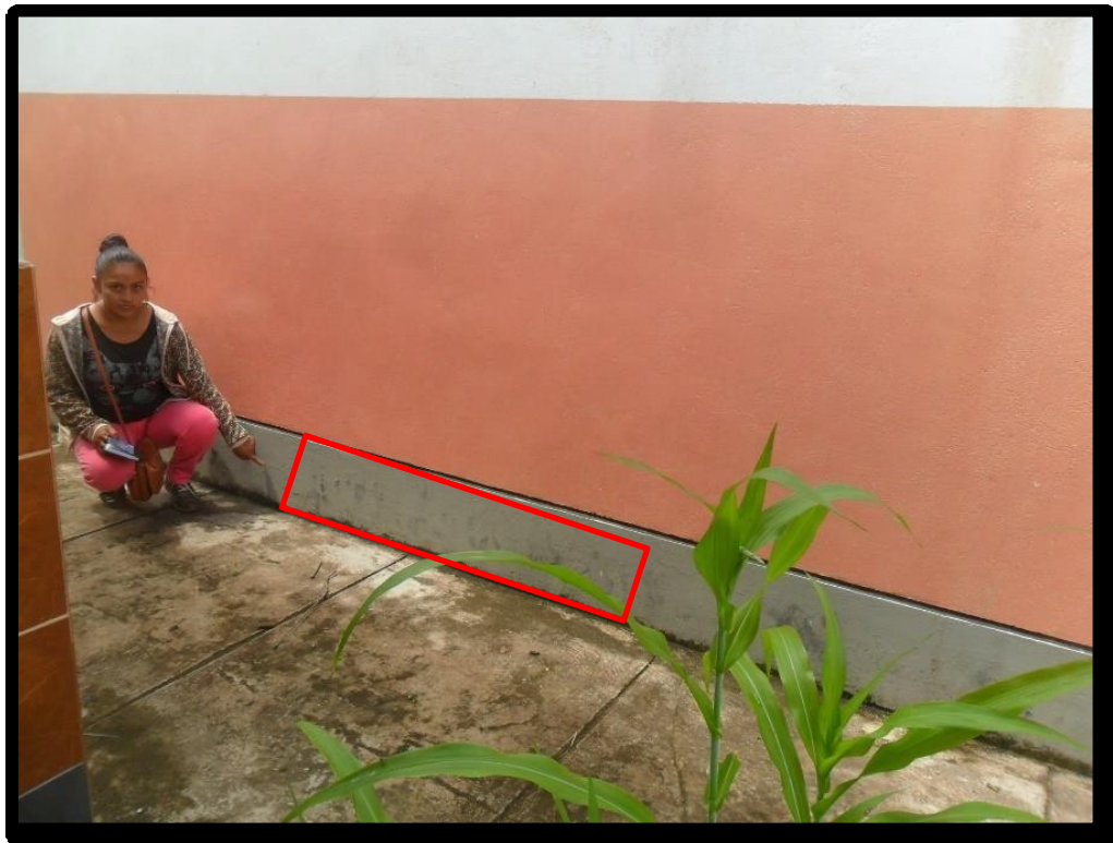
Figura 50. Se puede apreciar que en el eje 5 – entre eje Ay B existen humedad
