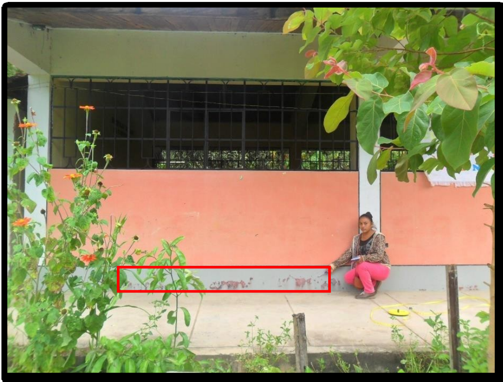
Figura 46. Se puede apreciar que en el eje a – entre eje 1 y 2 existen humedad.
