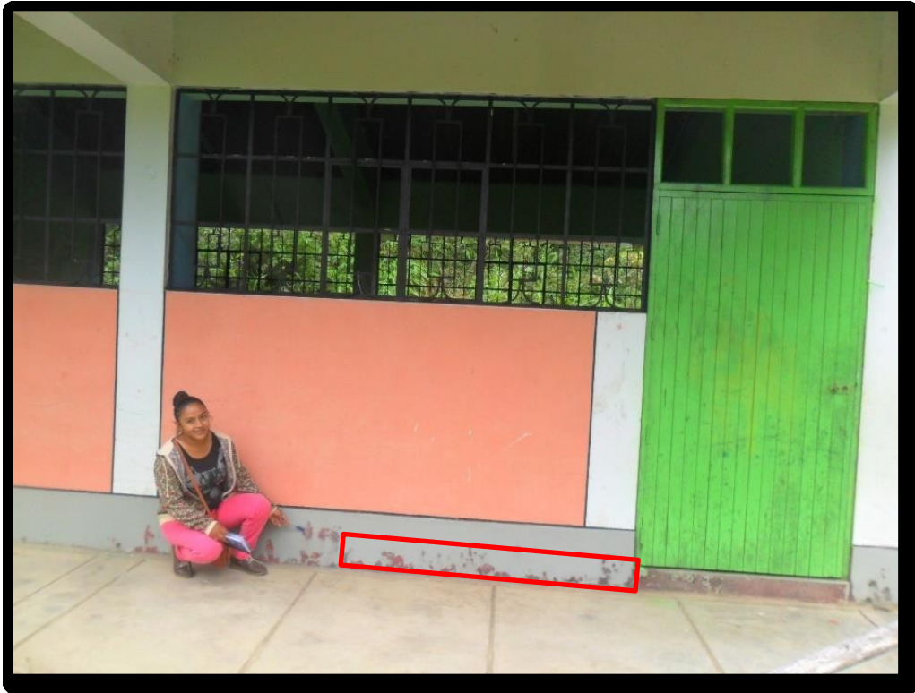
Figura 49. Se puede apreciar que en el eje A – entre eje 4 y 5 existen humedad.
