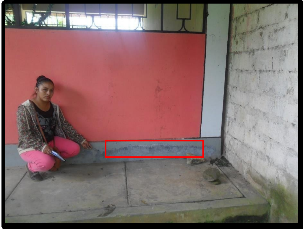
Figura 51. Se puede apreciar que en el eje B – entre eje 1 y 2 existen humedad
