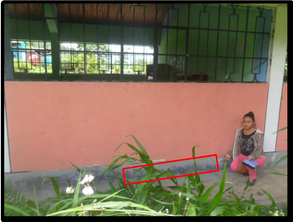
Figura 53. Se puede apreciar que en el eje B – entre eje 3 y 4 existen humedad
