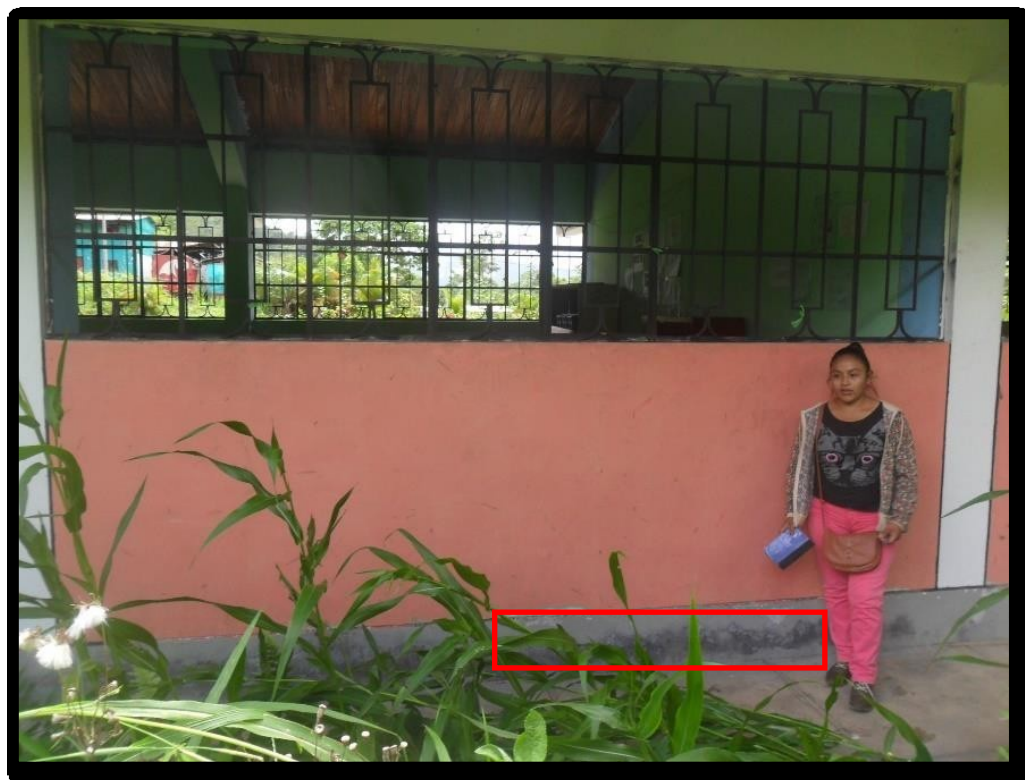
Figura 52. Se puede apreciar que en el eje B – entre eje 2 y 3 existen humedad.
